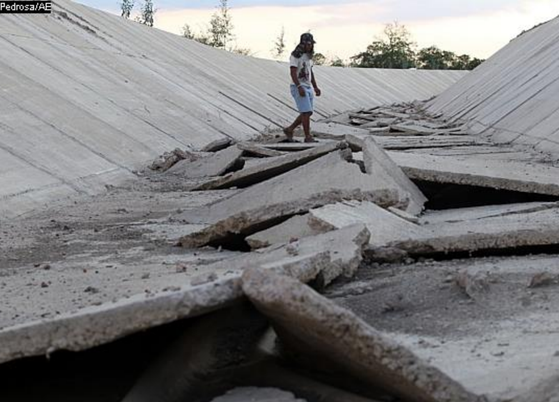
Canal da transposição do São Francisco em que as placas de concreto começam a se desprende
