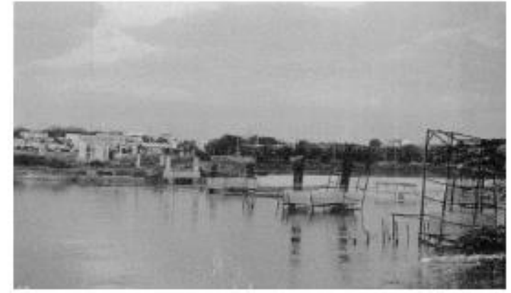
A "Ponte da Amizade" foi iniciada em janeiro de 1988 e paralisada em dezembro de 1991, tendo sido concluída a infraestrutura e parte da mesoestrutura, correspondente a cerca de 58%, com um gasto de cerca de R$ 13.000.000,00. Foi estimado em R$10.000.000,00 o orçamento para sua conclusão.
