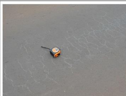
Foto 02 – fissuras a partir da estaca 130.
