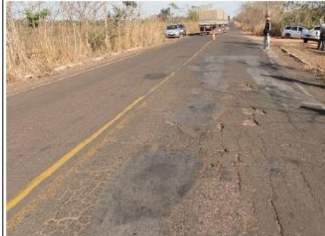
Foto 02 – tapa buraco fora de especificação
