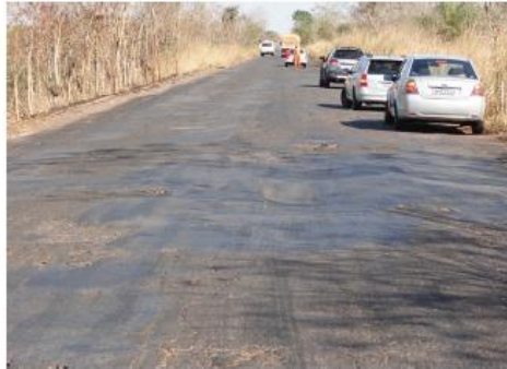
Foto 01 – pista com ondulações
