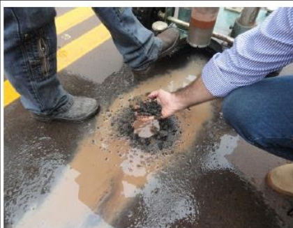
Foto 04 – Amostra de CBUQ (desintegrada) retirada no trecho fissurado
