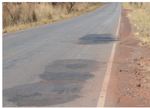
Foto 02 – tapa-buraco for a da especificação
