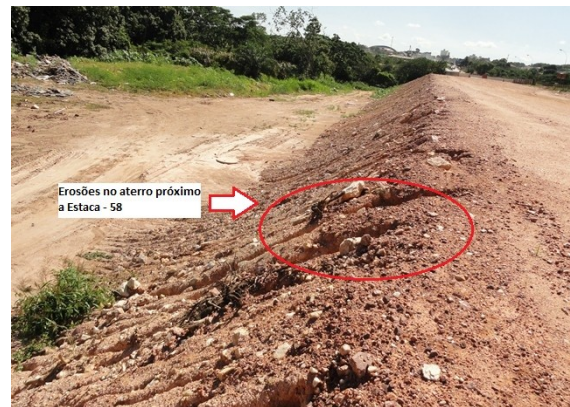
Foto 04 – erosões no talude com a paralisação da obra
