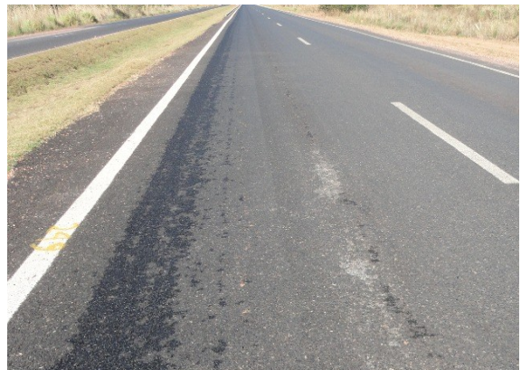
Foto 02 – trecho com desgaste acentuado E - 249
