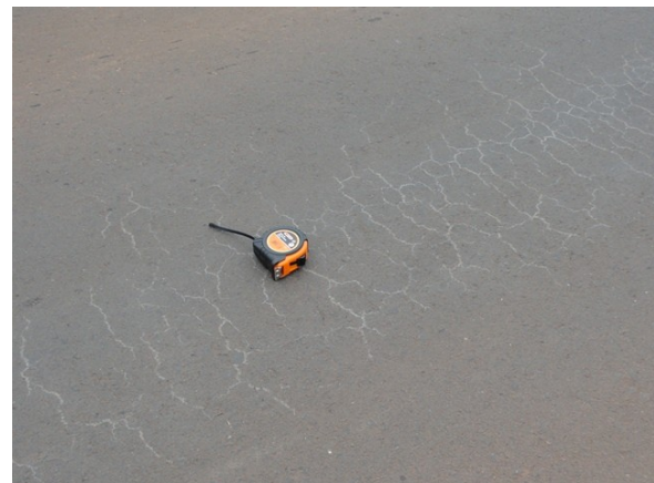
Foto 02 – fissuras a partir da estaca 130.
