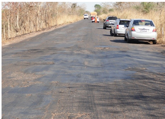
Foto 01 – pista com ondulações
