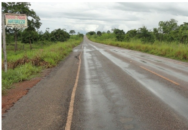
Foto 01 – trecho inicial com ondulações no pavimento
