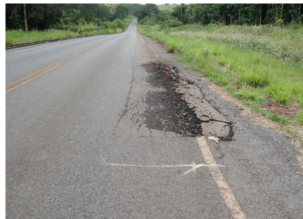
Foto 03 – afundamento crítico no bordo da pista
