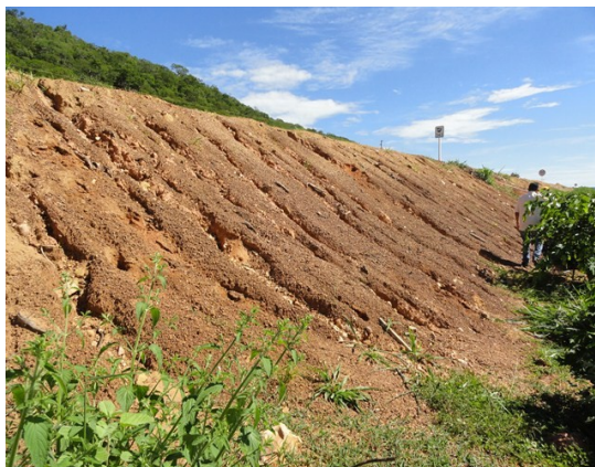
Foto 02 – erosões no talude de aterro
