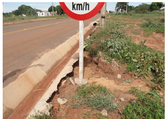
Foto 04 - erosão no escoramento da sarjeta
