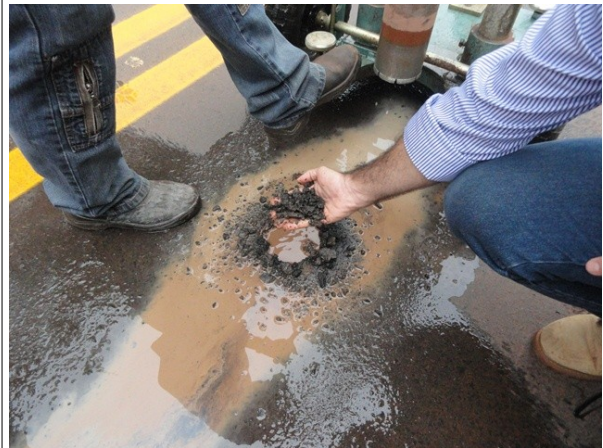
Foto 04 – Amostra de CBUQ (desintegrada) retirada no trecho fissurado
