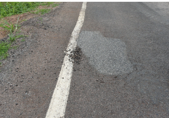
Foto 03 – correção em desacordo com a Norma
