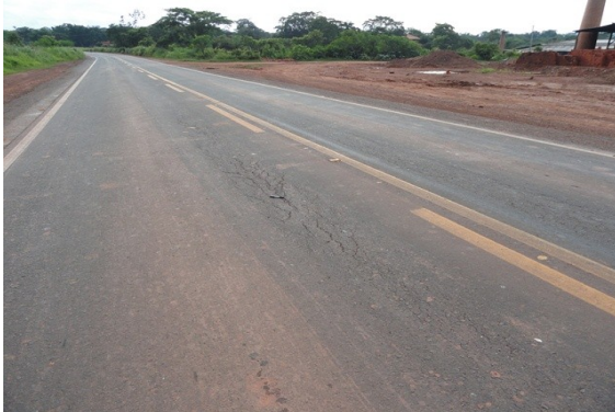
Foto 01 – fissuras no CBUQ próximo às olarias
