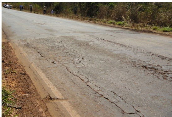
Foto 01 – trecho apresentando trincas
