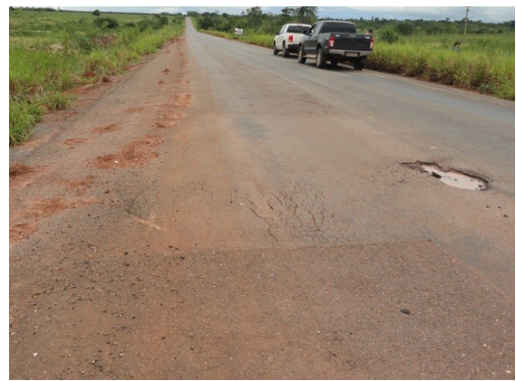
Foto 02 – remendo com fissuras na interface e panela
