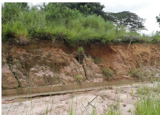
Foto 05 – erosão nos taludes de corte
