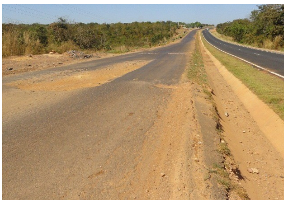
Foto 03 – trecho com bordo com severos afundamentos
