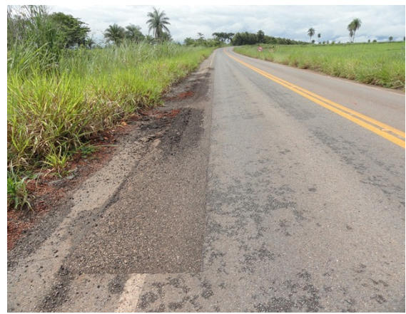
Foto 04 – remendo com afundamento e panelas
