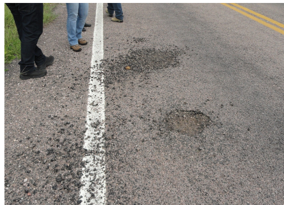
Foto 02 – detalhe do pavimento deteriorado
