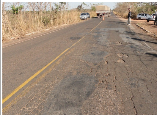
Foto 02 – tapa buraco fora de especificação
