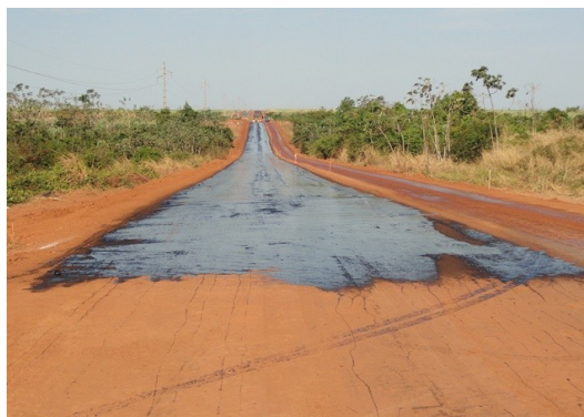
Foto 04 – imprimação do trecho em TST que apresenta patologias
