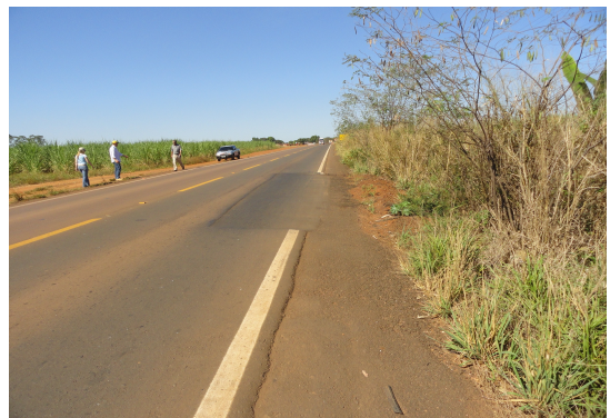
Foto 04 – Remendo com afundamento
