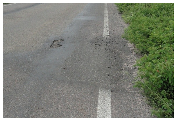
Foto 04 – correção em desacordo com a Norma
