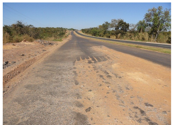
Foto 04 – trecho com pavimento deteriorado
