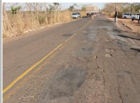
Foto 02 – tapa buraco fora de especificação
