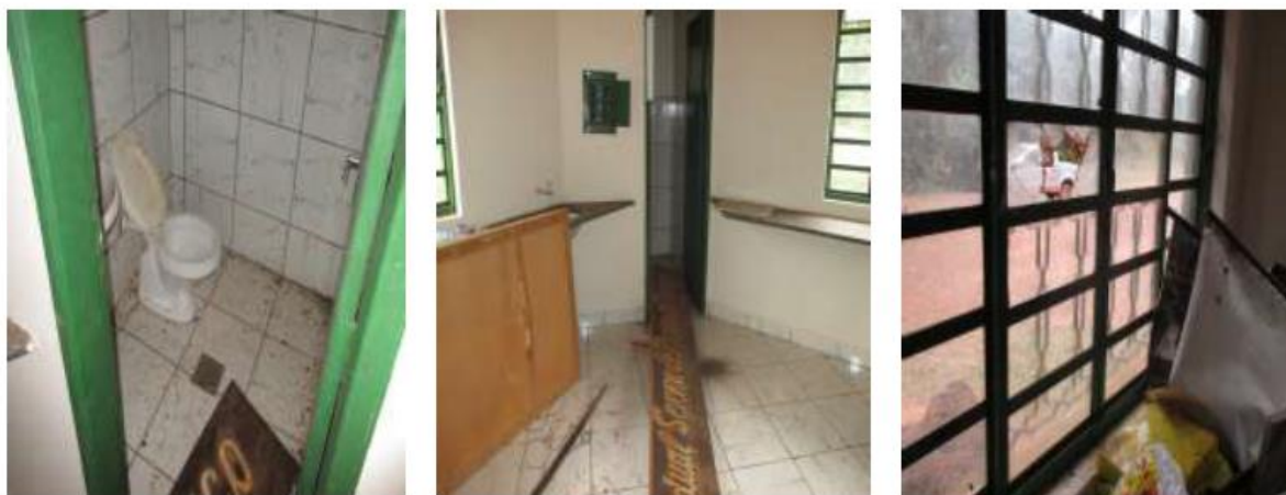
Foto 1 – Condições da estrutura física da sede administrativa do Parque Estadual Serra Ricardo Franco
