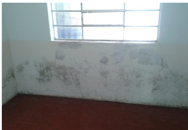
Figura 94 – Paredes internas com problema de infiltração - CAPSad
