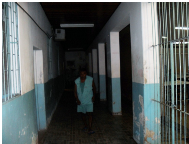
Figura 72 – Ala feminina em condições precárias de infraestrutura - CIAPS Adauto Botelho (Unidade Hospitalar)
