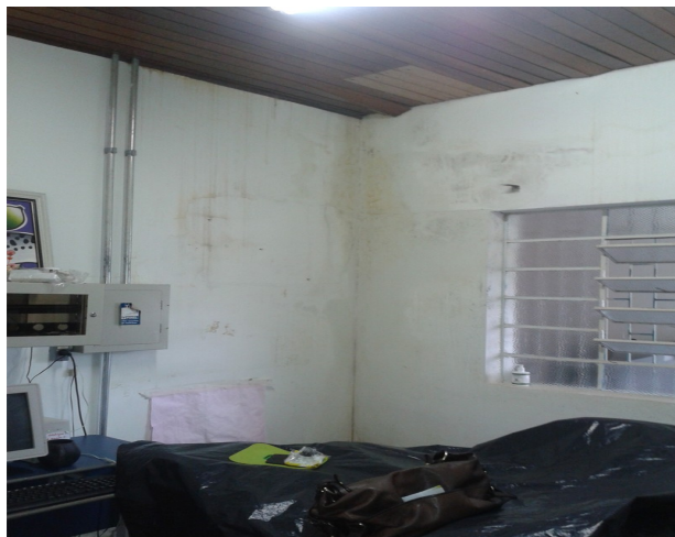
Figura 92 – Sala do setor administrativo interditada devido chuva - CAPSad
