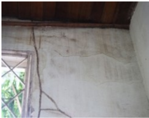
Figura 93 – Paredes interna com infiltrações - CAPSad
