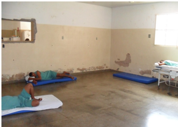
Figura 79 – Parte interna – Quartos / leitos inadequados - CIAPS Adauto Botelho (Unidade Hospitalar)
