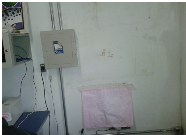
Figura 91 – Sala do setor administrativo interditada devido chuva - CAPSad
