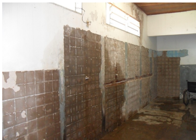
Figura 77 – Parte interna – banheiro - CIAPS Adauto Botelho (Unidade Hospitalar)
