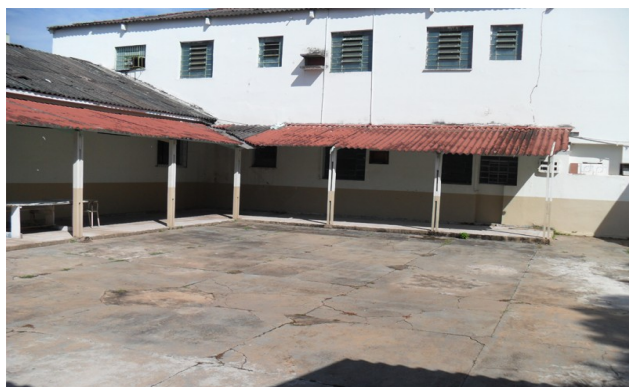
Figura 73 – Espaço interno, estado deteriorado e sem acomodações - - CIAPS Adauto Botelho (Unidade Hospitalar)
