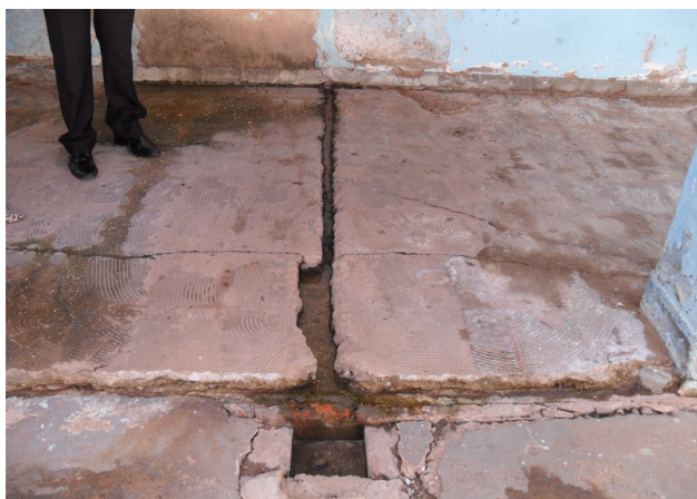
Figura 75 – Parte interna – saídas de água abertas - - CIAPS Adauto Botelho (Unidade Hospitalar)
