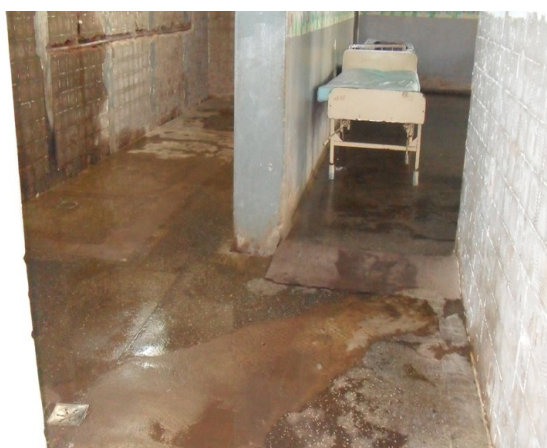
Figura 76 – Parte interna – banheiro - CIAPS Adauto Botelho (Unidade Hospitalar)
