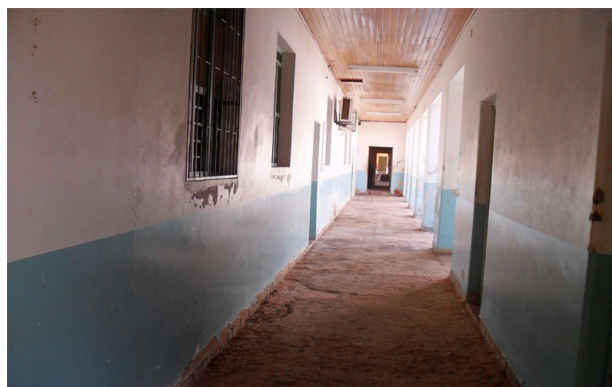
Figura 74 – Corredor interno – sem iluminação adequada, piso em condições péssimas - - CIAPS Adauto Botelho (Unidade Hospitalar)
