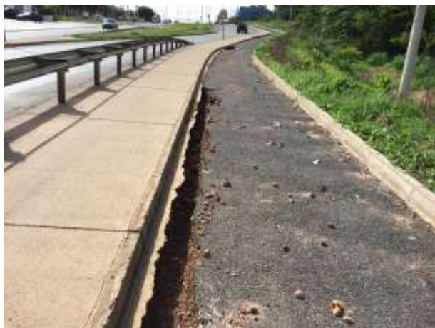
Figura 1- Detalhe erosão e desmoronamento do bueiro.
