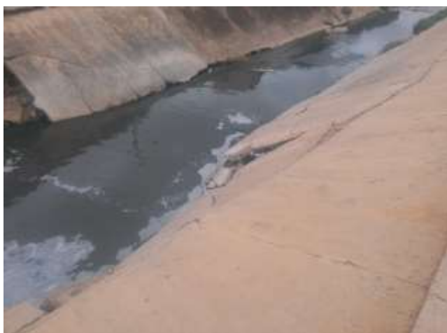
Fig. 05 – Deslizamento das placas de gabião.
