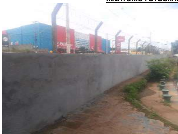
Fig. 01 – Muro limítrofe com o Aeroporto
