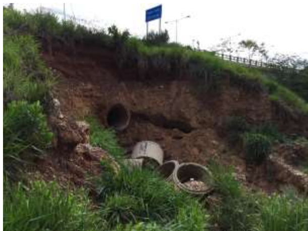
Figura 1- Detalhe erosão e desmoronamento do bueiro.
