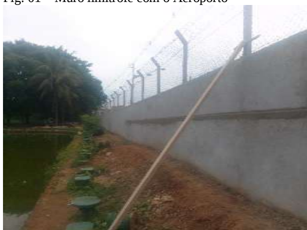
Fig. 03 – Muro limítrofe com o Aeroporto
