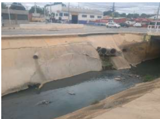
Fig. 03 – Deslizamento das placas de gabião.
