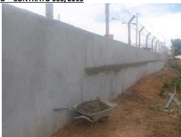
Fig. 02 – Muro limítrofe com o Aeroporto
