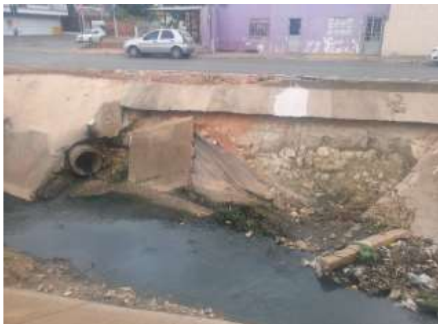
Fig. 01 – Deslizamento das placas de gabião.
