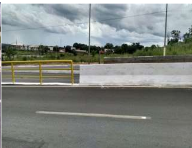
Figura 10 – Reparo de concretagem não realizado – Estaca 4;
