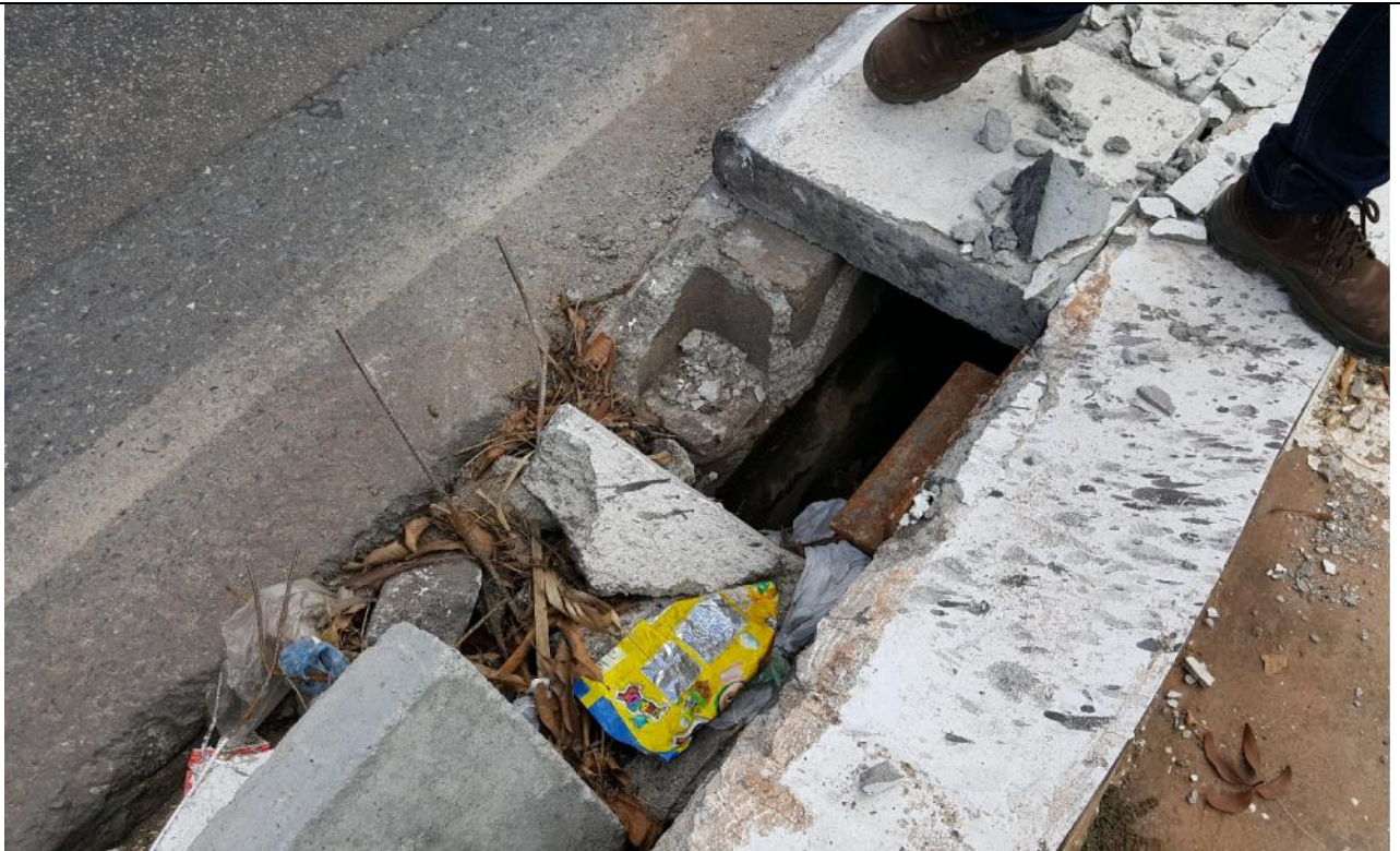
Fig. 04 – Tampas pré-moldadas danificadas.
