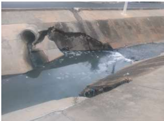
Fig. 07 – Deslizamento das placas de gabião.
