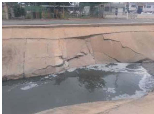
Fig. 04 – Deslizamento das placas de gabião.
