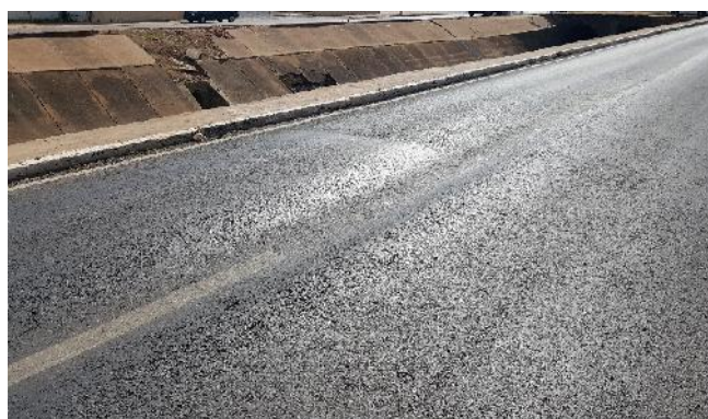
Estaca: 06 Não conformidade: Afundamento do tronco coletor
