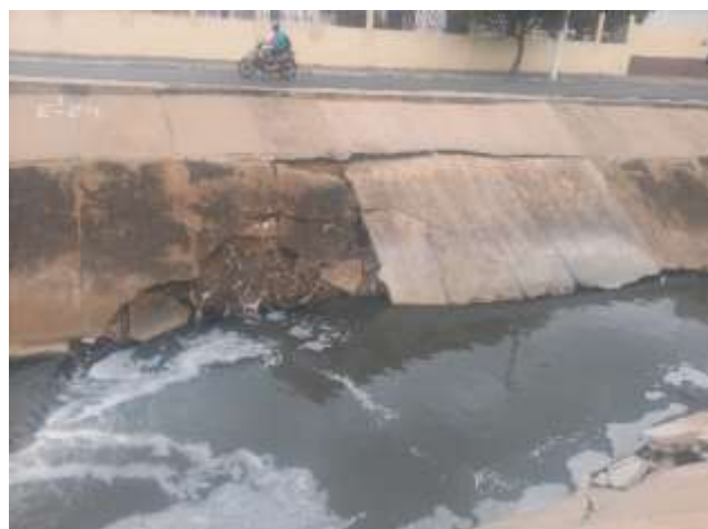
Fig. 06 – Deslizamento das placas de gabião.
