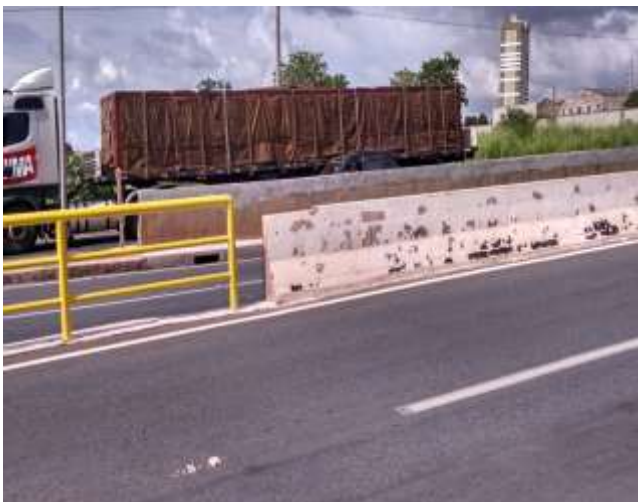
Figura 9 – Reparo de concretagem não realizado – Estaca 4;
