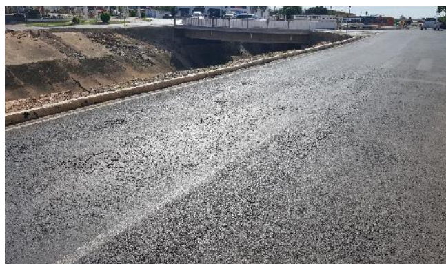
Estaca: 25 Não conformidade: Afundamento / Trincas
