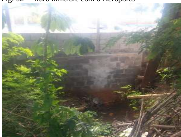
Fig. 04 – Muro limítrofe com o Aeroporto
