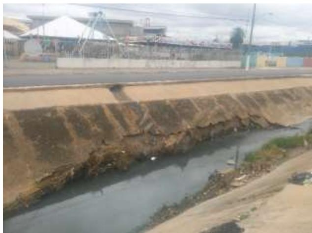
Fig. 08 – Deslizamento das placas de gabião.
