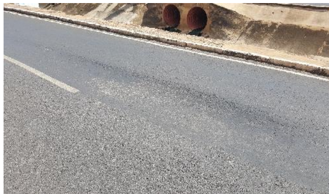
Estaca: 37 Não conformidade: Afundamento
