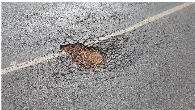
Estaca: 54 Não conformidade: Afundamento PV
