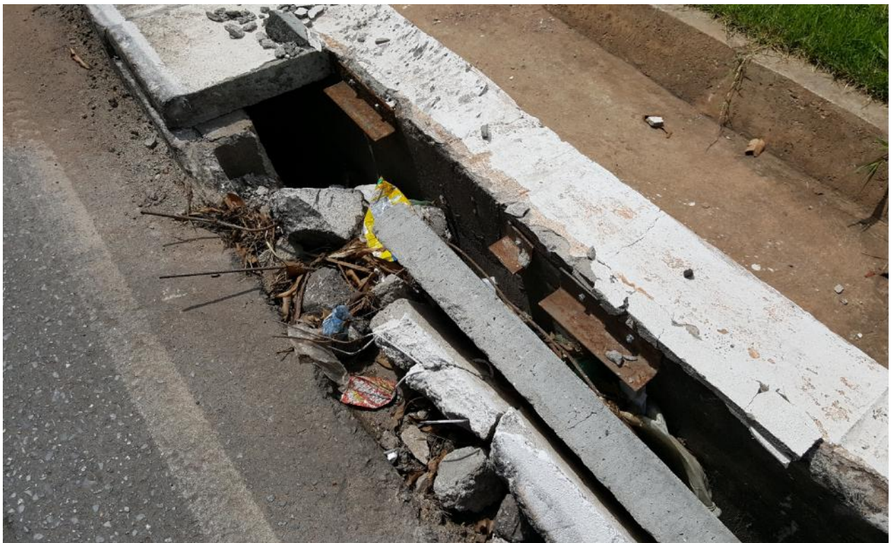
Fig. 05 – Tampas pré-moldadas danificadas.
