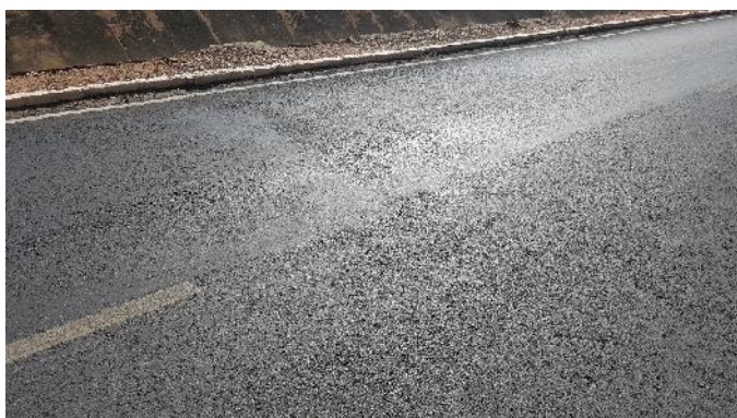
Estaca: 33 Não conformidade: Afundamento
