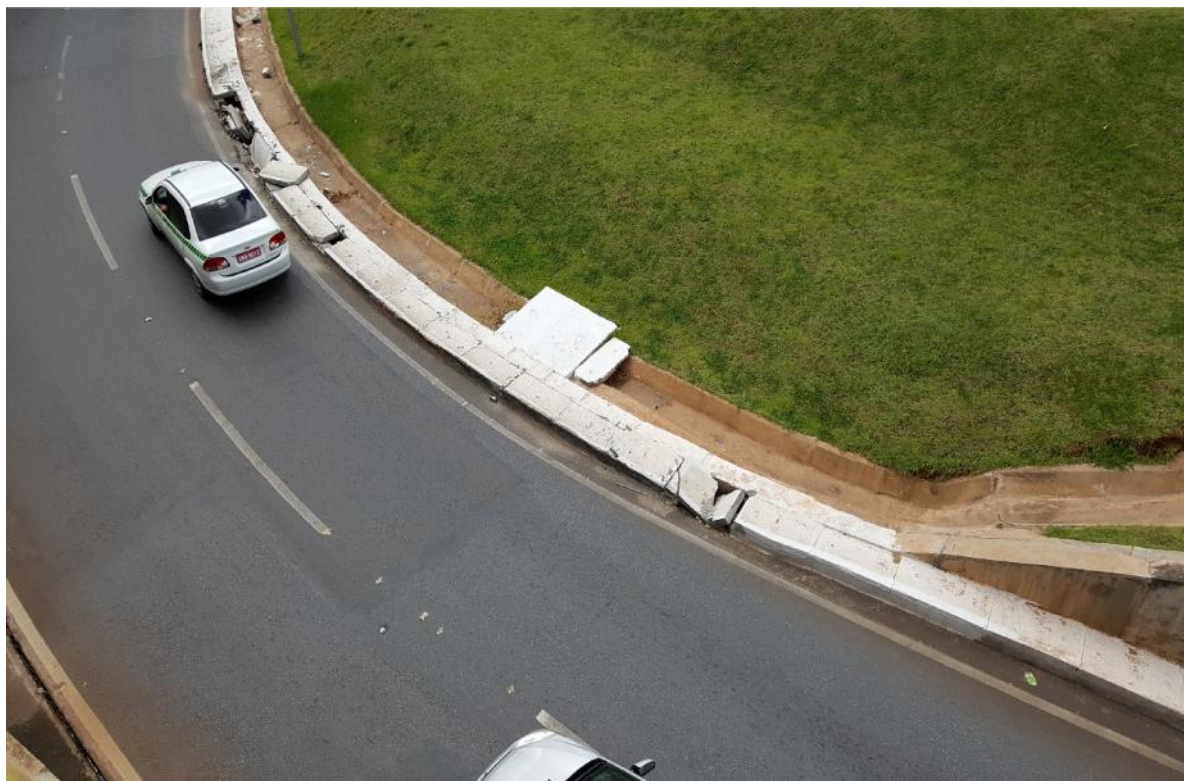
Fig. 02 – Tampas pré-moldadas danificadas.
