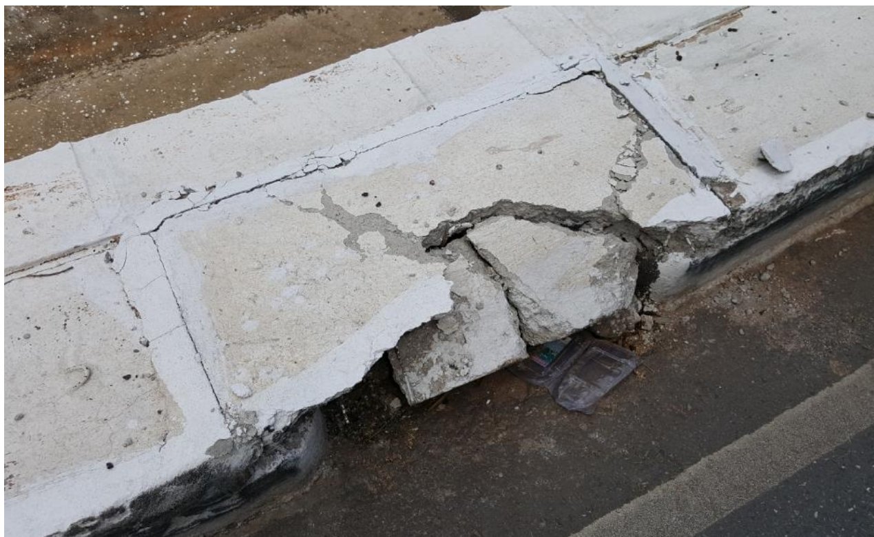
Fig. 03 – Tampas pré-moldadas danificadas.
