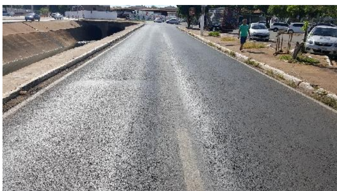
Estaca: 06 Não conformidade: Afundamento do tronco coletor
