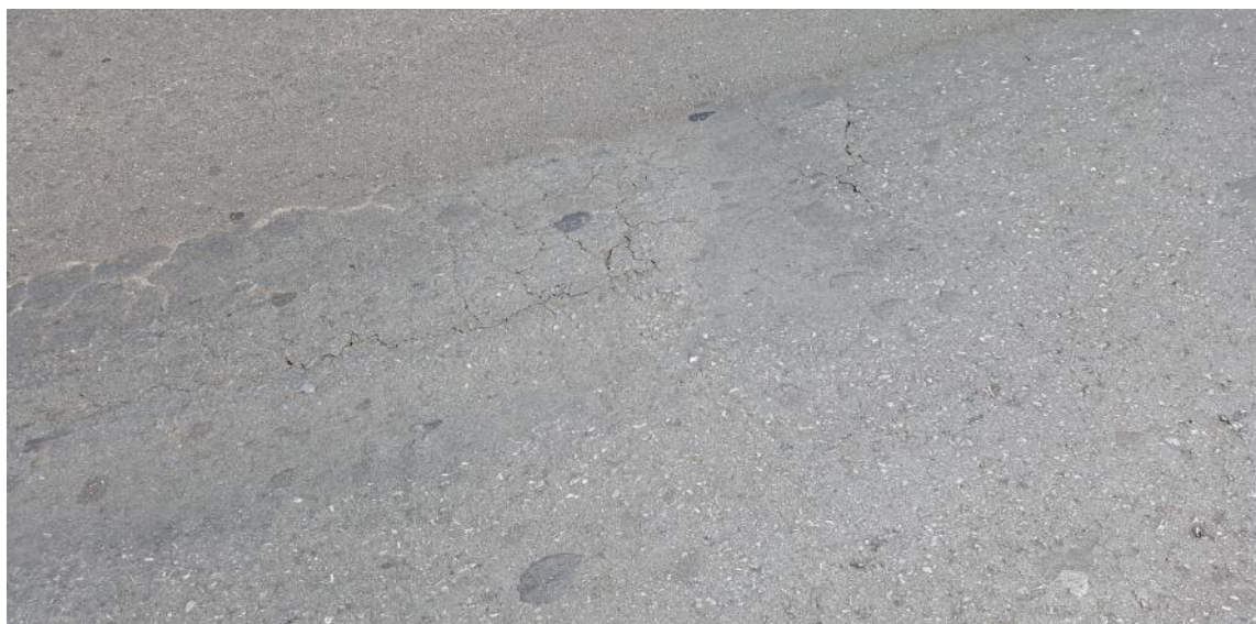
Fig. 01 – Trincas no pavimento próximo à estaca 6.
