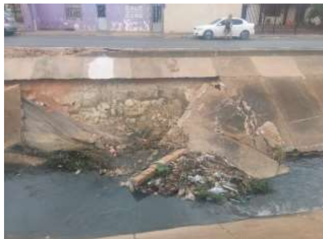
Fig. 02 – Deslizamento das placas de gabião.
