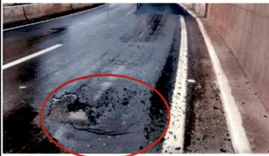
Afundamento do pavimento e buraco na pista
