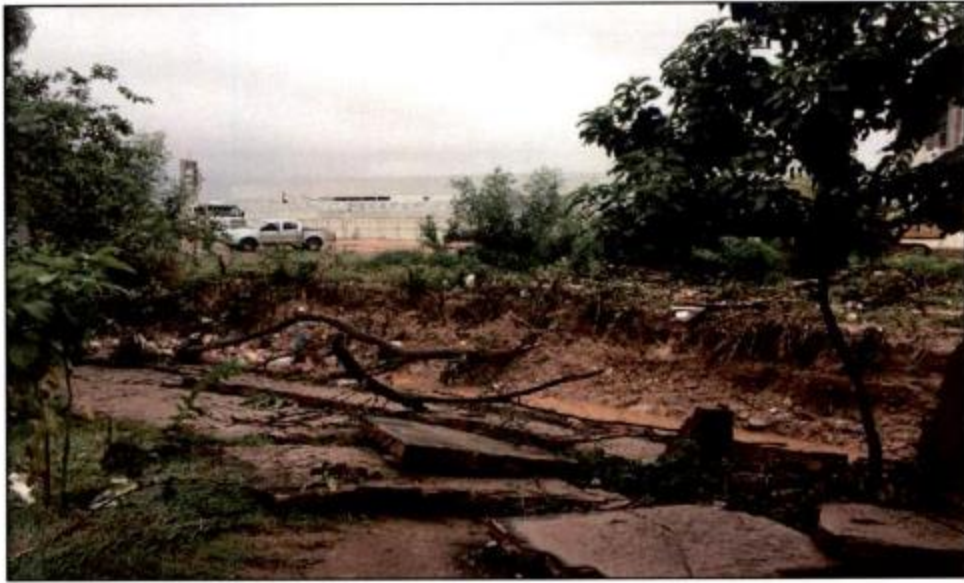
Figura 7- Detalhe da margem com processo erosivo.
