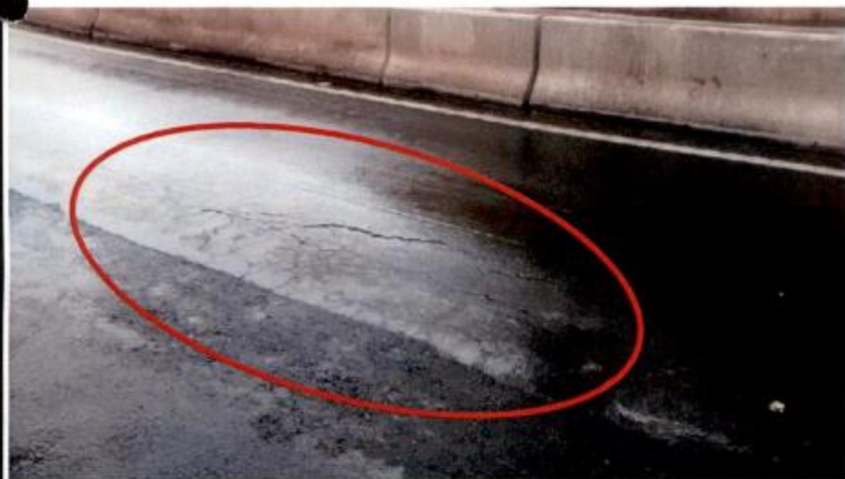
Trincas e afundamento de pavimento
