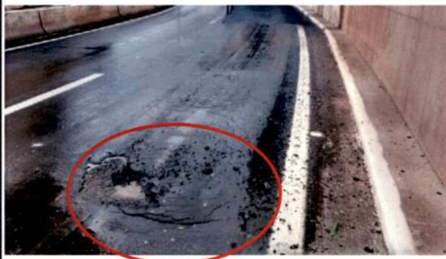
Afundamento do pavimento e buraco na pista
