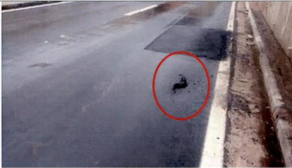
Deslizamento de massa asfáltica
