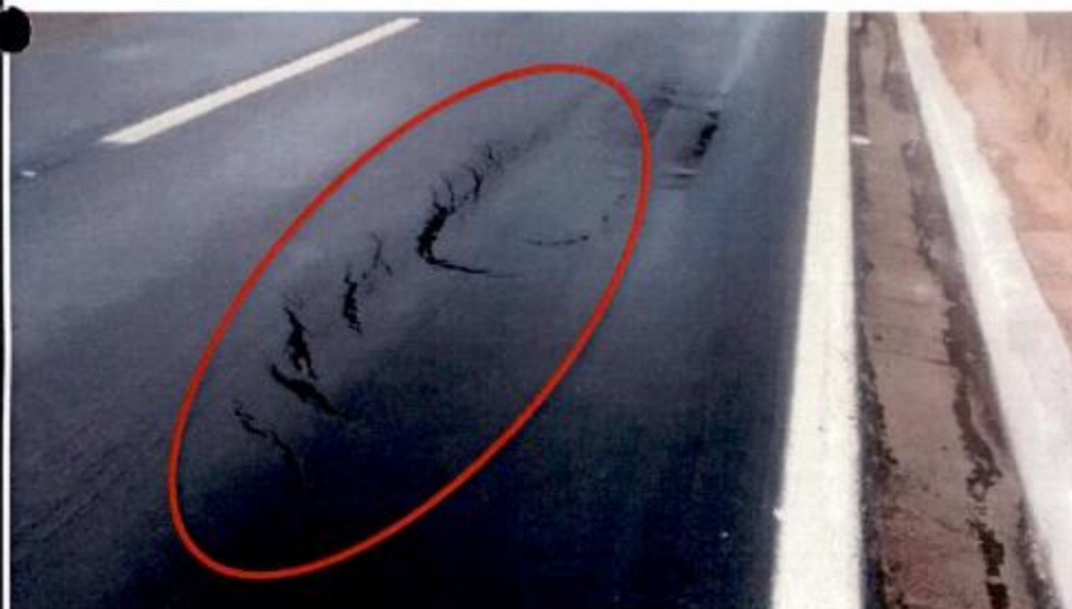
Deslizamento de massa asfáltica
