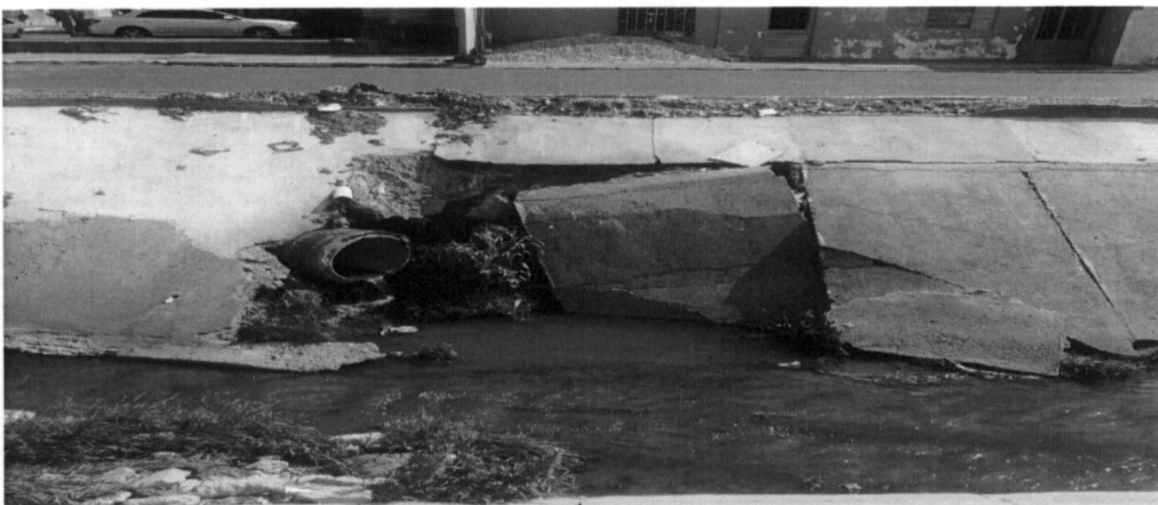
Figura 13: Serviço em desconformidade com o projeto.
