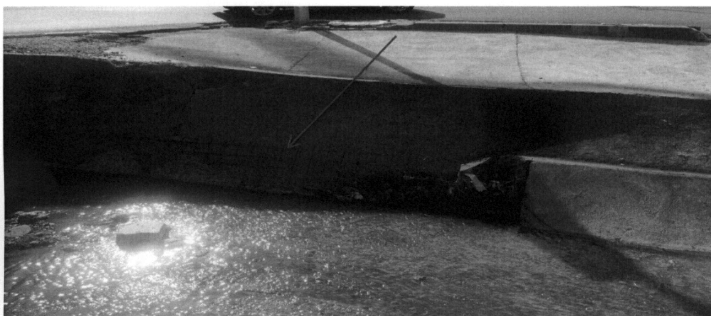
Figura 11: Conclusão da concretagem - armadura exposta.
