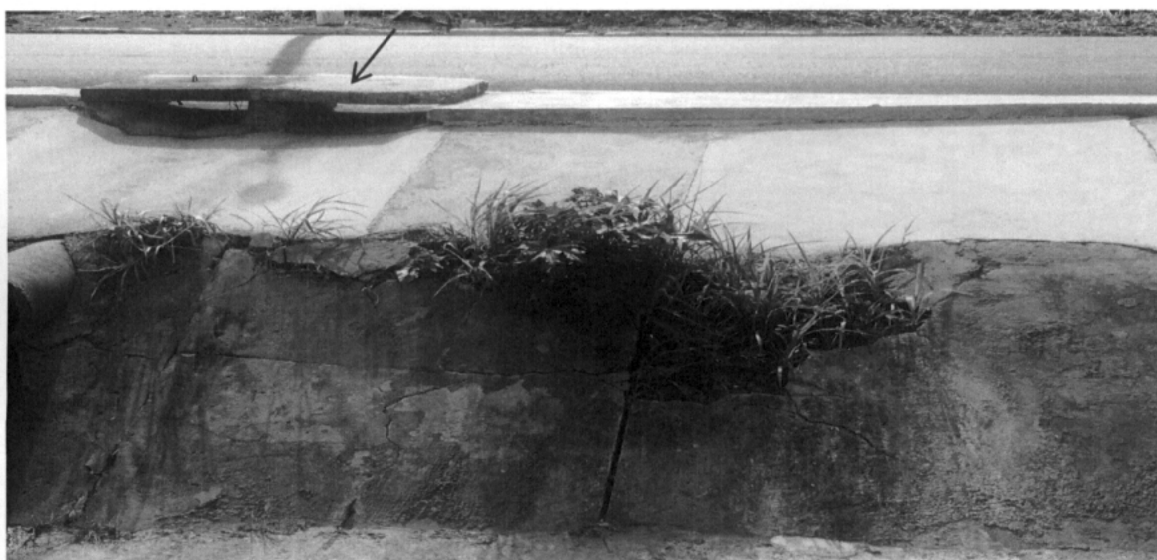
Figura 09: Tampa em desnível com o passeio.
