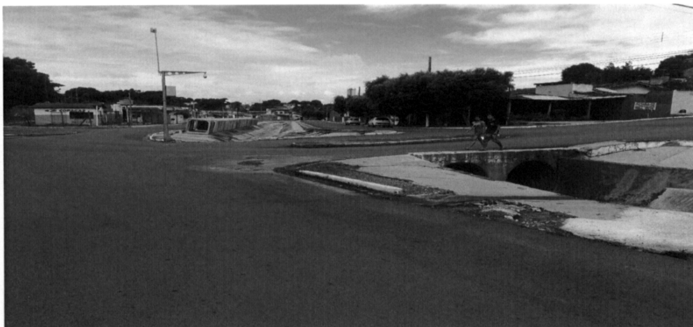
Figura 33: Não execução da rotatória Thogo da S. Pereira.
