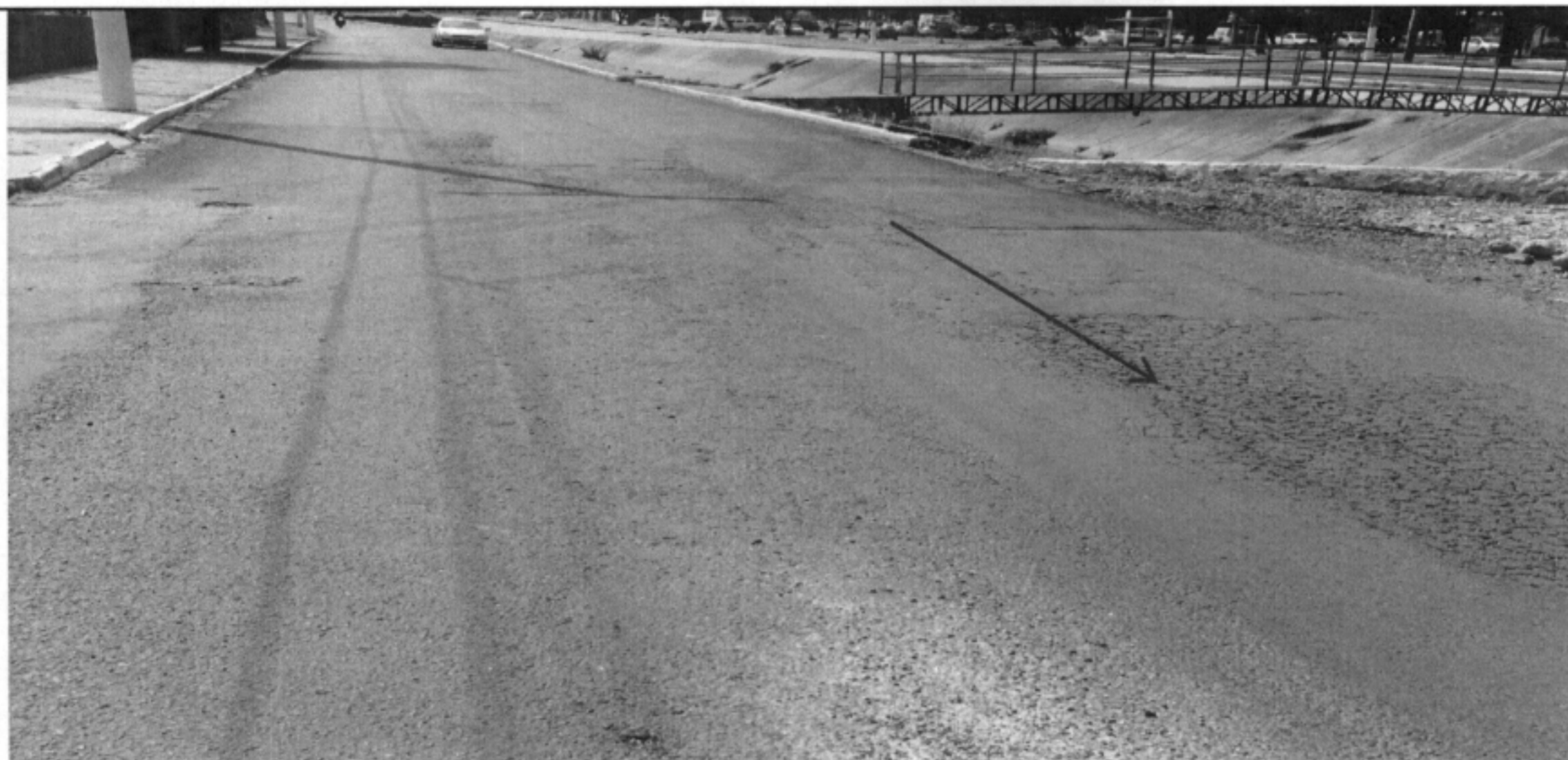
Figura 35: Pavimento em desconformidade – couro de jacaré.
