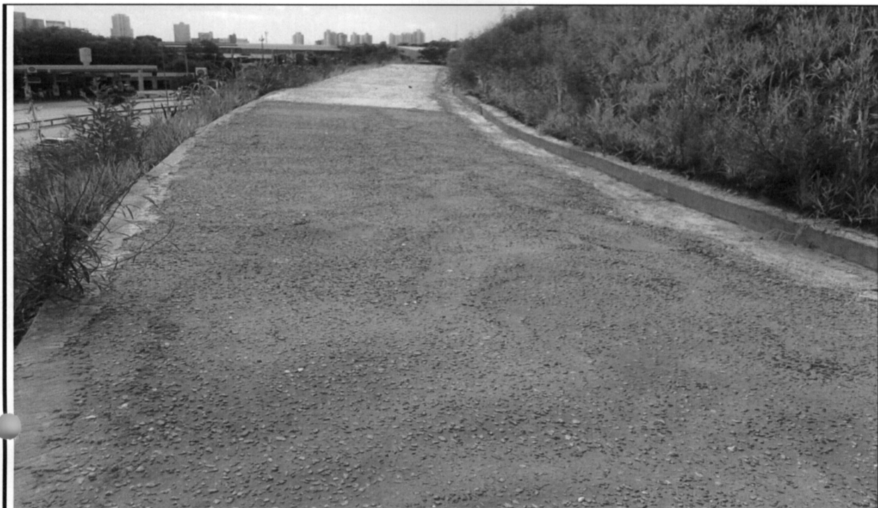
Foto 03 – Patamar central com concreto em desconformidade com a norma DNIT e projeto executivo.
