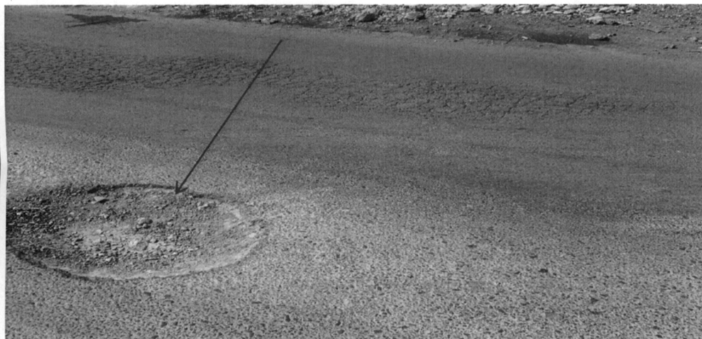
Figura 36: Pavimento em desconformidade – Panela.
