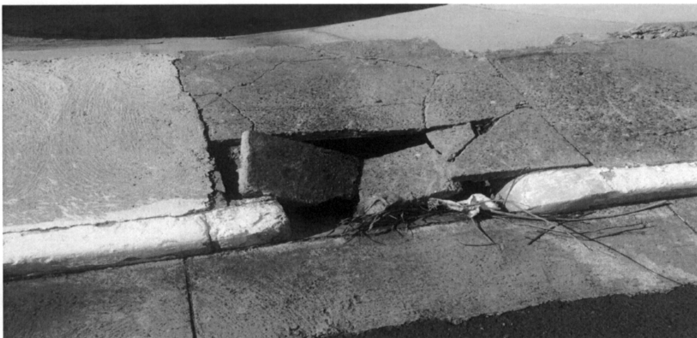
Figura 08: Tampa de passagem danificada.
