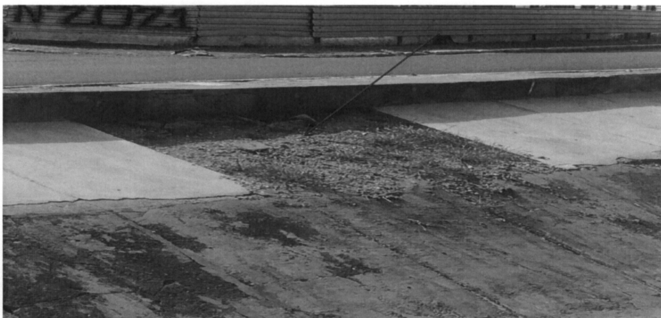
Figura 12: Serviço não executado – Concretagem.
