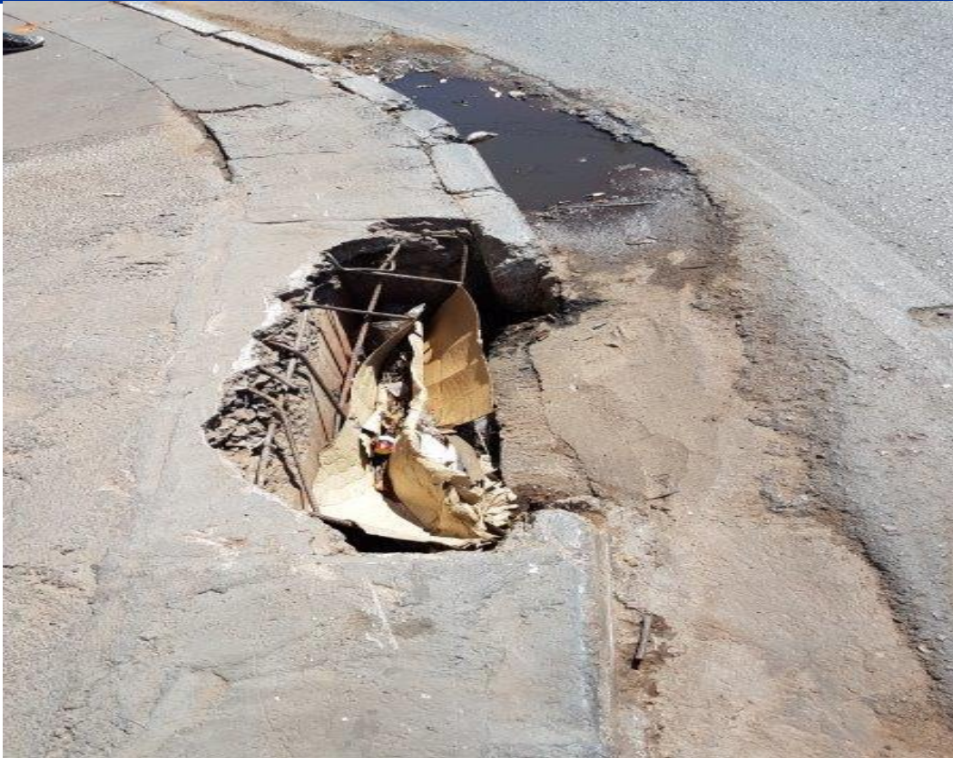
Boca de Lobo pista superior direita danificada
