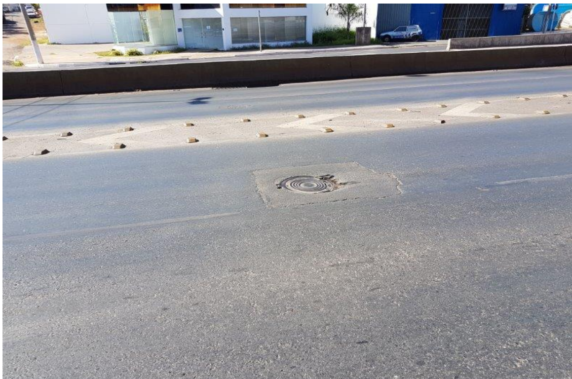
Tampa de PV com afundamento e fora da norma, apesar de já ter passado por resserviços
