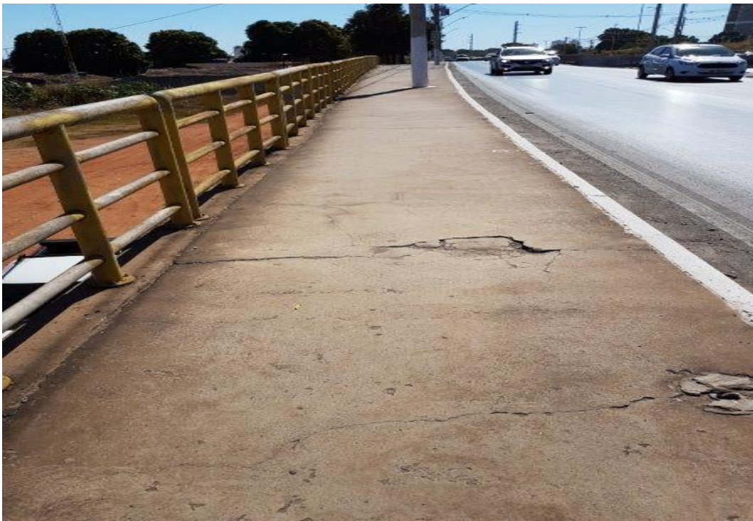
Calçada da pista superior direita danificada
