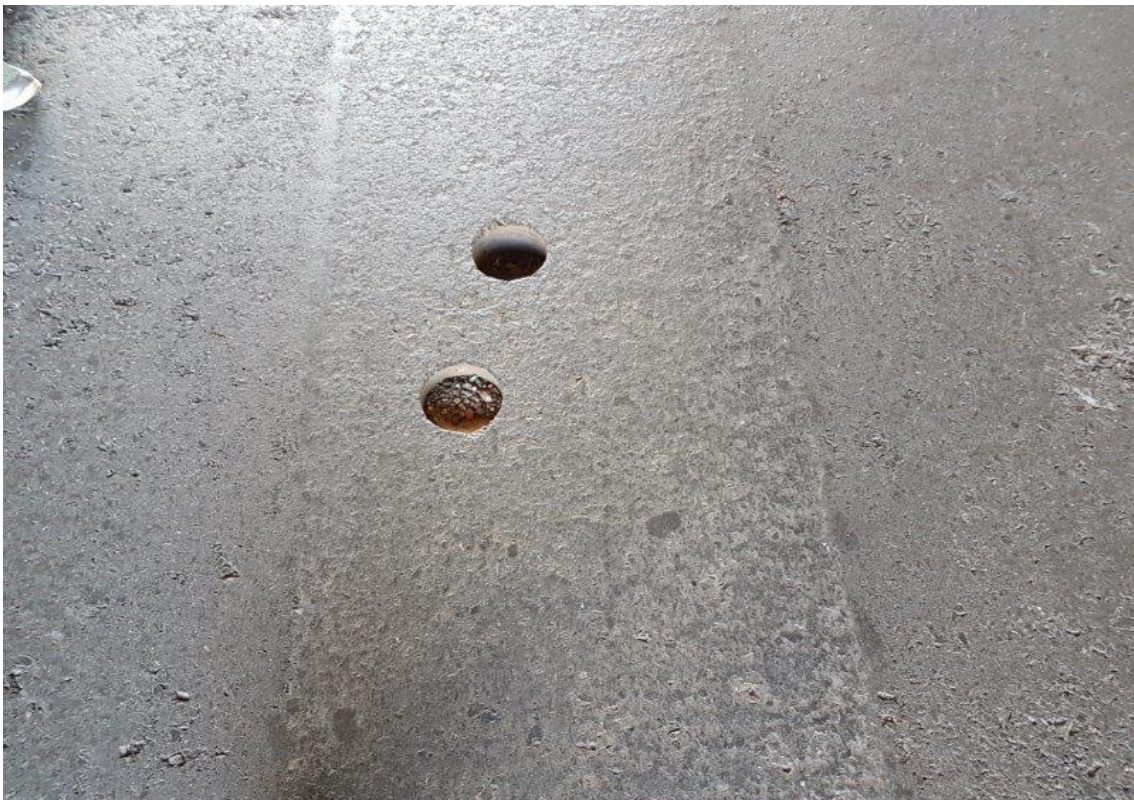
Corpo de prova retirado e não refeito
