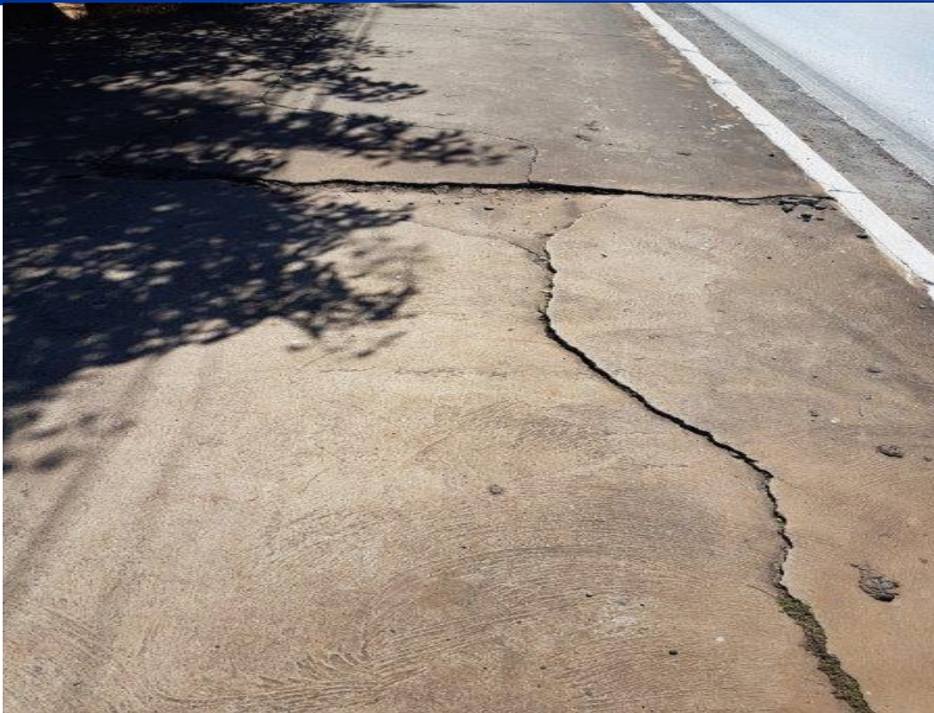
Calçada da pista superior direita danificada
