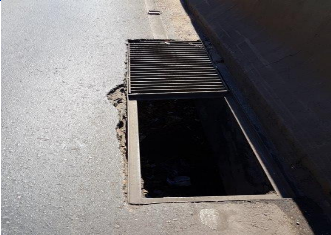
Ausência da grelha (pista da direita sentido Cba/Vg)
