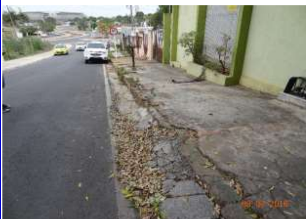
Fig. 31 - Meio fio e sarjeta danificados;
