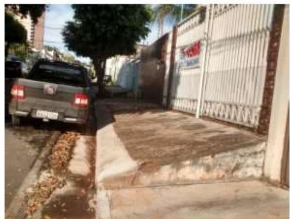
Fig. 32 - Rampa de acesso invadindo a sarjeta; (DEPOIS)
