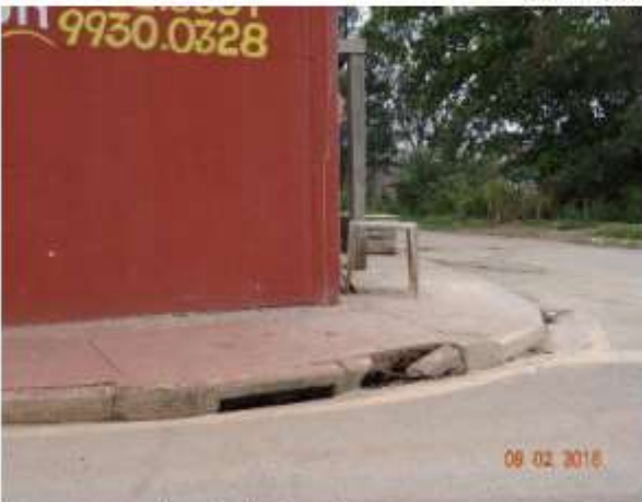
Fig. 19 - Guia chapéu danificada; (ANTES)
