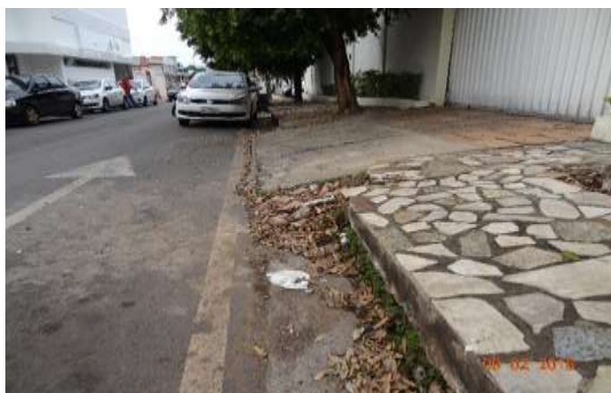
Fig. 3 - Meio fio não executado, rampa de acesso avançando sobre a sarjeta;
