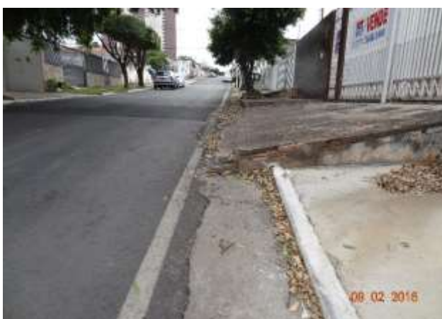
Fig. 32 - Rampa de acesso invadindo a sarjeta;
