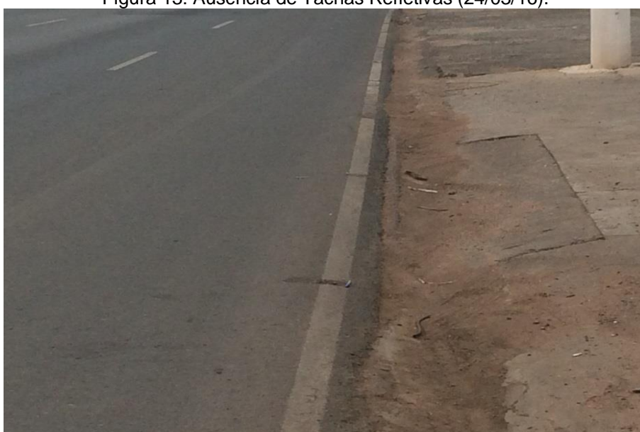
Figura 13: Ausência de Tachas Refletivas (24/03/16).
