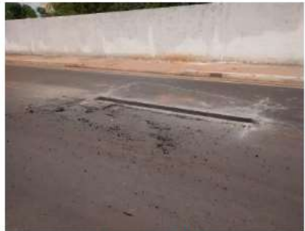
Fig. 17 - Trinca na capa asfáltica; (DEPOIS)
