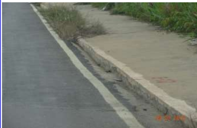
Fig. 25 - Sarjeta executada em desacordo com as especificações de projeto;
