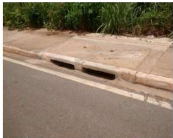
Fig. 26 - Boca de lobo obstruída; (DEPOIS)
