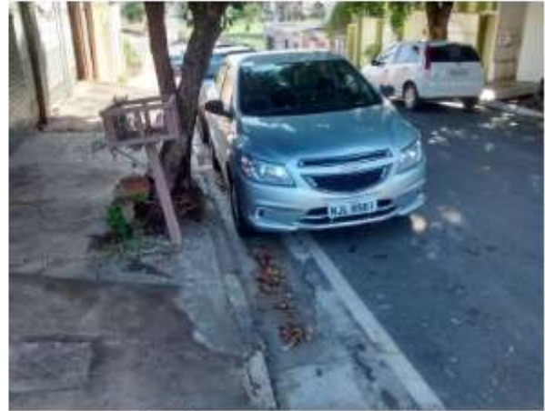
Fig. 30 - Meio fio não executado e sarjeta danificada; (DEPOIS)
