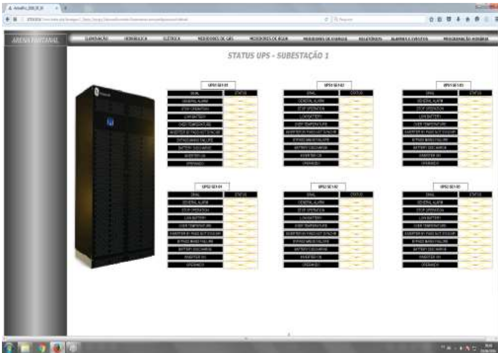
Figura 8.5.5. – Tela de status das UPS's da subestação 01
