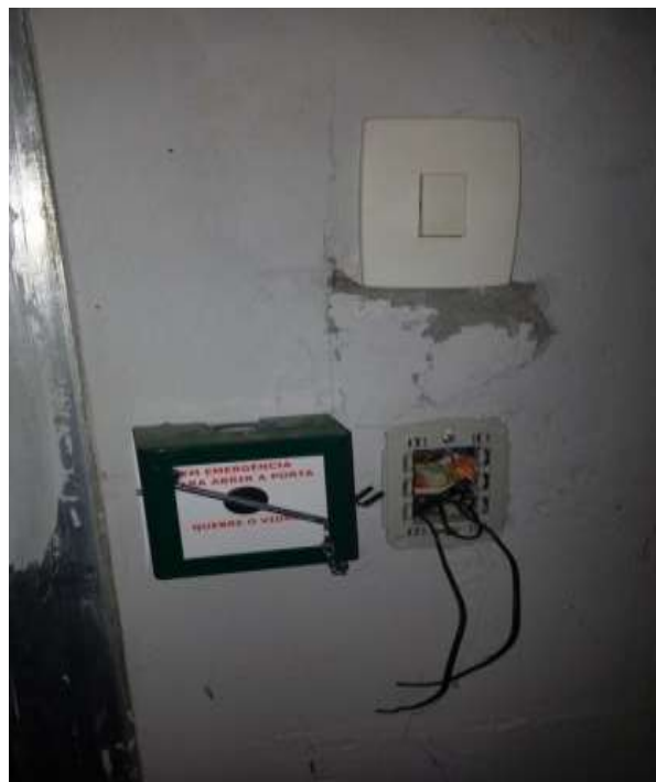
Registro 1. Dispositivo para saída de emergência com vidro quebrado e botão para destrave da
