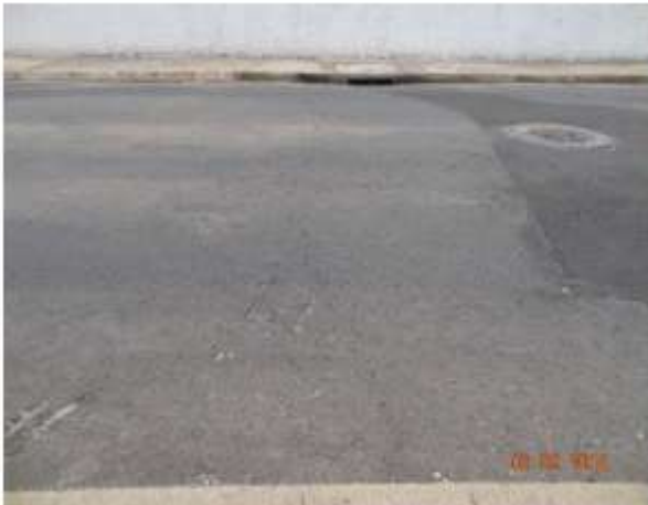
Fig. 18 - Trinca na capa asfáltica; (ANTES)
