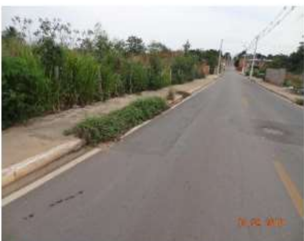
Fig. 23 - Boca de lobo obstruída; (ANTES)
