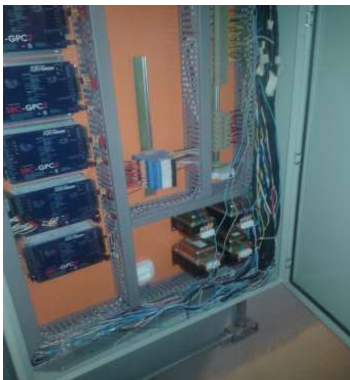
Figura 8.10 Quadro de automação faltando tampas nas canaletas e com fiação fora das canaletas
