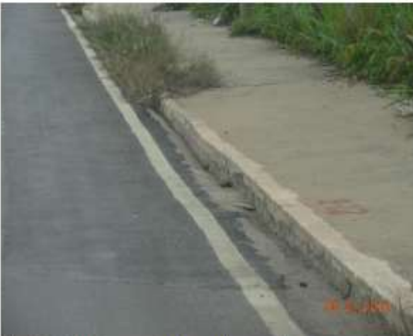
Fig. 25 - Sarjeta executada em desacordo com as especificações de projeto; (ANTES)
