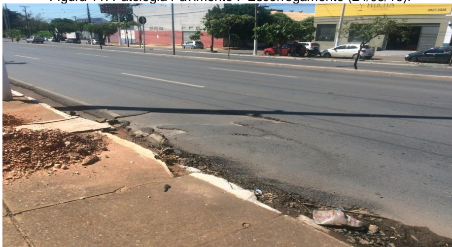
Figura 11: Patologia Pavimento . Escorregamento (24/03/16).
