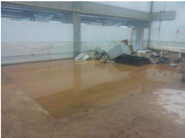
Fig. 05 – Auditório ainda se encontrava alagado.
