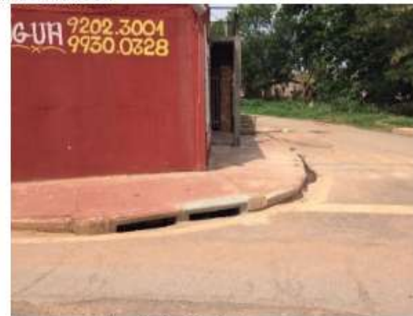
Fig. 19 - Guia chapéu danificada; (DEPOIS)
