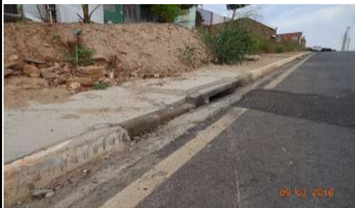
Fig. 15 - Afundamento de meio fio, trinca na capa asfáltica;
