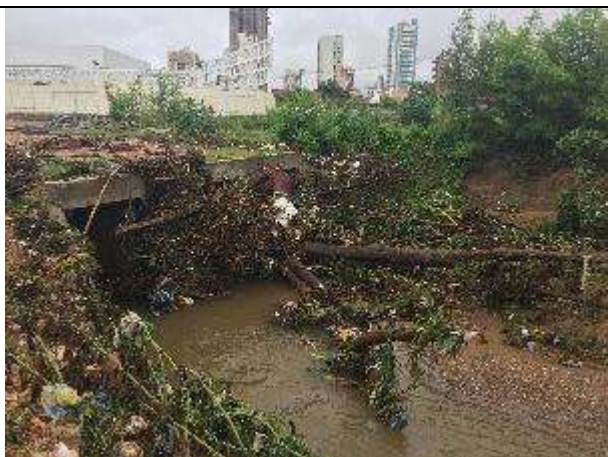
Fig. 02 – Obstrução do canal do córrego.
