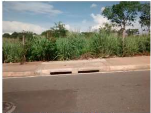
Fig. 28 - Boca de lobo danificada; (DEPOIS)
