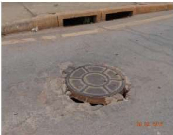
Fig. 20 - Poço de visita com pescoço danificado; (ANTES)
