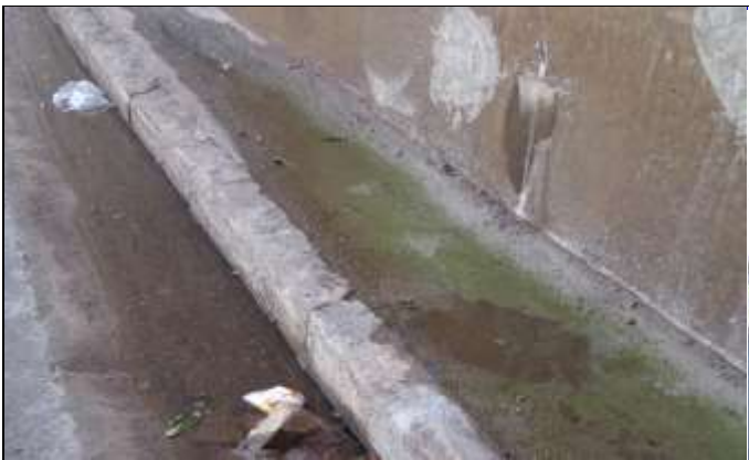
Fig. 11 - Água proveniente do aterro que encosta na parede da trincheira
