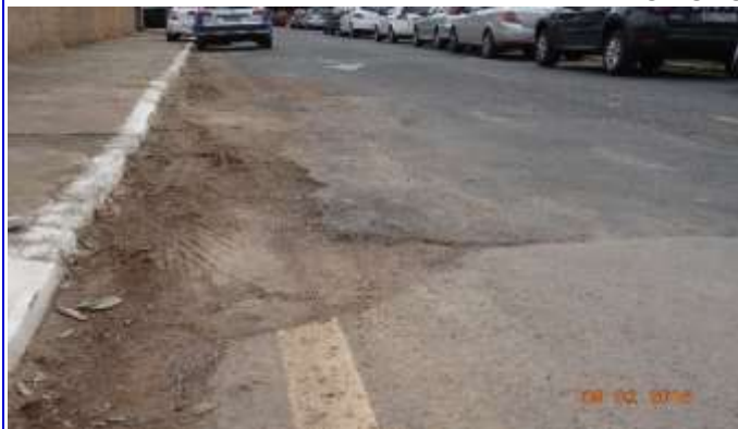
Fig. 7 - Pavimento com patologias, sugerindo a não execução da sarjeta, meio fio executado sem acabamento.
