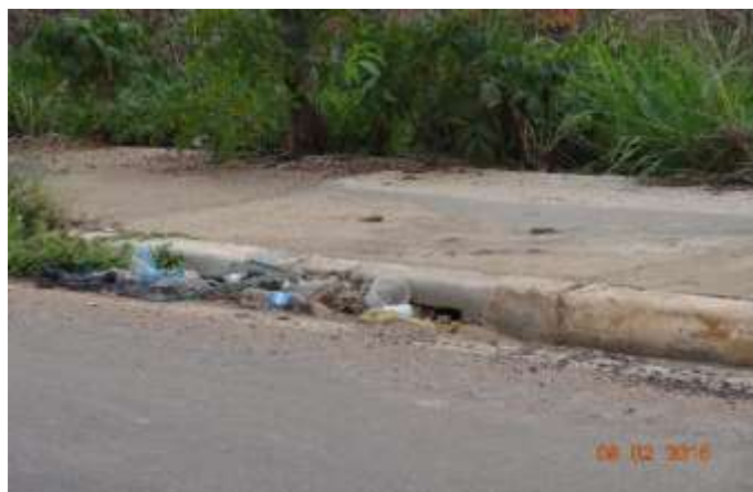
Fig. 26 - Boca de lobo obstruída;
