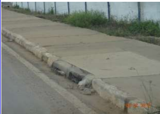
Fig. 27 - Guia chapéu danificada;
