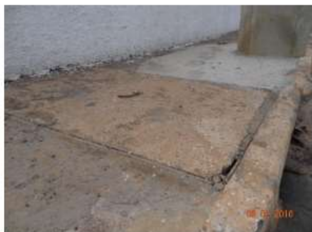
Fig. 11 - Restos de forma e armação da tampa da BL exposta; (ANTES)
