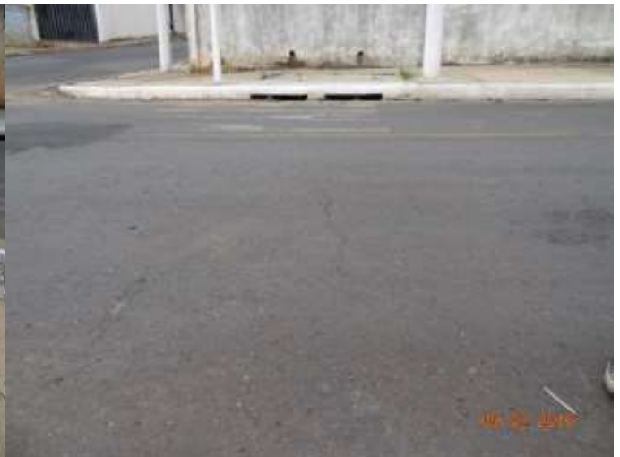
Fig. 2 - Trinca na capa asfáltica;
