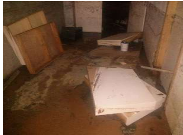
Fig. 06 – Portas de madeira foram arrancadas pela força da água.
