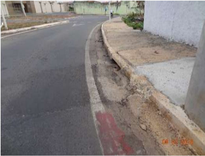
Fig. 9 - Meio fio não conforme, Sarjeta trincada;
