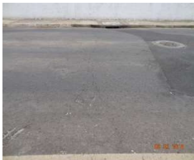
Fig. 18 - Trinca na capa asfáltica;
