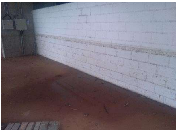
Fig. 01 – Nível da água chegou a aproximadamente 1,50m.
