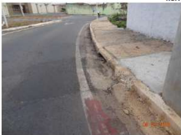
Fig. 9 - Meio fio não conforme, Sarjeta trincada; (ANTES)
