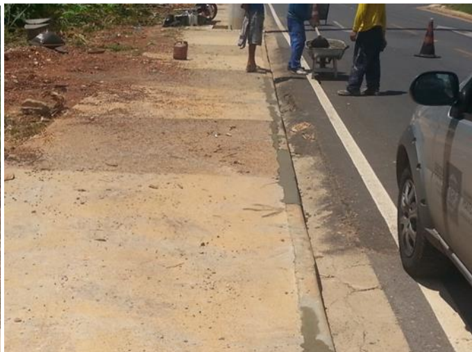
Fig. 2 -21/03/2016 - Os serviços realizados até esta data foram correção das calçadas e meio fios;
