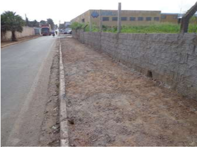
Fig. 9- Retirada do meio-fio para realinhamento e troca dos que estão danificados na Joaquim Murтинho
