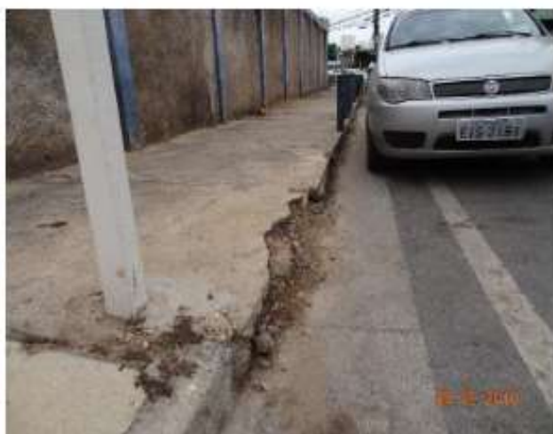
Fig. 5 - Meio fio não executado; (ANTES)
