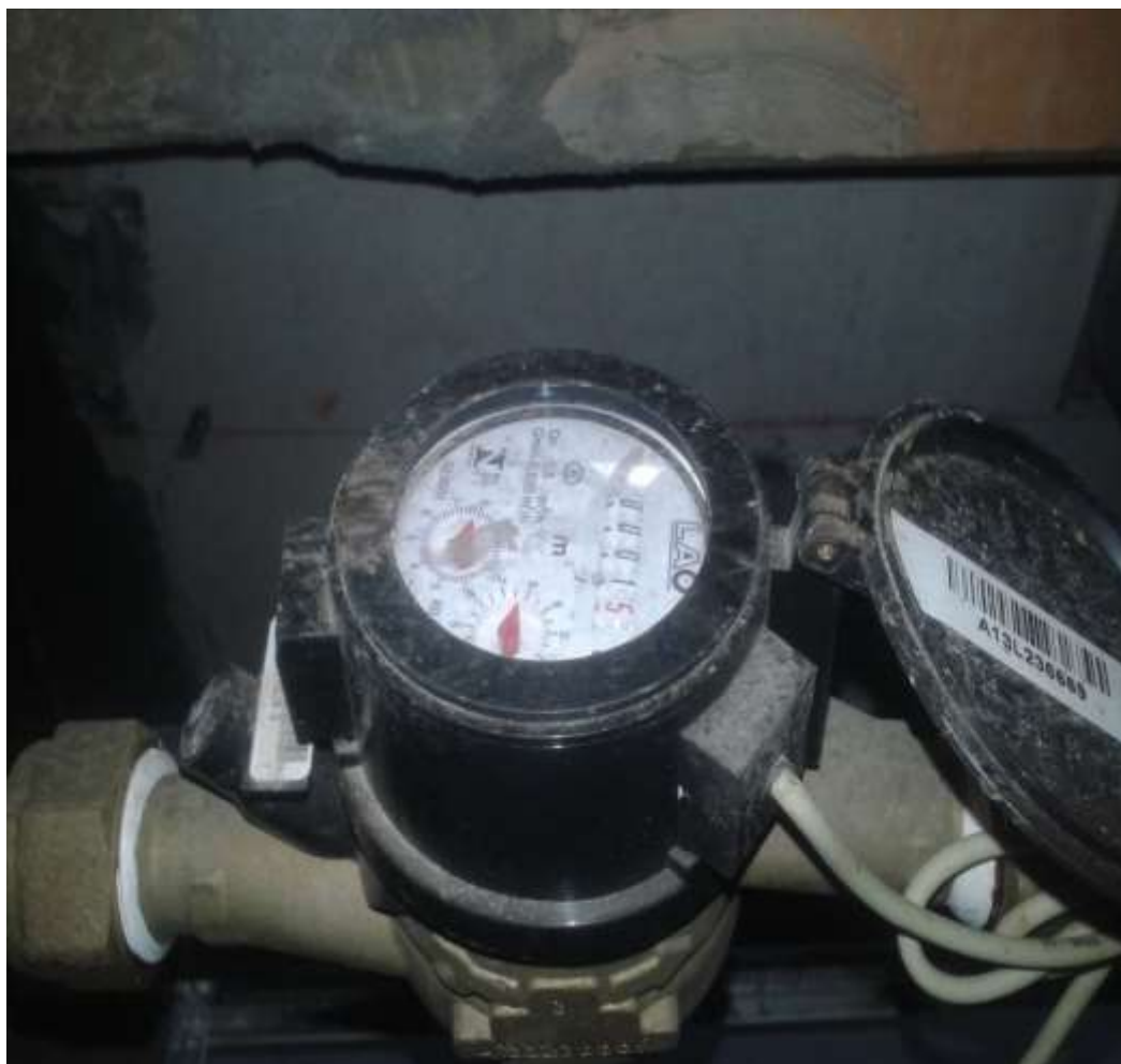
Figura 8.2 – Medidor de consumo de água (hidrômetro) instalado sobre o forro de restaurante
