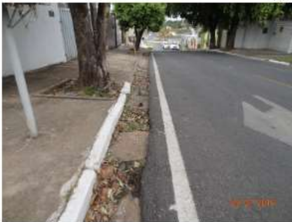
Fig. 29 - Sarjeta danificada; (ANTES)
