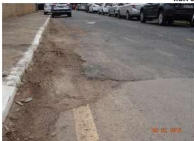
Fig. 7 - Pavimento com patologias. (ANTES)
