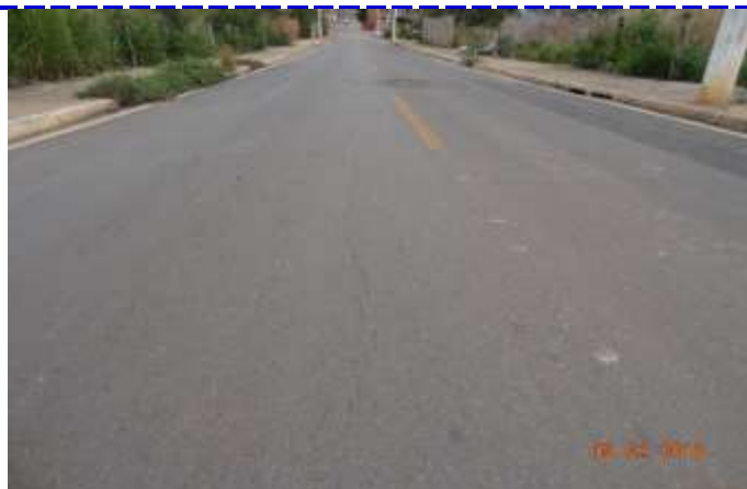
Fig. 24 - Trinca na capa asfáltica;
