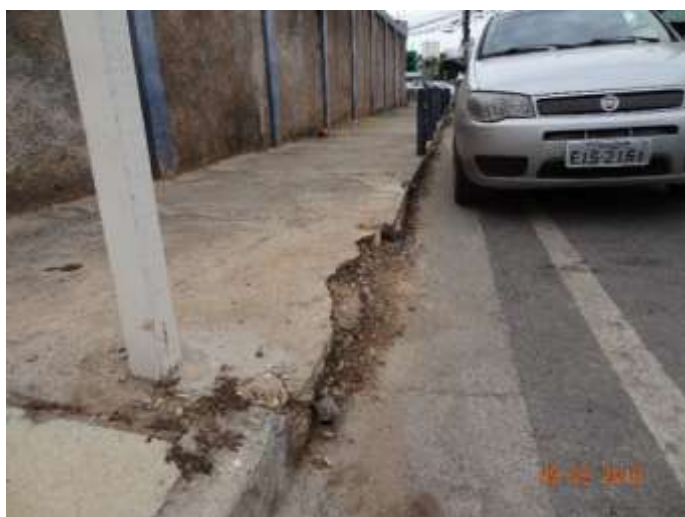
Fig. 5 - Meio fio não executado;
