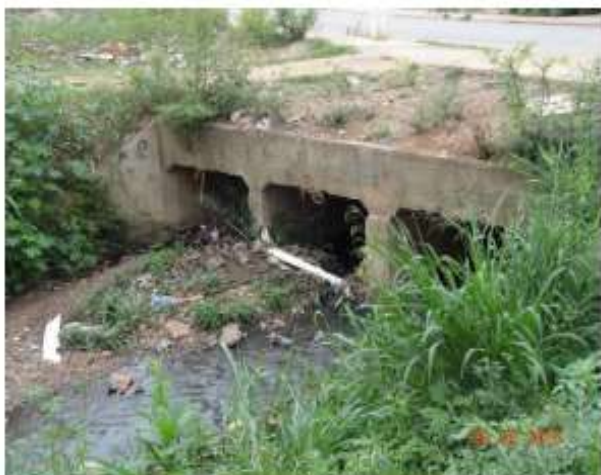
Fig. 21 - Bueiro celular triplo obstruído; (ANTES)
