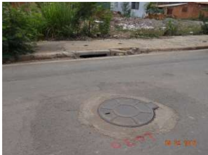
Fig. 22 - Guia chapéu danificada;
