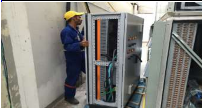
FOTO 01: Instalação de Painel elétrico da sala técnica de Climatização.
