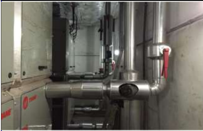
ISOLAMENTO DA TUBULAÇÃO DE ÁGUA GELADA SALA DE CLIMATIZAÇÃO
