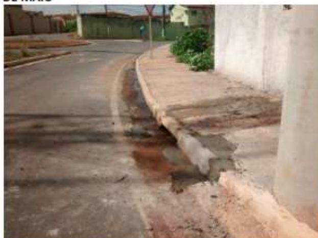
Fig. 9 - Meio fio não conforme, Sarjeta trincada; (DEPOIS)
