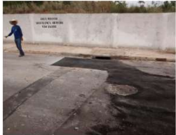
Fig. 18 - Trinca na capa asfáltica; (DEPOIS)
