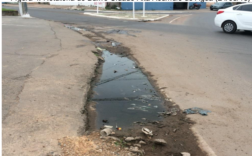
Figura 4: Rotatória do Bairro Cidade Alta Acumulo de Água (24/03/16)
