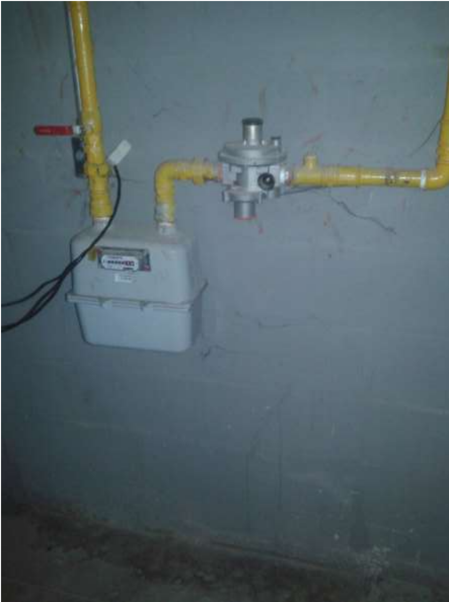
Figura 8.3 - Medidor de consumo de gás instalado em parede no nível 00 para atendimento de restaurante
