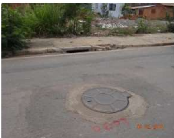
Fig. 22 - Guia chapéu danificada; (ANTES)
