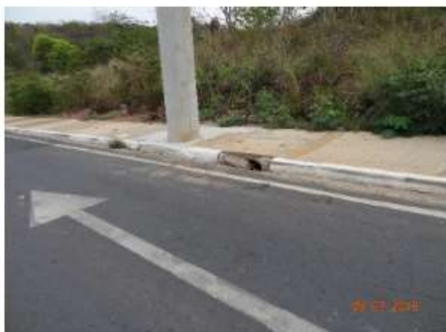
Fig. 10 - Guia chepéu danificada; (ANTES)
