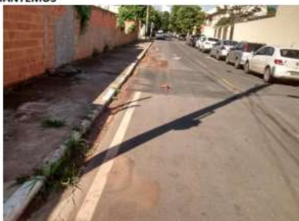
Fig. 7 - Pavimento com patologias. (DEPOIS)
