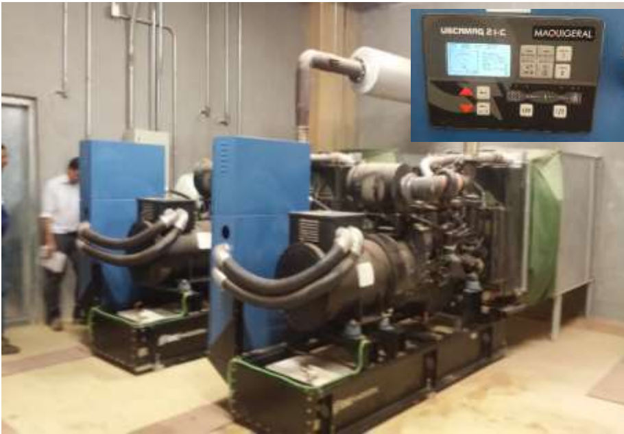
Figura 8.8 – Grupos geradores instalados na sala de Geradores da subestação 02, localizada no nível 00 da Arena.
