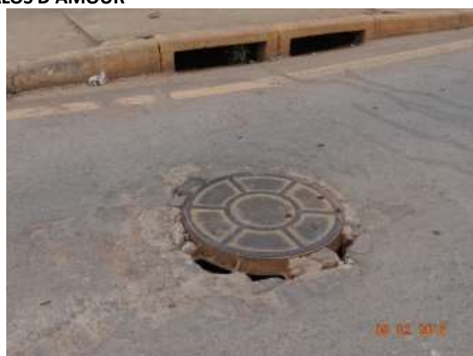
Fig. 20 - Poço de visita com pescoço danificado;
