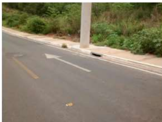
Fig. 10 - Guia chepéu danificada; (DEPOIS)
