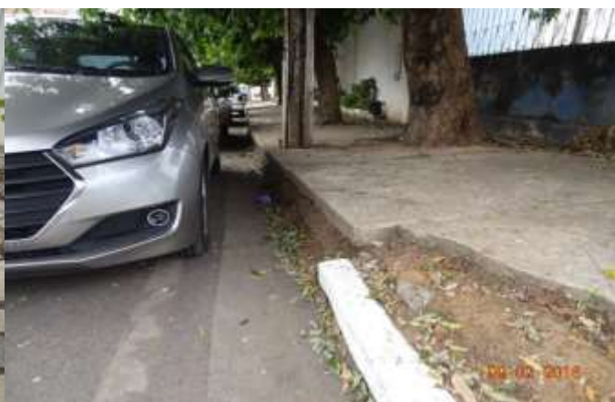
Fig. 4 - Meio fio não executado;
