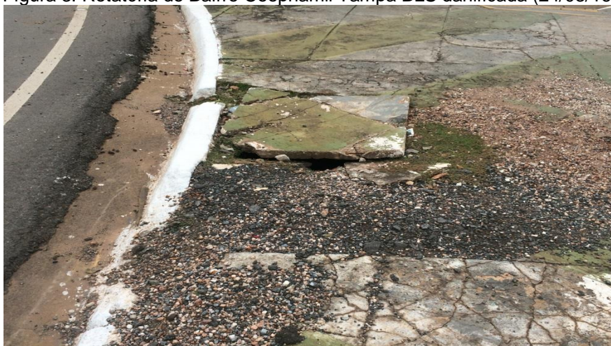
Figura 3: Rotatória do Bairro Coophamil Tampa BLS danificada (24/03/16)
