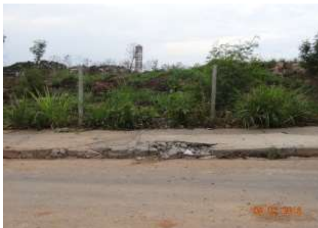
Fig. 28 - Boca de lobo danificada;
