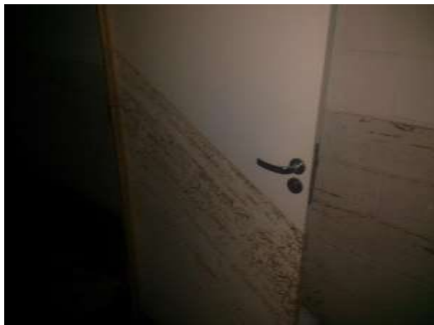
Fig. 02 – Portas de madeira danificadas pela água.
