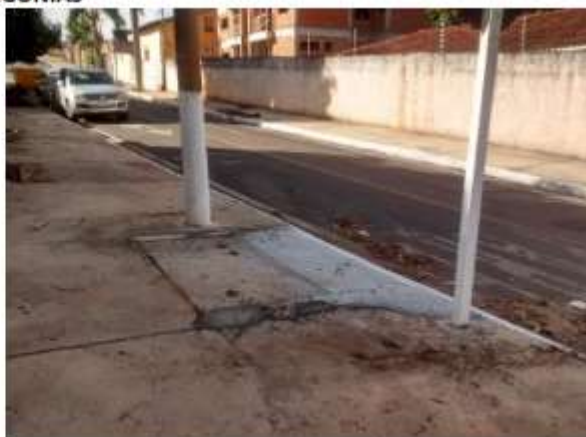
Fig. 1 - Falta acabamento da calçada, concretagem sobre material orgânico, alças da tampa estão salientes; (DEPOIS)
