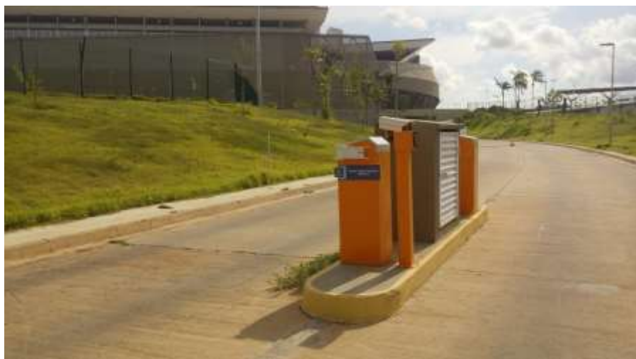
Registro 5. Cancela de acesso ao estacionamento interno pelo túnel do setor leste. Falta conclusão por meio da instalação dos braços.
