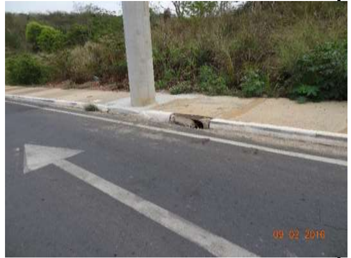
Fig. 10 - Guia chapéu danificada;
