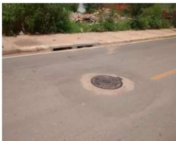
Fig. 22 - Guia chapéu danificada; (DEPOIS)
