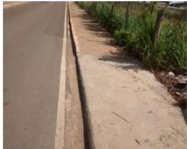
Fig. 25 - Sarjeta executada em desacordo com as especificações de projeto; (DEPOIS)
