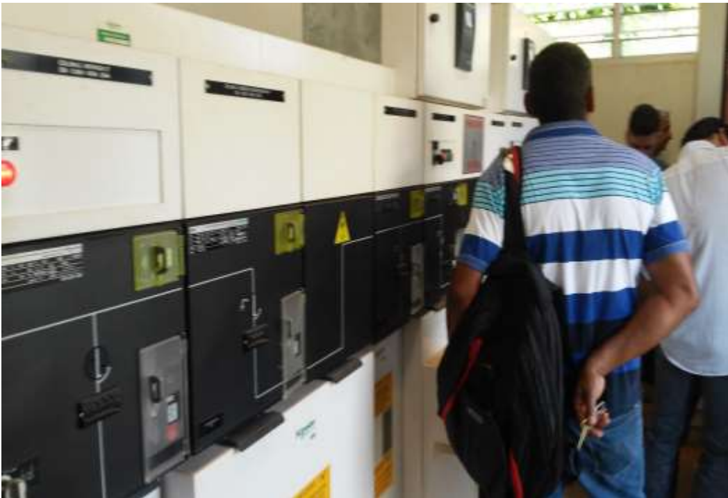
Figura 8.6 - Painéis de Média Tensão – cubículos de entrada de energia da concessionária na área externa.
