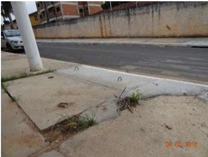
Fig. 1 - Falta acabamento da calçada, concretagem sobre material orgânico, alças da tampa estão salientes;
