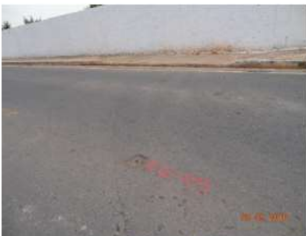
Fig. 17 - Trinca na capa asfáltica; (ANTES)
