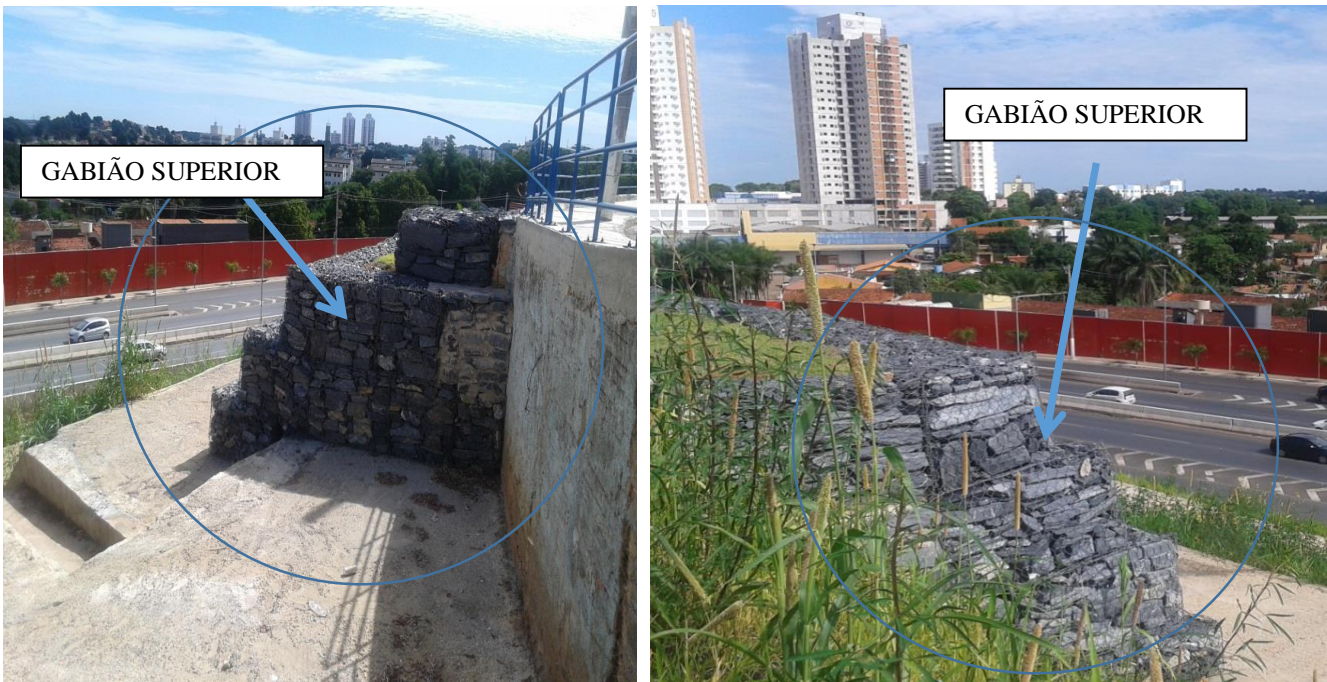
Gabiões com execução diferente do projeto executivo e o As Built.
