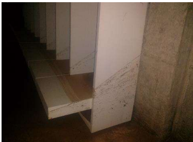
Fig. 03 – Armários de madeira dos vestiários danificados pela água.
