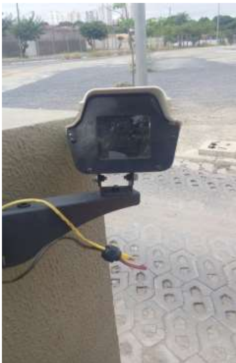
Registro 1. Câmera destinada à captação de imagens nas cancelas da entrada do estacionamento do setor sul faltando parte interna, apenas carcaça instalada.
