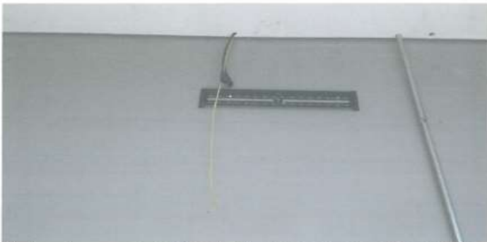
. Cabo de rede sem conector RJ-45 e televisão não instalada, Setor Oeste, Nível 10, Loja.
