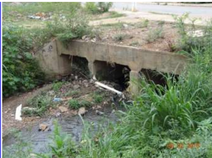
Fig. 21 - Bueiro celular triplo obstruído;
