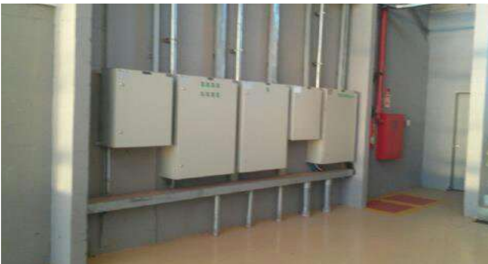
Figura 8.5 - Quadro de comando de iluminação instalado em parede no nível 40.
