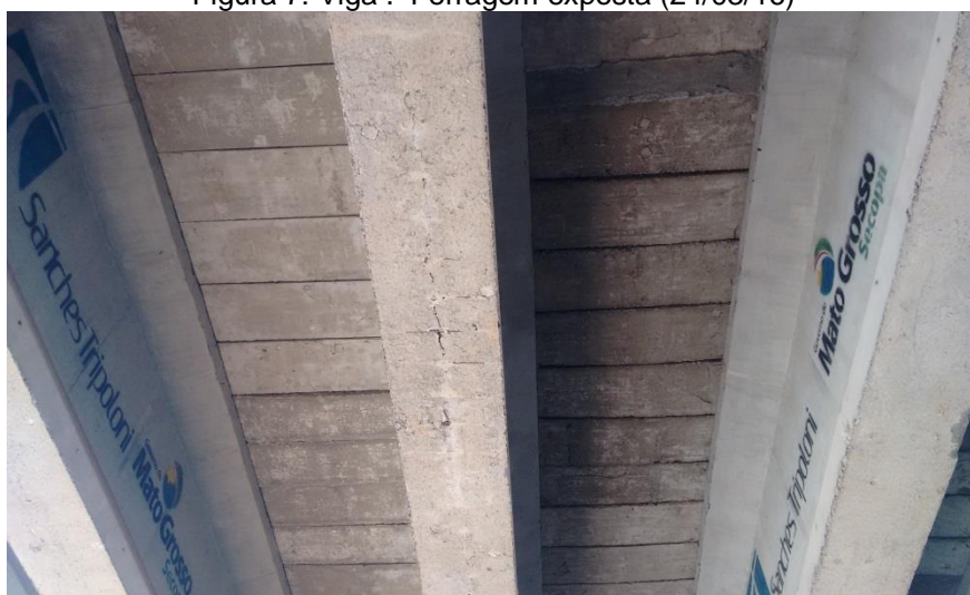
Figura 7: Viga . Ferragem exposta (24/03/16)
