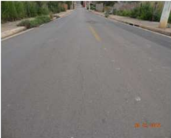
Fig. 24 - Trinca na capa asfáltica; (ANTES)
