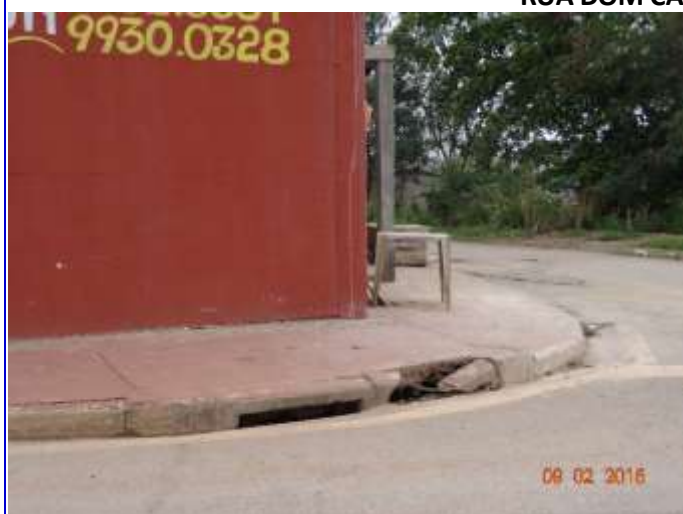
Fig. 19 - Guia chapéu danificada;
