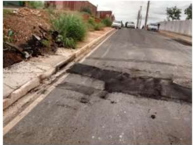
Fig. 15 - Afundamento de meio fio, trinca na capa asfáltica; (DEPOIS)
