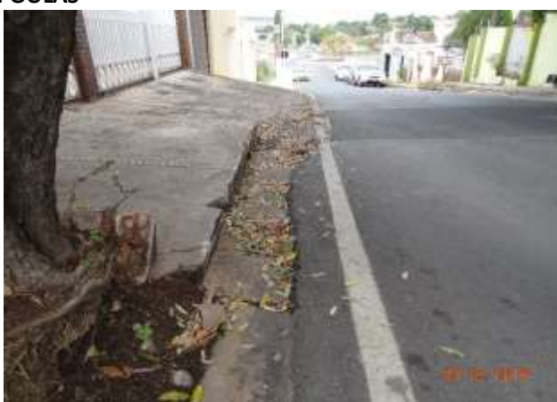
Fig. 30 - Meio fio não executado e sarjeta danificada;
