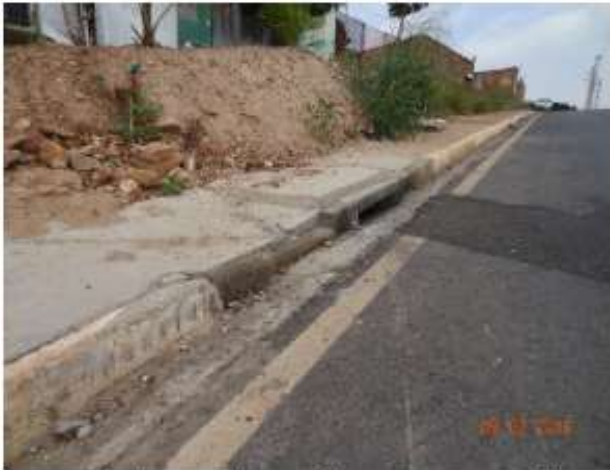
Fig. 15 - Afundamento de meio fio, trinca na capa asfáltica; (ANTES)
