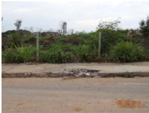
Fig. 28 - Boca de lobo danificada; (ANTES)
