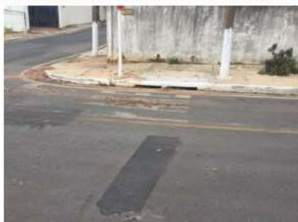
Fig. 2 - Trinca na capa asfáltica; (DEPOIS)
