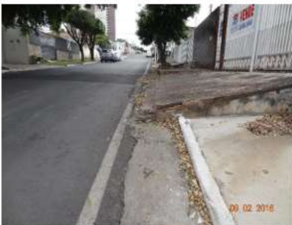
Fig. 32 - Rampa de acesso invadindo a sarjeta; (ANTES)
