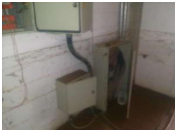
Fig. 04 – Quadro de distribuição ficou alagado.
