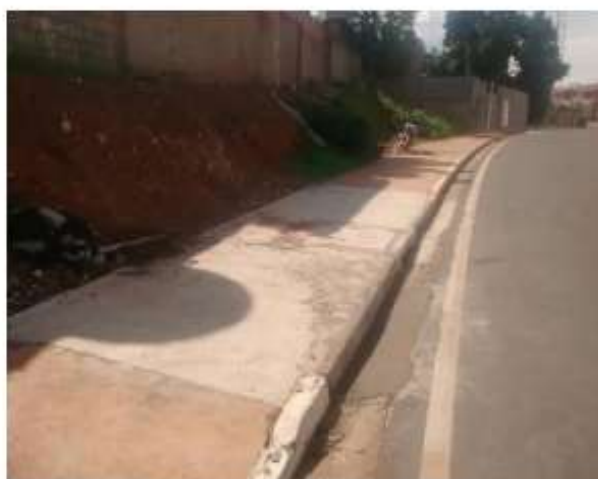
Fig. 13 - Sarjeta executada em desacordo com as especificações de projeto; (DEPOIS)
