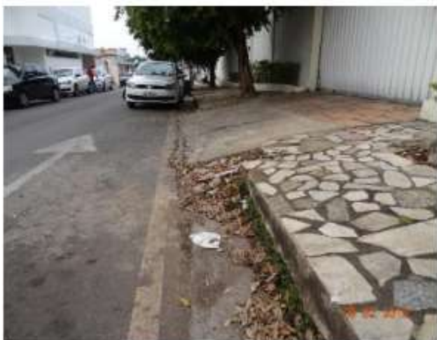
Fig. 3 - Meio fio não executado, rampa de acesso avançando sobre a sarjeta; (ANTES)
