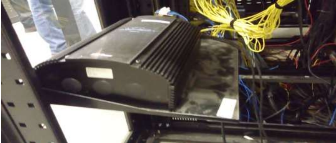
Registro 3. Equipamento ativo empoeirado.
