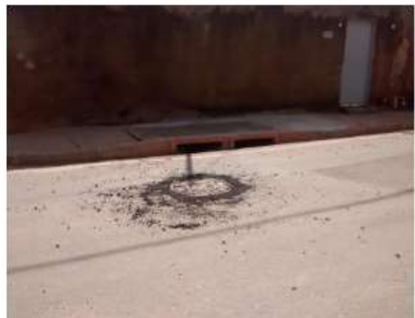
Fig. 20 - Poço de visita com pescoço danificado; (DEPOIS)
