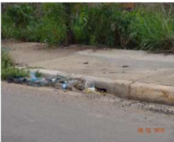
Fig. 26 - Boca de lobo obstruída; (ANTES)
