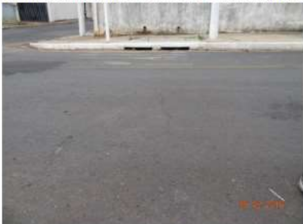
Fig. 2 - Trinca na capa asfáltica; (ANTES)
