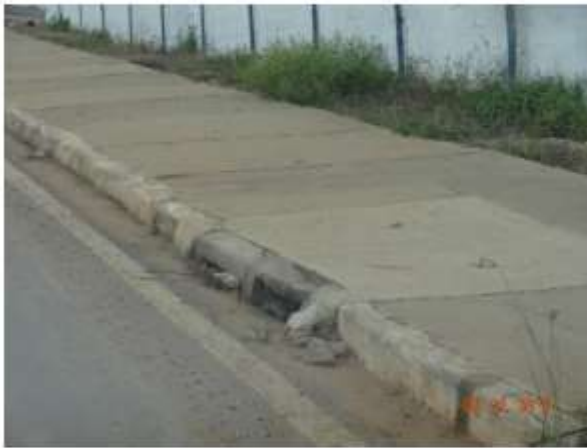
Fig. 27 - Guia chapéu danificada; (ANTES)
