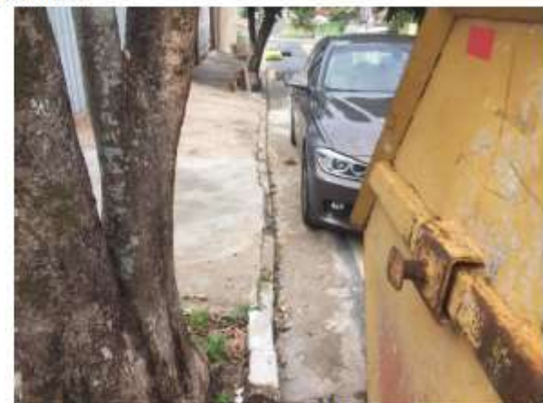
Fig. 29 - Sarjeta danificada; (DEPOIS)
