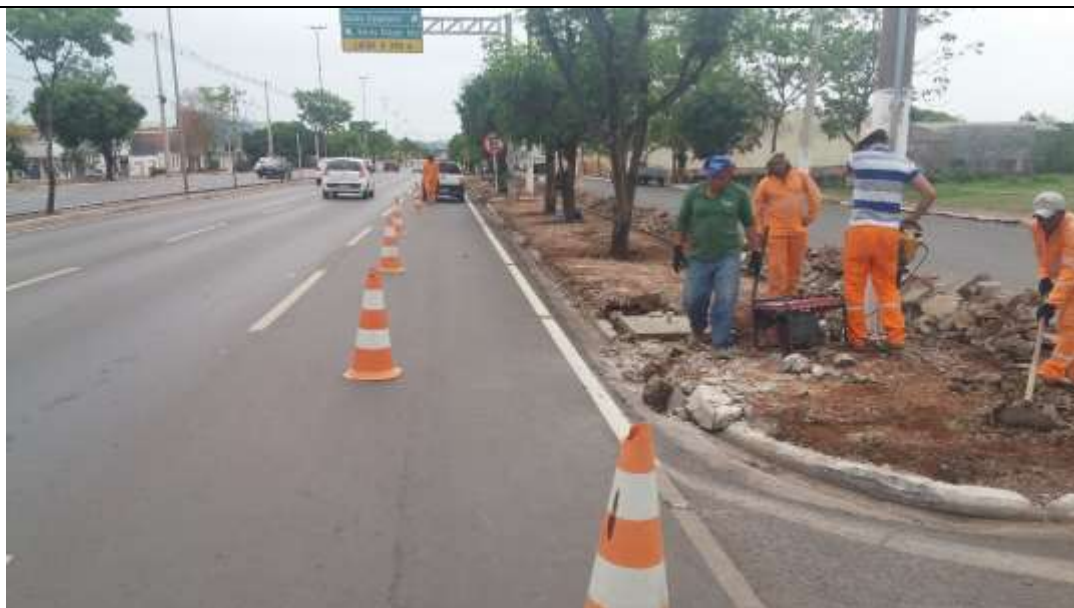
Foto 3.07 – Arrancamento e remoção de meio fio e calçada deteriorados na Av. Miguel Sutil.
