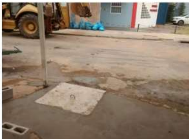
Fig. 6 - Boca de lobo e Poço de Visita não executados; (DEPOIS)
