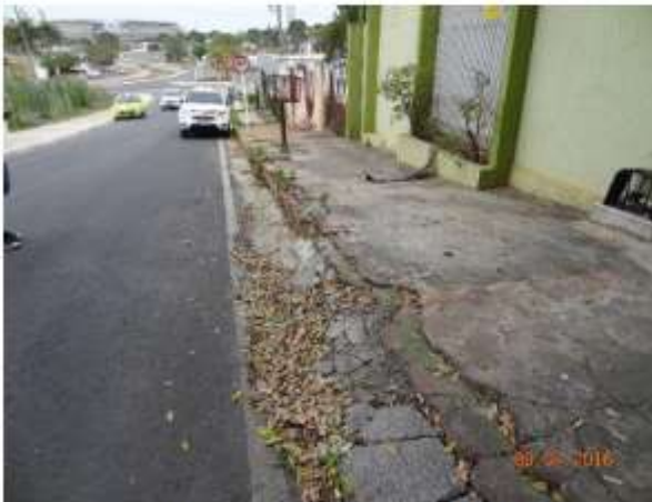
Fig. 31 - Meio fio e sarjeta danificados; (ANTES)
