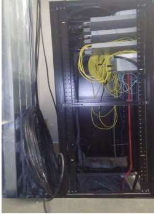
Registro 1. Rack metálico sem o fechamento com a tampa própria. Sujeito à poeira e umidade.
