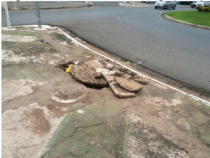
Figura 1: Rotatória do Bairro Cidade Alta sem drenagem (24/03/16)
