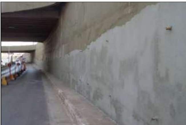
Fig. 11 - Bicos injetores já fixados e o PU foi injetado. A empresa deverá grautiar os furos e lixar a parede
