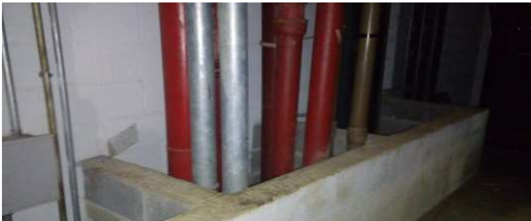
Registro 2. Shaft dentro de sala técnica utilizado para tubulações de hidráulica aberto, sem vedação apropriada a evitar perda de climatização e entrada de poeira.
