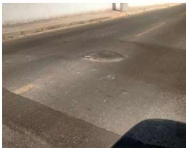
Fig. 12 - Acabamento do Poço de Visita com deterioração precoce; (DEPOIS)
