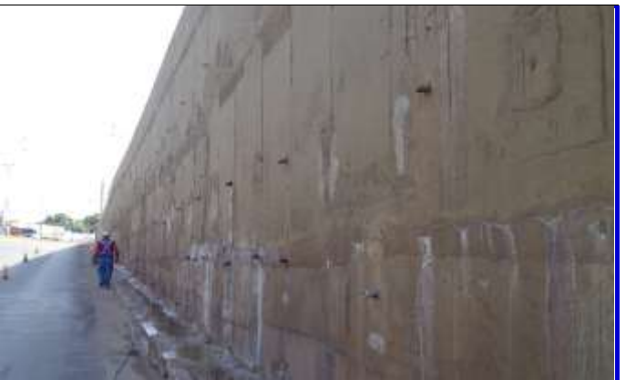
Fig. 12 - Parede da trincheira, onde irá fazer a injeção de PU para conter as infiltrações
