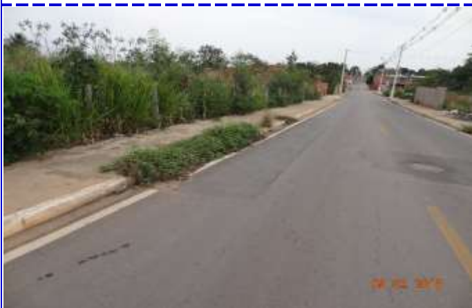
Fig. 23 - Boca de lobo obstruída;
