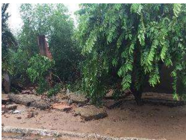
Fig. 06 – Muro da rua Ottawa que desabou.
