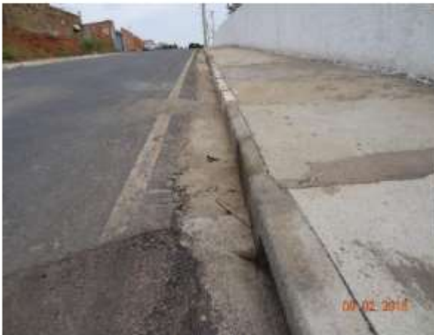
Fig. 16 - Sarjeta trincada; (ANTES)
