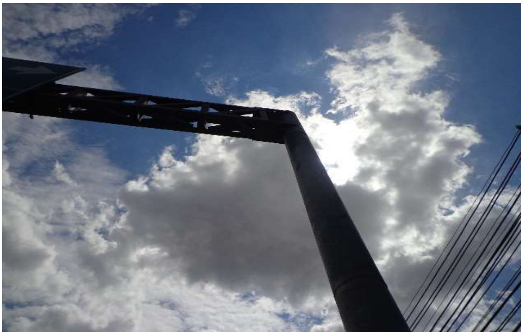
Foto 3.7 – Bandeira metálica na Av. da FEB ( estaca 0 + 540 ).
