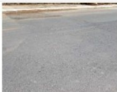
Afundamento da pista
