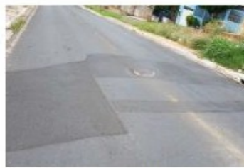
Afundamento da pista
