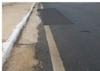
Afundamento da pista e da sarjeta
