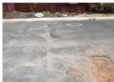
Deformação e buracos na pista
