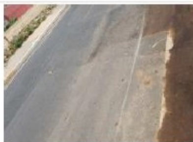
Afundamento da pista com acúmulo de sedimentos
