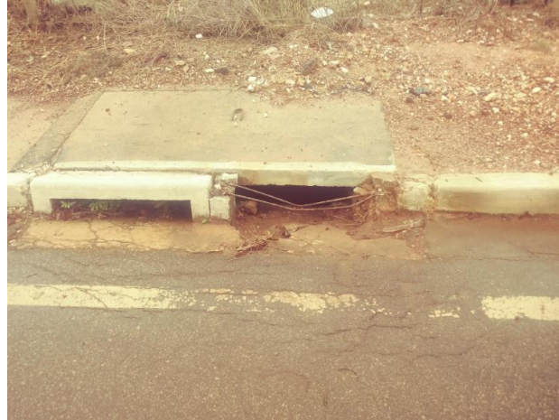
15° 35' 37" S e 56° 7' 4.5 " W (meio-fio quebrado)
