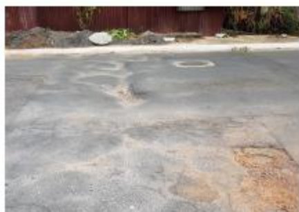
Deformação e buracos na pista
