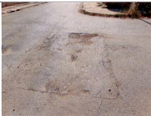
Fotografia 29 – Remendo mal feito
