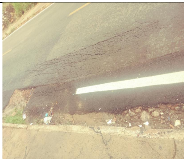
15° 35' 56" S e 56° 7' 41" W Trincas, afundamento e buraco no pavimento
