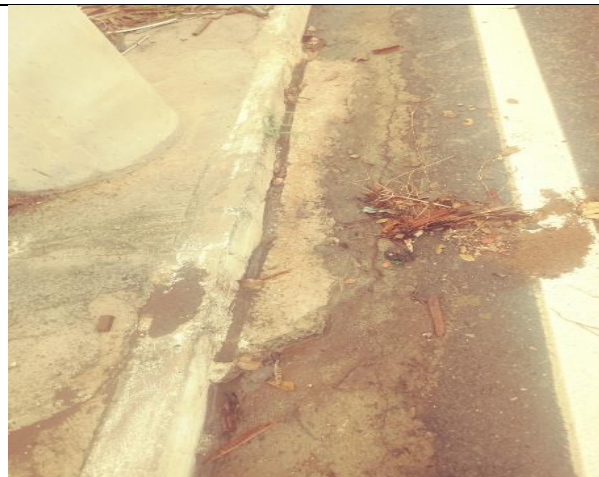
15° 35' 52" S e 56° 7' 43" W Excesso de material na sarjeta
