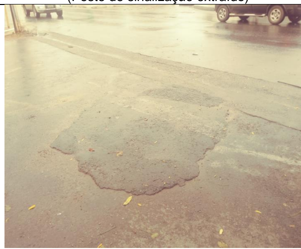
15° 35' 41" S e 56° 7' 3" W (excesso de material betuminoso no pavimento)
