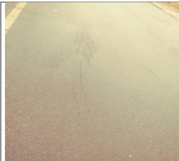
15° 35' 38" S e 56° 7' 5" W (trincas longitudinais)
