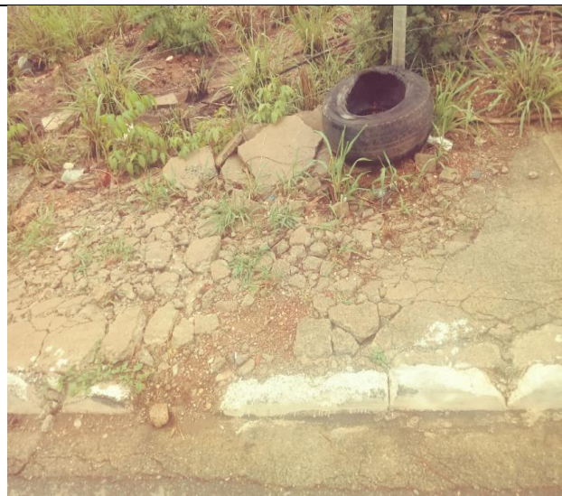
15° 36' 24" S e 56° 8' 2.5" W Meio-fio e calçada danificadas
