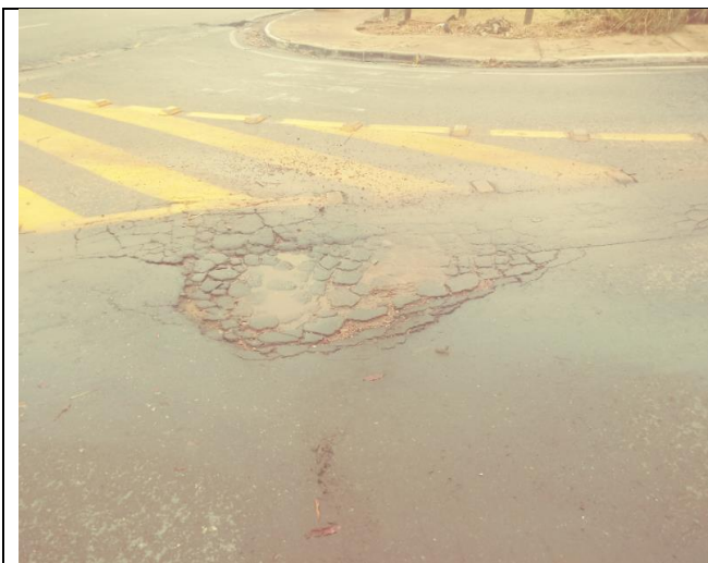
15° 36' 0.2" S e 56° 7' 34" W "Panela" e trincas no pavimento
