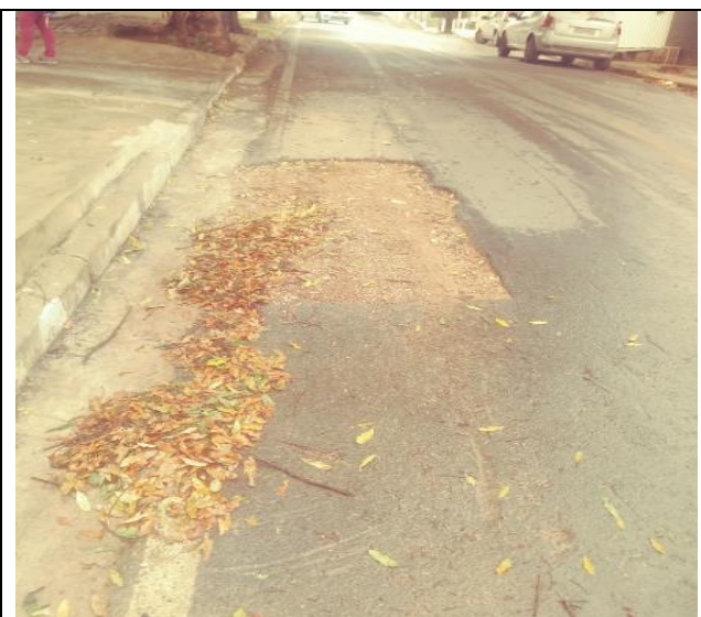
15° 35' 49" S e 56° 6' 54" W (Buraco no pavimento)
