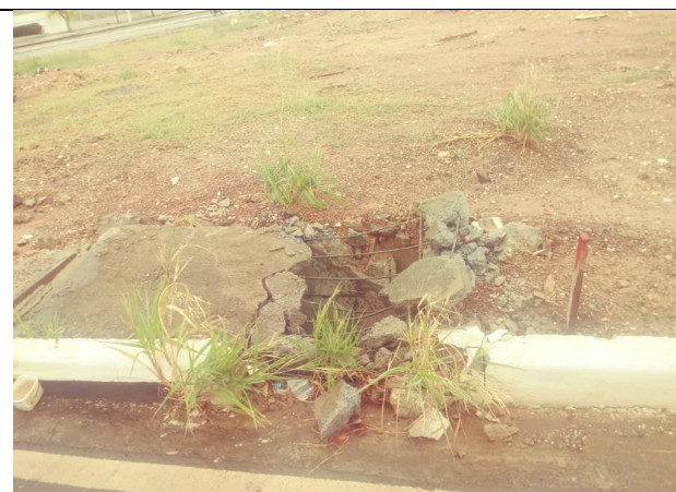
15° 35' 50" S e 56° 6' 56" W (Tampa de "boca de lobo" danificada)
