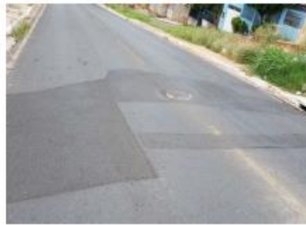
Afundamento da pista
