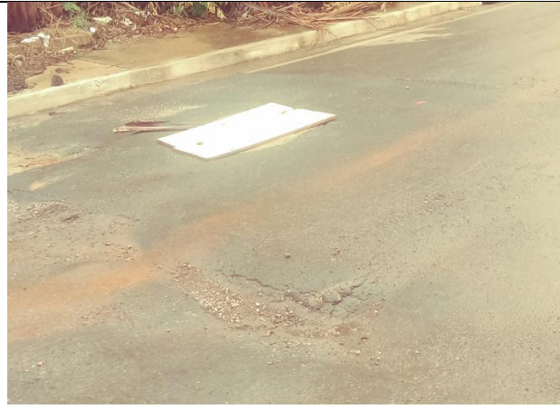
15° 35' 36" S e 56° 7' 2.1 " W (afundamento)
