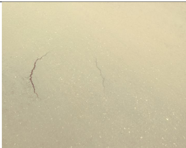
15° 35' 50" S e 56° 6' 55" W (Trinca e "afundamento" no pavimento)
