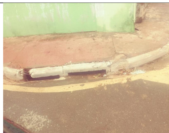
15° 36' 18" S e 56° 8' 5.4" W - Meio-fio quebrado
