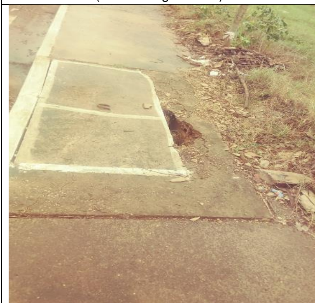
15° 35' 37" S e 56° 7' 3.4" W (tampa de "boca de lobo" danificada)
