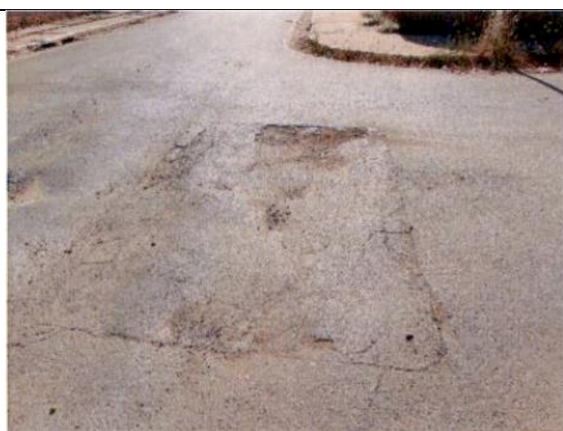
Fotografia 29 – Remendo mal feito
