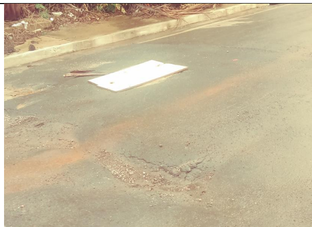
15° 35' 36" S e 56° 7' 2.1 " W (afundamento)
