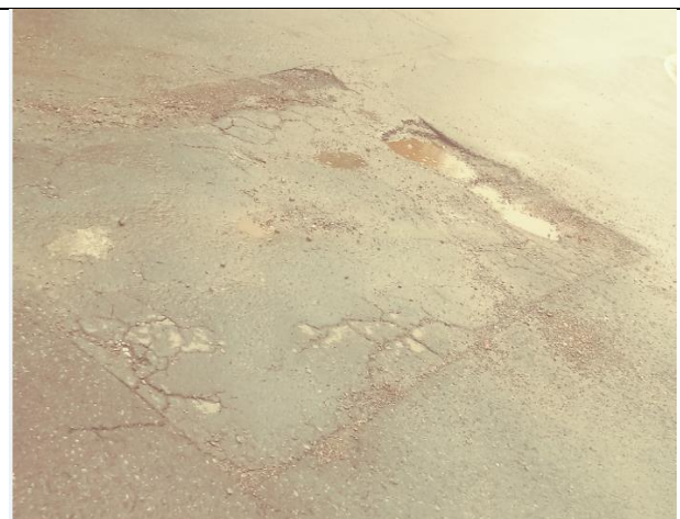
15° 35' 36" S e 56° 7' 2.1 " W (afundamento)
