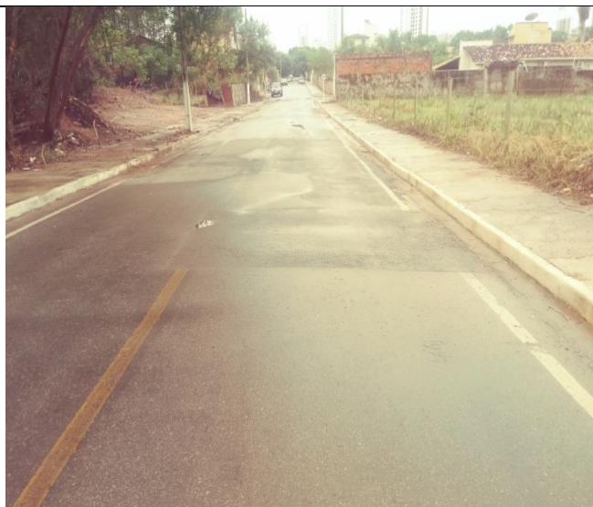
15° 35' 37" S e 56° 7' 4.5" W (remendos mal executados)
