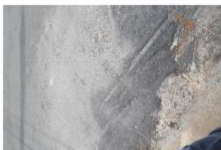
Remendo mal executado
