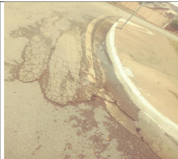
15° 36' 26" S e 56° 8' 2" W Trincas e excesso de material betuminoso no asfalto e sarjeta
