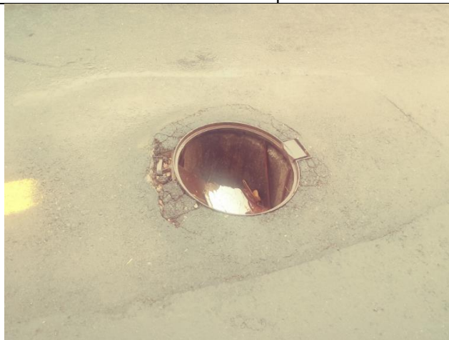
15° 35' 46" S e 56° 7' 50" W Poço de visita sem tampa e com rachaduras
