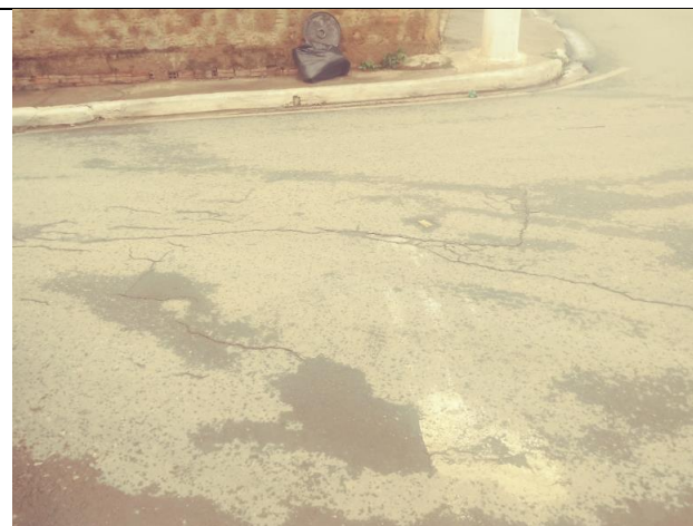
15° 36' 15" S e 56° 8' 6.5" W Trincas no pavimento
