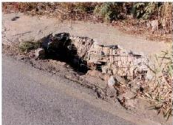
Fotografia 97 – Tampa BLS quebrada
