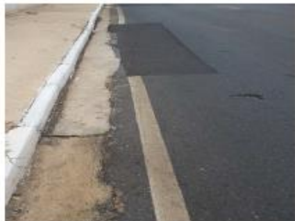
Afundamento da pista e da sarjeta
