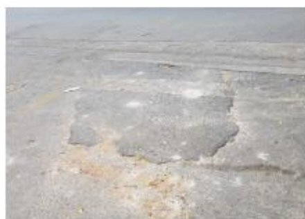
Remendo mal executado
