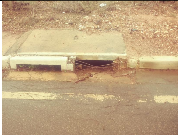
15° 35' 37" S e 56° 7' 4.5 " W (meio-fio quebrado)
