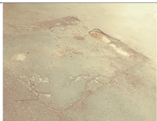
15° 35' 36" S e 56° 7' 2.1 " W (afundamento)
