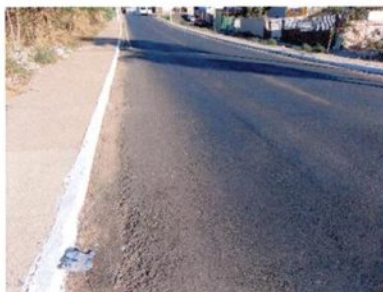
Fotografia 83 – Sarjeta mal feita
