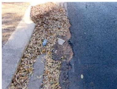
Fotografia 48 – Buraco no pavimento
