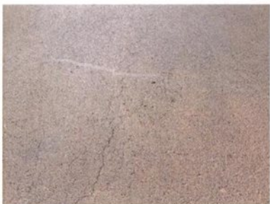
Fotografia 19 – Trinca "couro de jacaré"
