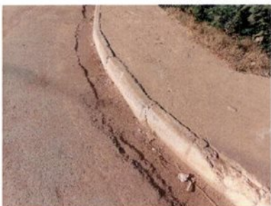
Fotografia 115 – Sarjeta mal feita
