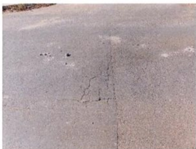
Fotografia 31 – Trinca "couro de jacaré"
