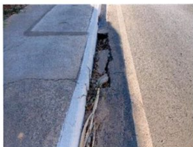
Fotografia 59 – Buraco na sarjeta
