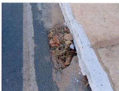
Fotografia 52 – Buraco na sarjeta
