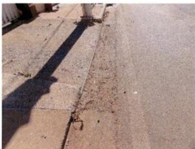
Fotografia 17 – Sarjeta mal feita
