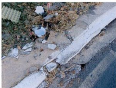
Fotografia 67 – Buraco no meio-fio e sarjeta
