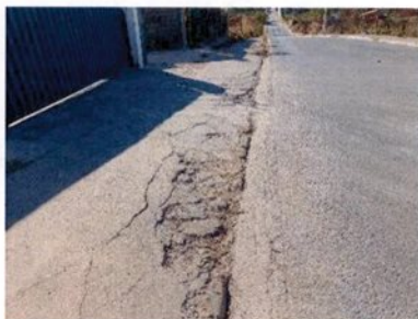
Fotografia 100 – Meio-fio e calçada quebrada
