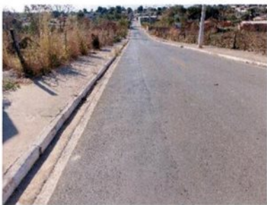
Fotografia 103 – Remendo mal feito
