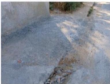
Fotografia 112 – Calçada mal feita
