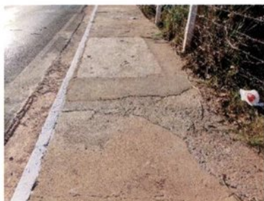
Fotografia 85 – Calçada e sarjeta quebrada
