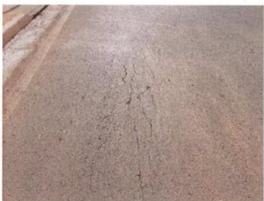
Fotografia 18 – Trinca "couro de jacaré"
