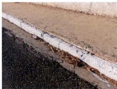
Fotografia 62 – Meio-fio e sarjeta quebrado
