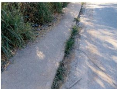
Fotografia 113 – Sarjeta mal feita
