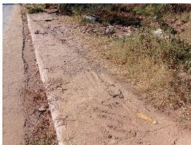
Fotografia 109 – Calçada mal feita
