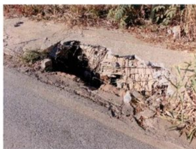
Fotografia 97 – Tampa BLS quebrada
