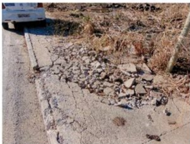
Fotografia 99 – Meio-fio e calçada quebrada
