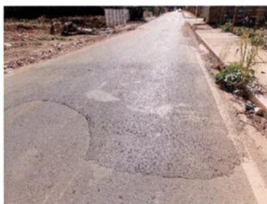
Fotografia 25 – Remendo mal feito
