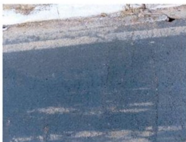
Fotografia 65 – Afundamento e trinca
