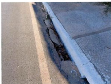
Fotografia 57 – Buraco na sarjeta
