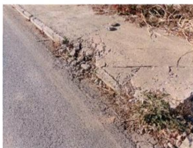
Fotografia 98 – Meio-fio e calçada quebrada
