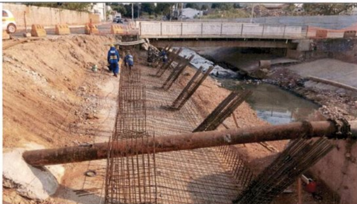
Fig. 05 – Execução da armadura da fundação da laje da rotatória da Av. Senador Metelo;
