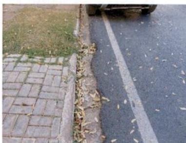
Fotografia 40 – Sarjeta mal feita
