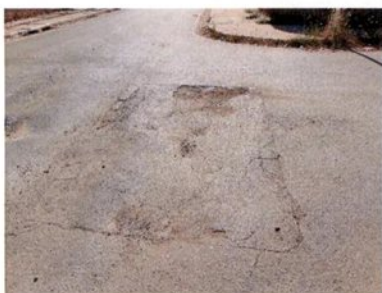
Fotografia 29 – Remendo mal feito
