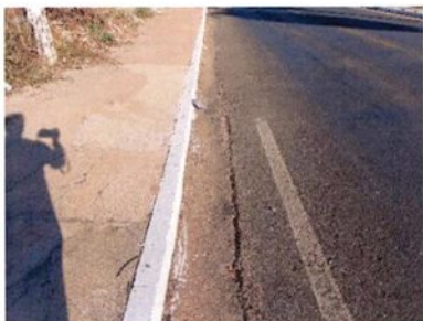
Fotografia 81 – Calçada e sarjeta quebrada
