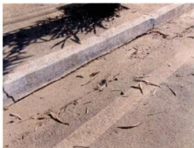
Fotografia 35 – Sarjeta mal feita
