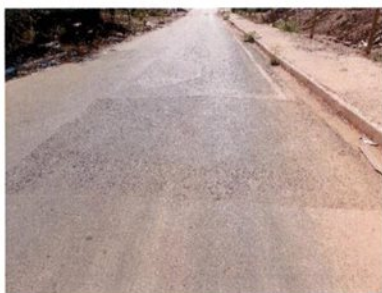
Fotografia 23 – Remendo mal feito
