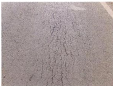
Fotografia 36 – Trinca "couro de jacaré"
