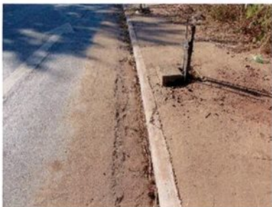
Fotografia 111 – Sarjeta mal feita
