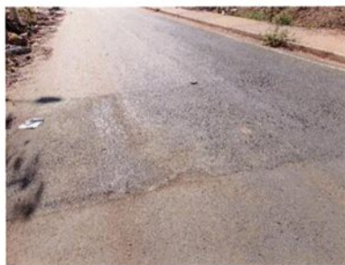
Fotografia 24 – Remendo mal feito
