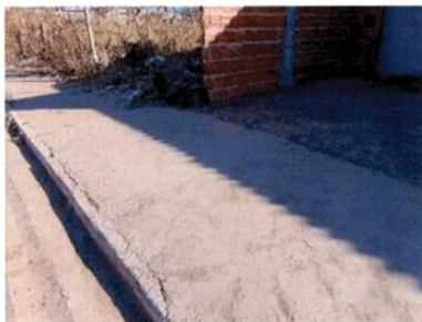
Fotografia 106 – Calçada mal feita
