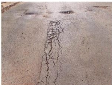
Fotografia 27 – Trinca "couro de jacaré"
