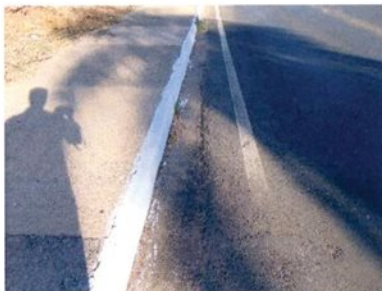
Fotografia 82 – Sarjeta mal feita
