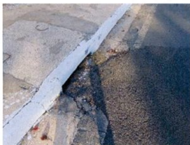
Fotografia 63 – Remendo mal feito
