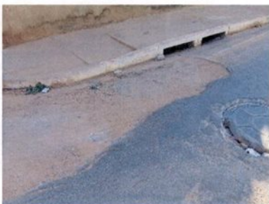
Fotografia 116 – Buraco no pavimento
