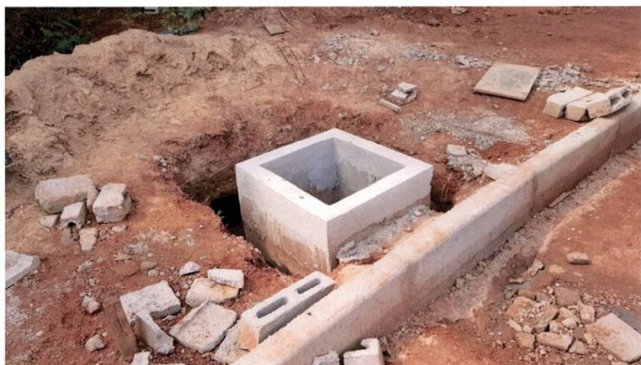
Fig. 06 – Caixa de passagem do equipamento Fotofinish.
