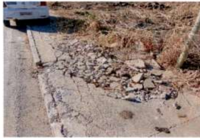
Fotografia 99 – Meio-fio e calçada quebrada
