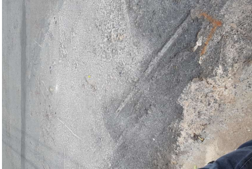
Remendo mal executado
