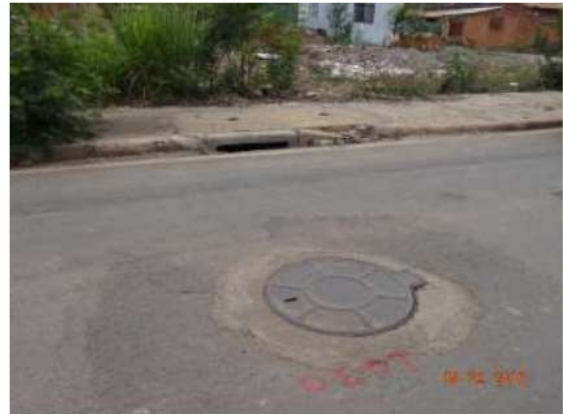
Fig. 22 - Guia chapéu danificada;
