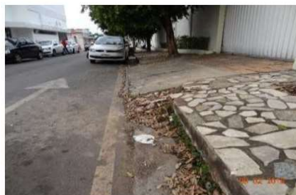
Fig. 3 - Meio fio não executado, rampa de acesso avançando sobre a sarjeta;
