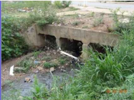
Fig. 21 - Bueiro celular triplo obstruído;
