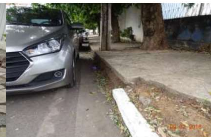
Fig. 4 - Meio fio não executado;
