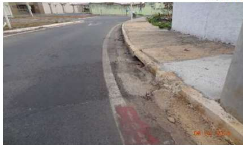
Fig. 9 - Meio fio não conforme, Sarjeta trincada;
