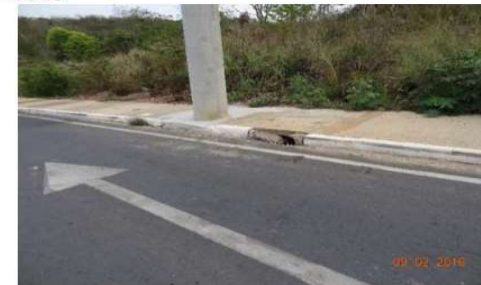
Fig. 10 - Guia chapéu danificada;
