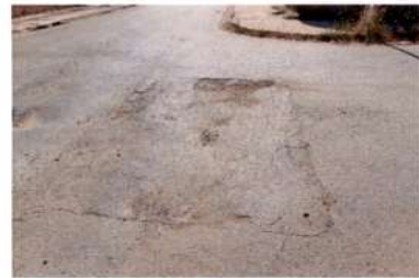
Fotografia 29 – Remendo mal feito
