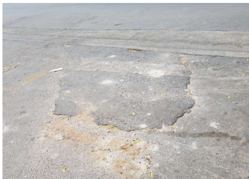
Remendo mal executado
