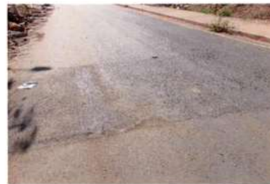
Fotografia 24 – Remendo mal feito
