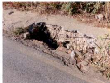
Fotografia 97 – Tampa BLS quebrada
