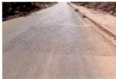
Fotografia 23 – Remendo mal feito
