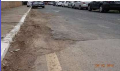
Fig. 7 - Pavimento com patologias, sugerindo a não execução da sarjeta, meio fio executado sem acabamento.
