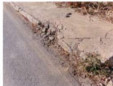
Fotografia 98 – Meio-fio e calçada quebrada
