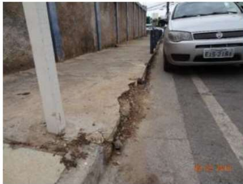
Fig. 5 - Meio fio não executado;
