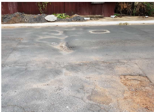
Deformação e buracos na pista
