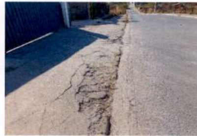
Fotografia 100 – Meio-fio e calçada quebrada
