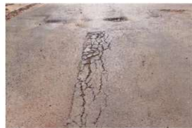
Fotografia 27 – Trinca "couro de jacaré"
