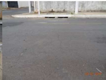
Fig. 2 - Trinca na capa asfáltica;
