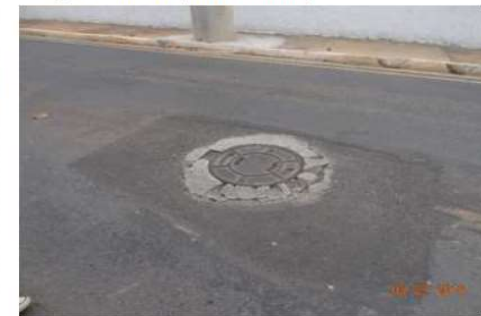
Fig. 12 - Acabamento do Poço de Visita com deterioração
