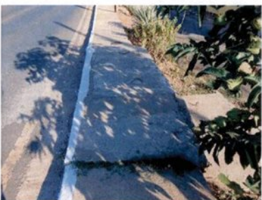
Fotografia 80 – Calçada mal feita
