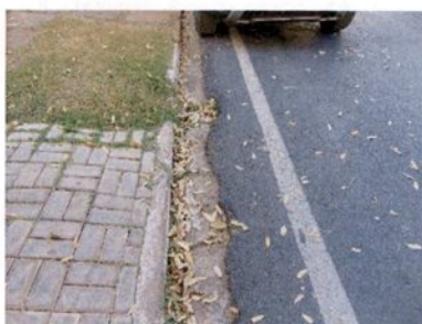
Fotografia 40 – Sarjeta mal feita
