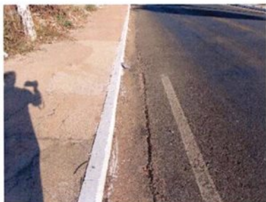
Fotografia 81 – Calçada e sarjeta quebrada
