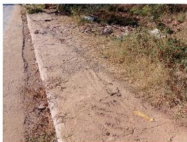
Fotografia 109 – Calçada mal feita
