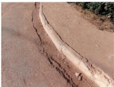
Fotografia 115 – Sarjeta mal feita
