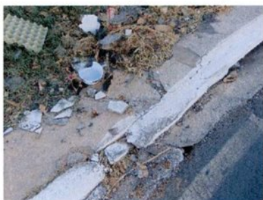
Fotografia 67 – Buraco no meio-fio e sarjeta
