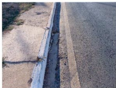
Fotografia 71 – Meio-fio e sarjeta quebrada
