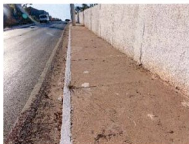
Fotografia 74 – Sarjeta mal feita
