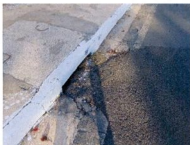
Fotografia 63 – Remendo mal feito
