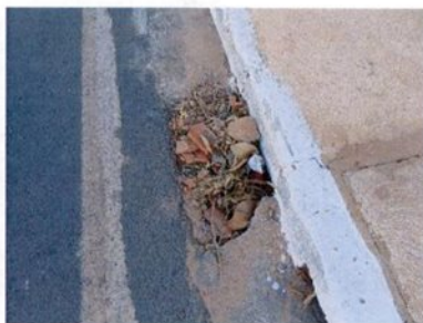
Fotografia 52 – Buraco na sarjeta
