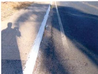
Fotografia 82 – Sarjeta mal feita
