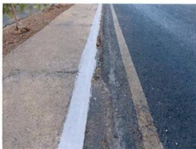
Fotografia 76 – Sarjeta mal feita
