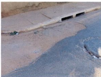
Fotografia 116 – Buraco no pavimento
