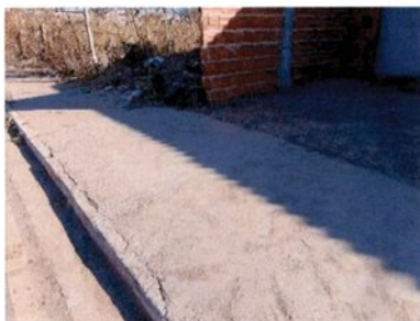
Fotografia 106 – Calçada mal feita
