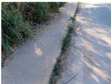
Fotografia 113 – Sarjeta mal feita
