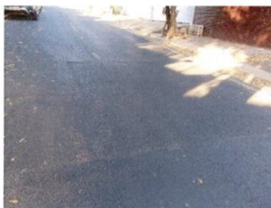
Fotografia 39 – Remendo mal feito
