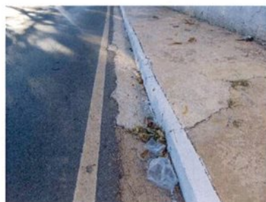
Fotografia 77 – Calçada e sarjeta quebrada
