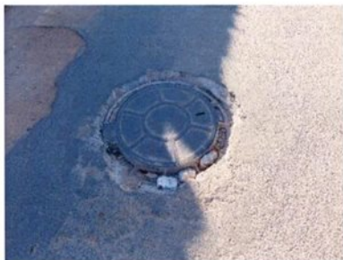
Fotografia 117 – Remendo mal feito
