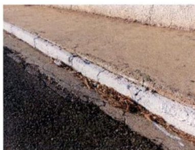
Fotografia 62 – Meio-fio e sarjeta quebrado
