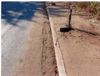
Fotografia 111 – Sarjeta mal feita
