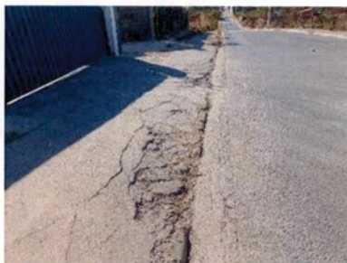
Fotografia 100 – Meio-fio e calçada quebrada
