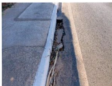
Fotografia 59 – Buraco na sarjeta
