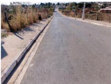
Fotografia 103 – Remendo mal feito
