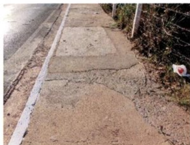
Fotografia 85 – Calçada e sarjeta quebrada
