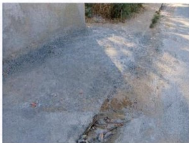
Fotografia 112 – Calçada mal feita
