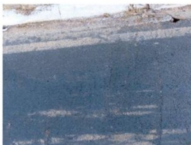
Fotografia 65 – Afundamento e trinca
