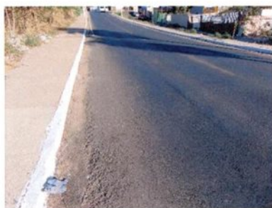
Fotografia 83 – Sarjeta mal feita
