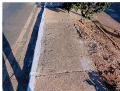
Fotografia 79 – Calçada mal feita
