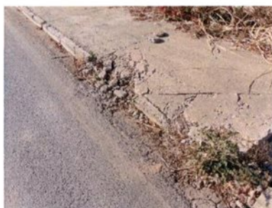
Fotografia 98 – Meio-fio e calçada quebrada
