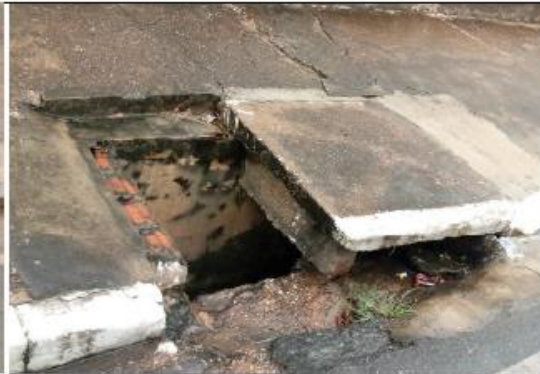
Bueiro sem tampa 15° 35' 28" S e 56° 6' 50" W
