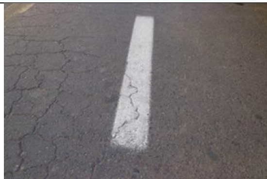
Fissura no pavimento asfáltico – trinca tipo "couro de jacaré"
