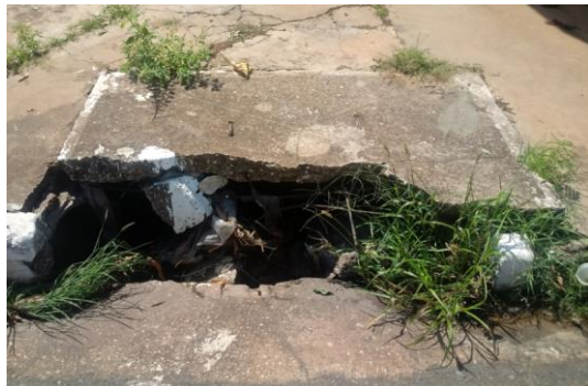
Tampa de bueiro danificada 15° 36' 55" S e 56° 7' 22" W
