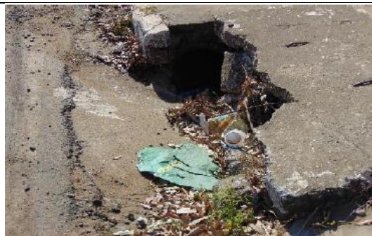
Tampa de bueiro danificada
