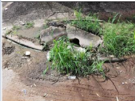
Tampa de bueiro danificada 15° 35' 50" S e 56° 6' 48" W
