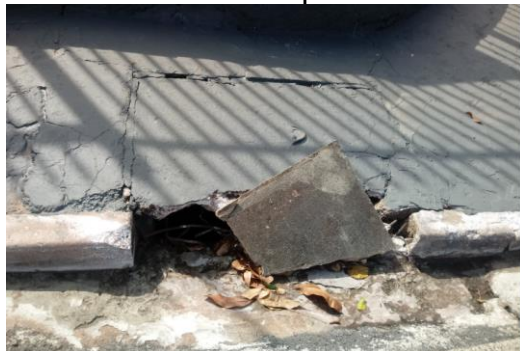
Tampa de bueiro danificada 15° 35' 44" S e 56° 6' 46" W
