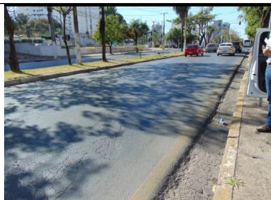
Trincas tipo "couro de jacaré"
