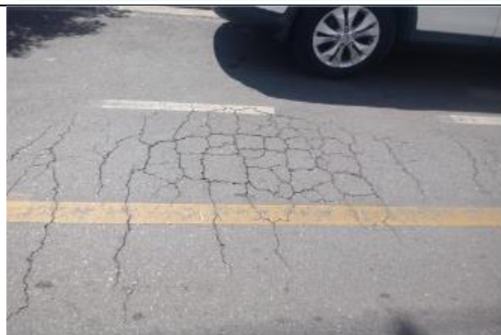
Trinca tipo "couro de jacaré" 15° 35' 40" S e 56° 7' 13" W
