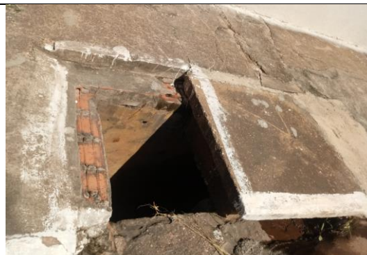
Bueiro sem tampa 15° 35' 28" S e 56° 6' 50" W
