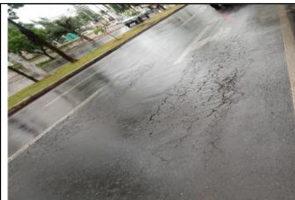
Trincas 15° 35' 40" S e 56° 7' 13" W
