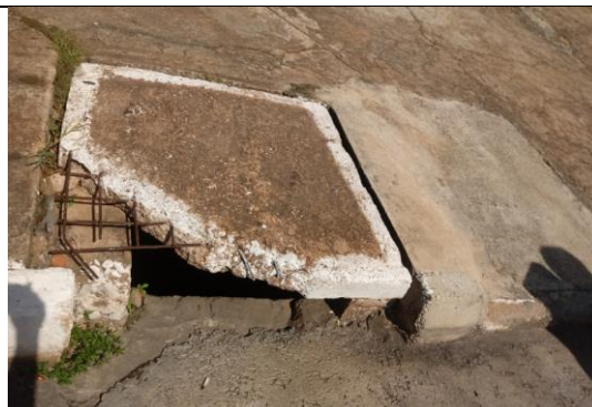
Tampa de bueiro danificada 15° 35' 30" S e 56° 6' 51" W
