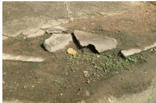
Tampa de bueiro danificada 15° 35' 50" S e 56° 6' 48" W
