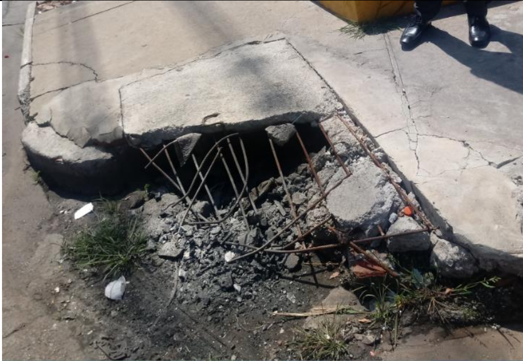
Tampa de bueiro danificada 15° 36' 37" S e 56° 7' 19" W
