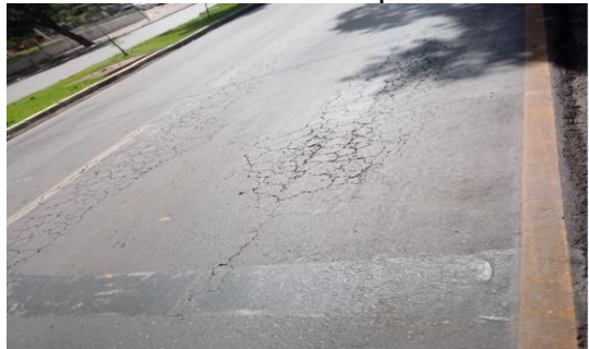
Trincas 15° 35' 40" S e 56° 7' 13" W
