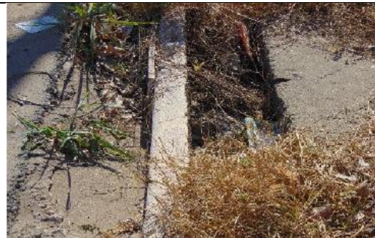
Tampa de bueiro danificada
