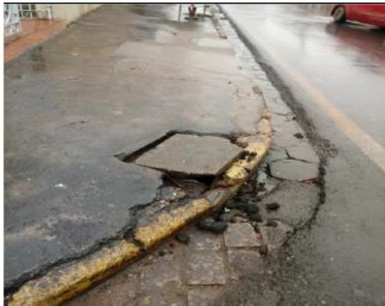
Tampa de bueiro danificada 15° 36' 11" S e 56° 5' 58" W
