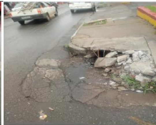
Tampa de bueiro danificada 15° 36' 37" S e 56° 7' 19" W
