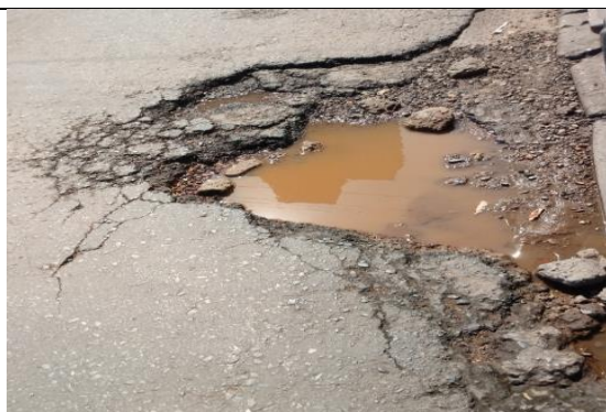
Panela ou buraco e trinca transversal 15° 35' 40" S e 56° 7' 13" W
