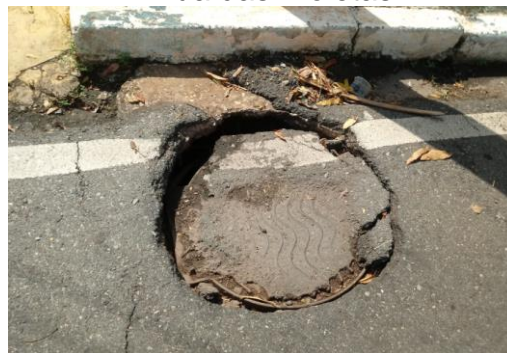
Panela ou buraco e trinca transversal 15° 35' 56" S e 56° 7' 8" W
