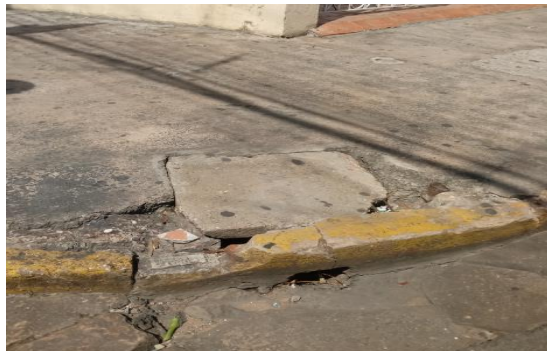
Tampa de bueiro danificada 15° 36' 11" S e 56° 5' 58" W
