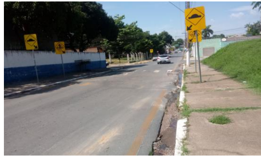
Afundamento e escorregamento de massa 15° 36' 13" S e 56° 6' 52" W
