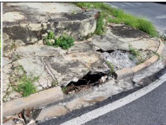
Tampa de bueiro danificada 15° 35' 44" S e 56° 6' 46" W
