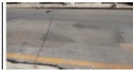
Remendo, afundamento e segregação do pavimento 15° 36' 38" S e 56° 7' 10" W
