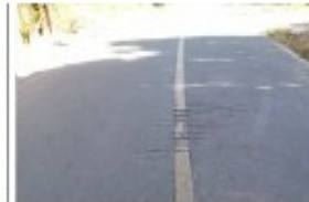
Trincas 15° 36' 7" S e 50° 7' 6" W
