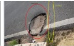
Panela ou buraco e trinca transversal 15° 35' 56" S e 56° 7' 8" W
