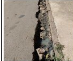
Panela ou buraco 15° 36' 23" S e 56° 7' 22" W
