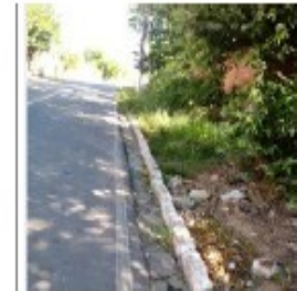
Trincas 15° 36' 8" S e 50° 7' 5" W
