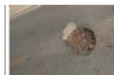
Panela ou buraco 15° 35' 46" S e 56° 7' 11" W
