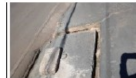
Tampa de bueiro danificada 15° 36' 38" S e 56° 6' 52" W
