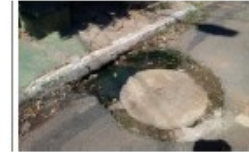
Panela ou buraco 15° 38' 31" S e 58° 8' 30" W
