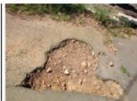
Panela ou buraco 15° 36' 6" S e 50° 6' 59" W
