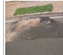
Ondulação, escorregamento de massa e trinca 15° 35' 51" S e 58° 7' 5" W
