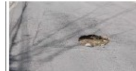
Panela ou buraco 15° 38' 8,35" S e 58° 8' 34" W
