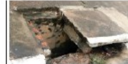
Bueiro sem tampa 15° 35' 28" S e 58° 8' 50" W
