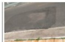
Remendo profundo e afundamento 15° 35' 35" S e 56° 6' 54" W
