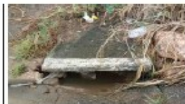
Tampa de bueiro danificada 15° 35' 33" S e 58° 8' 53" W
