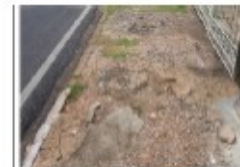
Calçada danificada 15° 35' 53" S e 56° 7' 4" W
