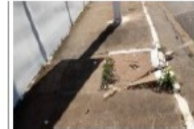
Tampa de bueiro danificada 15° 36' 11" S e 50° 7' 26" W
