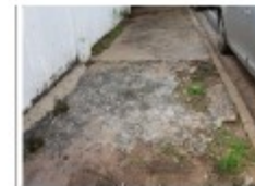
Calçada danificada 15° 35' 48" S e 56° 6' 42" W
