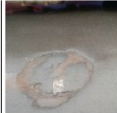
Panela ou buraco 15° 36' 36" S e 56° 8' 12" W
