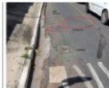
Trincas longitudinais, trincas transversais e afundamento 15° 35' 59" S e 56° 6' 59" W
