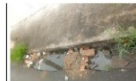
Panela ou buraco 15° 36' 41" S e 56° 7' 3" W
