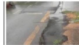
Acúmulo de água na sarjeta 15° 36' 30" S e 56° 0' 15" W
