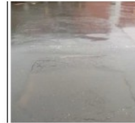
Remendo e trincas 15° 36' 38" S e 56° 6' 13" W
