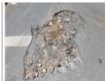
Panela ou buraco 15° 35' 58" S e 56° 6' 59" W
