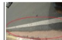
Trincas longitudinais 15° 35' 45" S e 56° 7' 8" W
