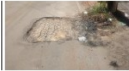
Remendo, afundamento e trinca tipo "couro de jacaré" 15° 38' 41" S e 58° 8' 40" W
