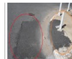
Remendo, afundamento e acesso para PNE's inadequado 15° 35' 55" S e 56° 6' 54" W
