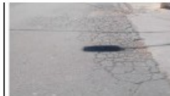
trinca tipo "couro de jacaré" 15° 38' 30" S e 58° 8' 43" W
