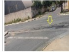
afundamento 15° 35' 42" S e 58° 7' 12" W
