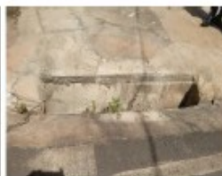
Tampa de "boca de lobo" em desacordo com as Normas Técnicas 15° 35' 44" S e 56° 7' 0.03" W
