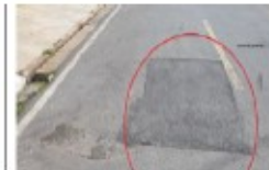
Remendo profundo e segregação 15° 35' 54" S e 56° 7' 6" W
