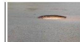
Panela ou buraco 15° 35' 30" S e 58° 8' 56" W
