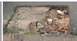
Remendo não executado 15° 35' 33" S e 58° 8' 52" W
