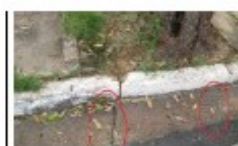
Trincas transversais 15° 35' 37" S e 56° 6' 57" W
