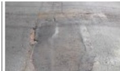
Remendo profundo, trincas e afundamento 15° 36' 28" S e 56° 7' 15" W
