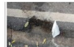
Panela ou buraco 15° 35' 38" S e 56° 6' 52" W
