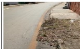
Trinca, panela ou buraco e calçada destruída 15° 36' 0,4" S e 56° 6' 40,54" W
