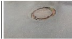
Panela ou buraco 15° 35' 30" S e 58° 8' 51" W
