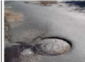
Remendo e afundamento plástico 15° 38' 13" S e 50° 7' 27" W
