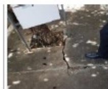
Rachadura transversal e longitudinal 15° 35' 59" S e 56° 6' 59" W
