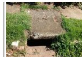
Tampa de bueiro danificada 15° 36' 6" S e 50° 6' 59" W
