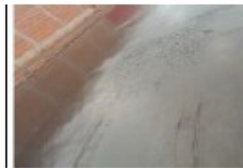
Trincas diagonais 15° 36' 37" S e 56° 8' 14" W
