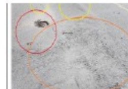
Panela ou buraco, trinca longitudinal, remendo e segregação 15° 35' 46" S e 56° 6' 49" W
