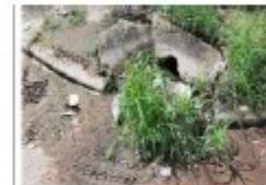
Tampa de bueiro danificada 15° 35' 50" S e 56° 6' 48" W
