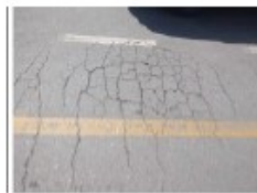
Trinca tipo "couro de jacaré" 15° 35' 40" S e 58° 7' 13" W
