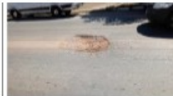
Panela ou buraco e trincas 15° 36' 27" S e 56° 7' 9" W
