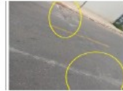
Panela ou buraco e trinca transversal 15° 35' 43" S e 56° 7' 11" W
