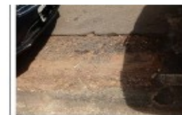
Panela ou buraco 15° 35' 32" S e 56° 7' 3" W
