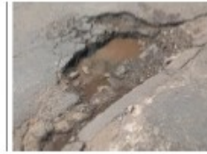
Panela ou buraco 15° 35' 40" S e 58° 7' 13" W
