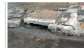
Tampa de bueiro danificada 15° 35' 5" S e 58° 8' 38" W
