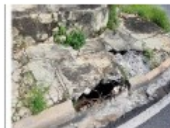
Tampa de bueiro danificada 15° 35' 44" S e 56° 6' 46" W
