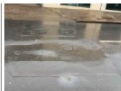
Remendo, ondulação e escorregamento de massa 15° 38' 11" S e 58° 5' 58" W
