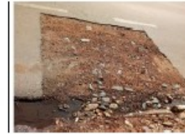
Remendo não executado 15° 36' 27" S e 56° 7' 8" W
