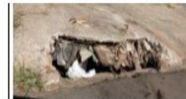
Tampa de bueiro danificada 15° 36' 31" S e 56° 7' 0,62" W
