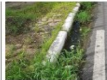
Acúmulo de água na sarjeta e na pista de rolamento 15° 35' 56" S e 56° 7' 8" W
