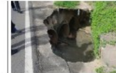
Patologias na drenagem 15° 35' 49" S e 56° 6' 60" W
