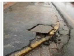
Tampa de bueiro danificada 15° 38' 11" S e 58° 5' 58" W
