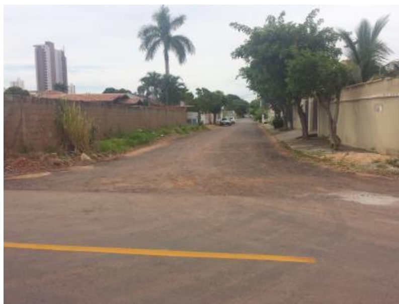
Limpa rodas ainda não executado trazendo danos à imprimação – Rua dos Crisântemos
