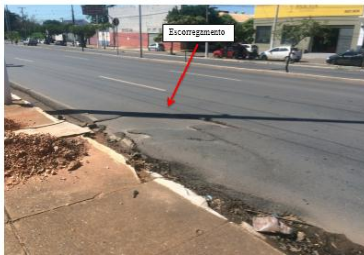
Figura 10 - Pavimentação - Patologia no pavimento - Escorregamento
