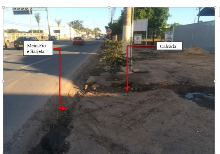
Figura 12 - Obras Complementares - Serviços não executados - Calçada e Meio-Fio.
