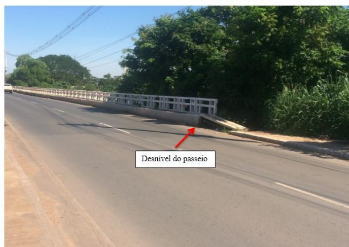
Figura 11 - Obras Complementares - Serviços não executados - Passeio.
