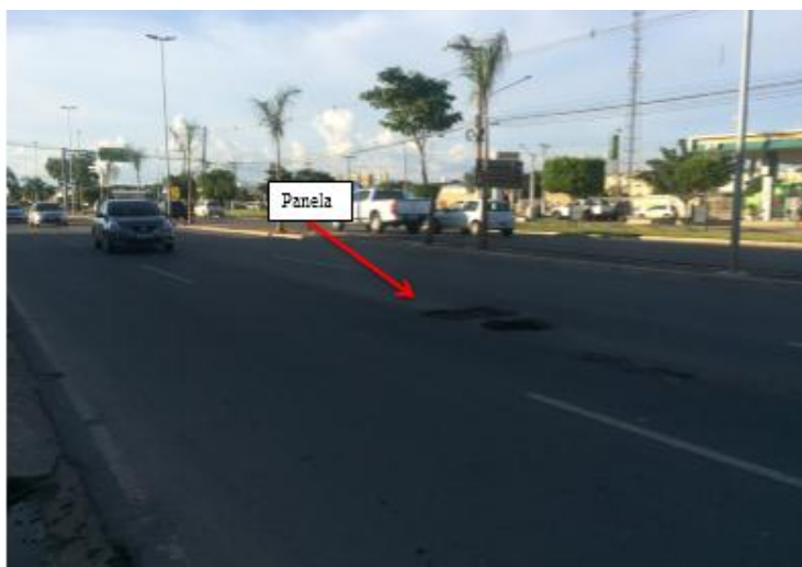
Figura 9 Pavimentação - Patologia no pavimento - Panela
