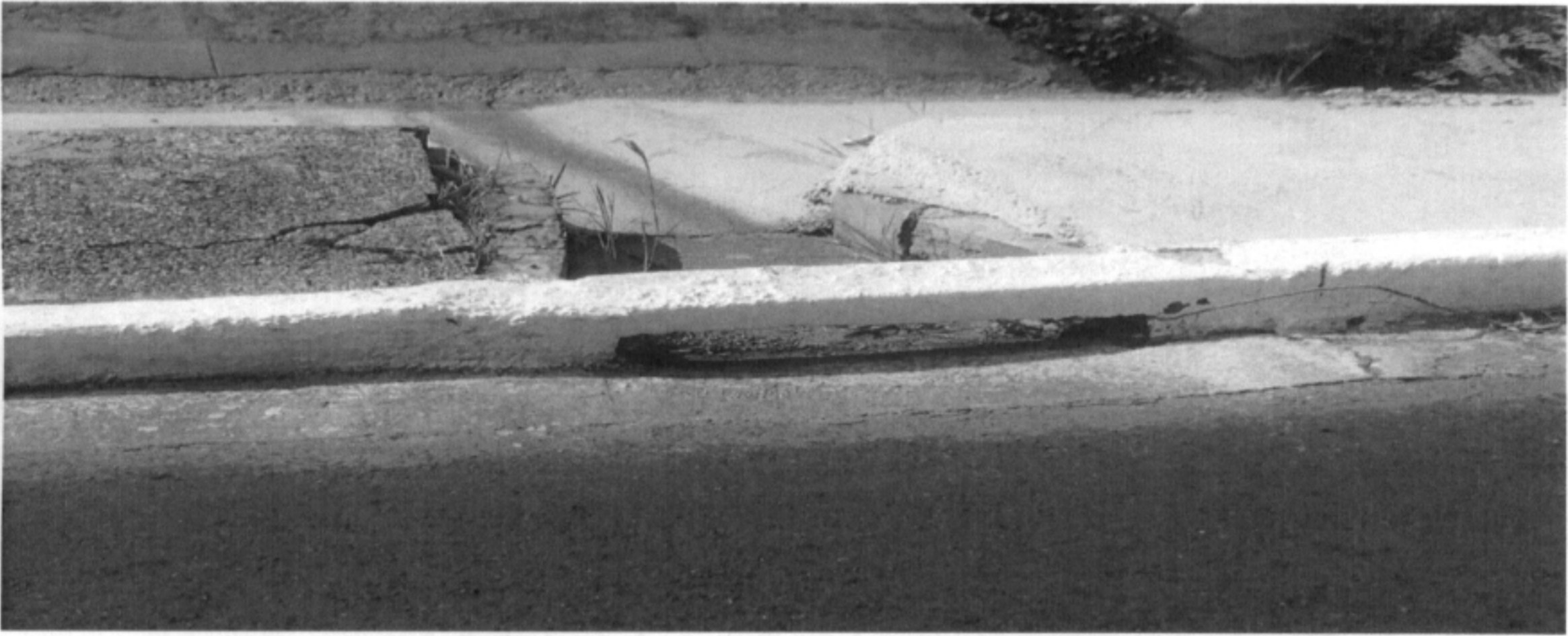
Figura 06: Descida de água sem tampa.
