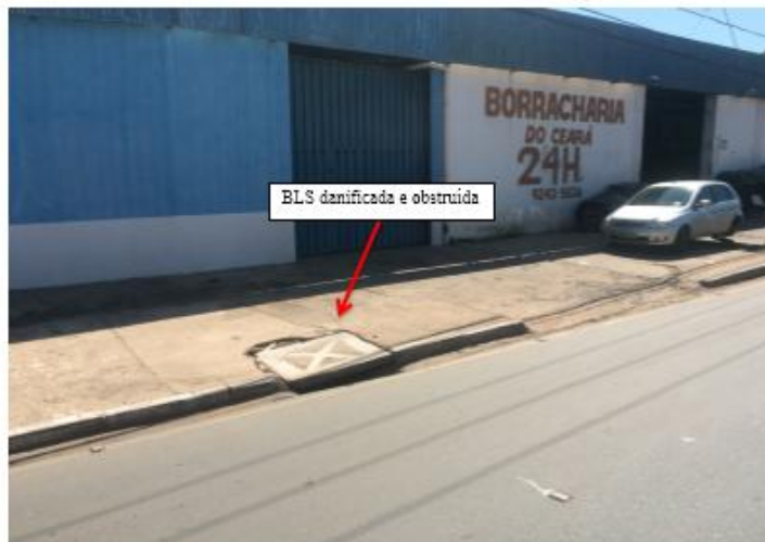
Figura 8 - Drenagem - Boca de Lobo danificada e obstruída.
