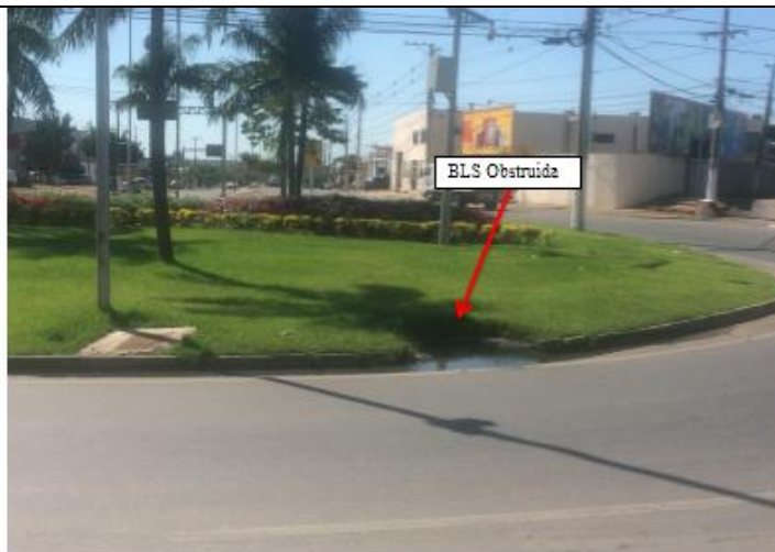
Figura 7 - Drenagem - Boca de Lobo obstruída Rotatória do Coopfamul .
