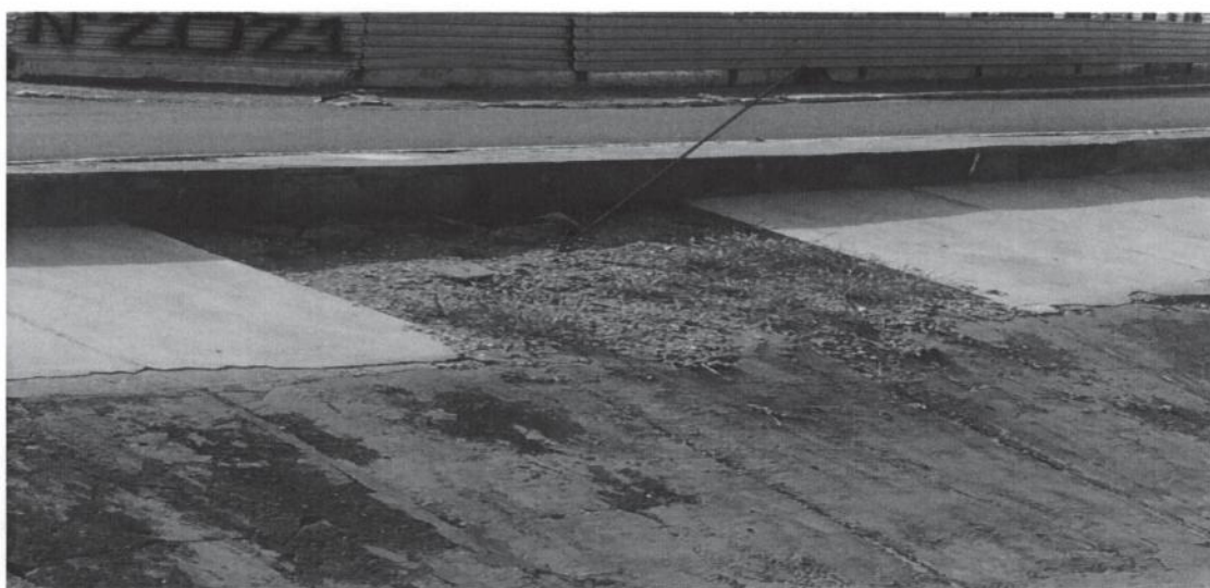
Figura 12: Serviço não executado – Concretagem.
