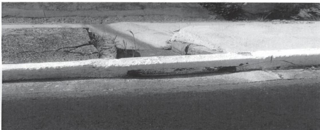
Figura 06: Descida de água sem tampa.
