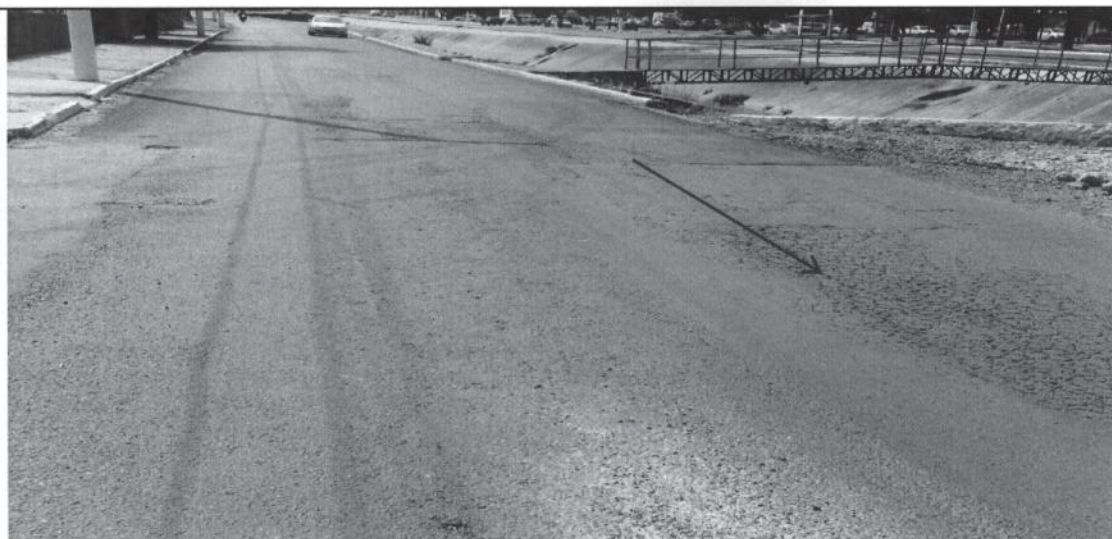
Figura 35: Pavimento em desconformidade – couro de jacaré.
