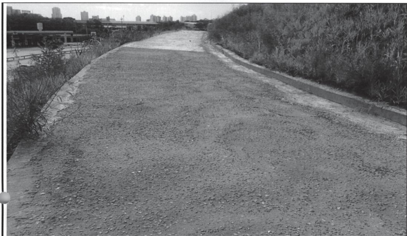
Foto 03 – Patamar central com concreto em desconformidade com a norma DNIT e projeto executivo.
