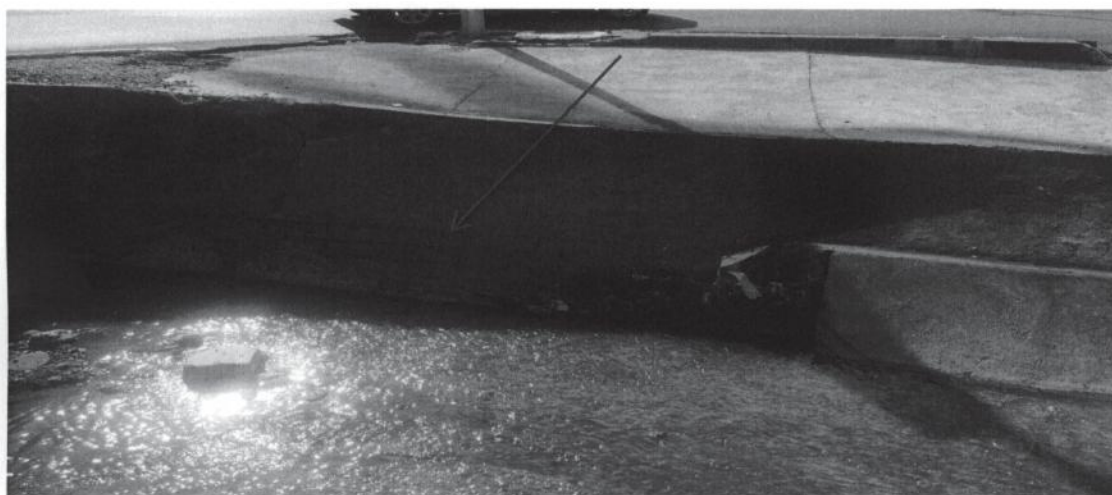
Figura 11: Conclusão da concretagem - armadura exposta.
