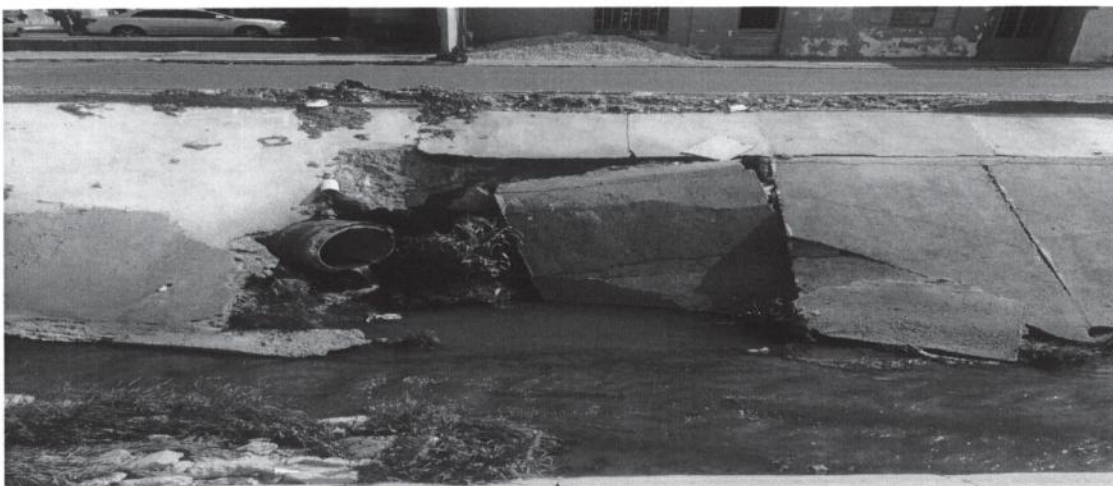
Figura 13: Serviço em desconformidade com o projeto.
