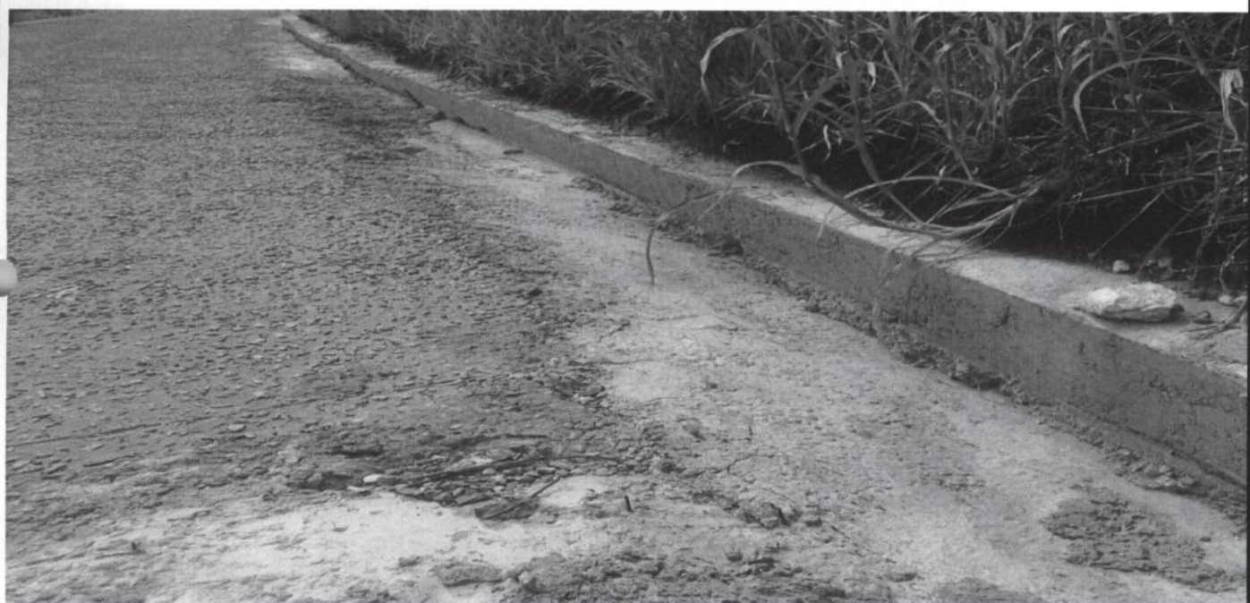
Foto 04 – Valeta de proteção de corte em desconformidade com o projeto executivo.
