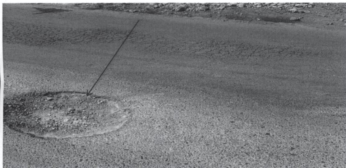
Figura 36: Pavimento em desconformidade – Panela.
