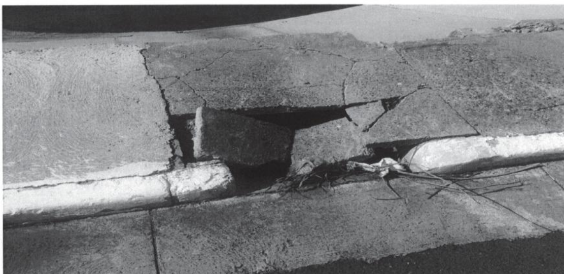
Figura 08: Tampa de passagem danificada.
