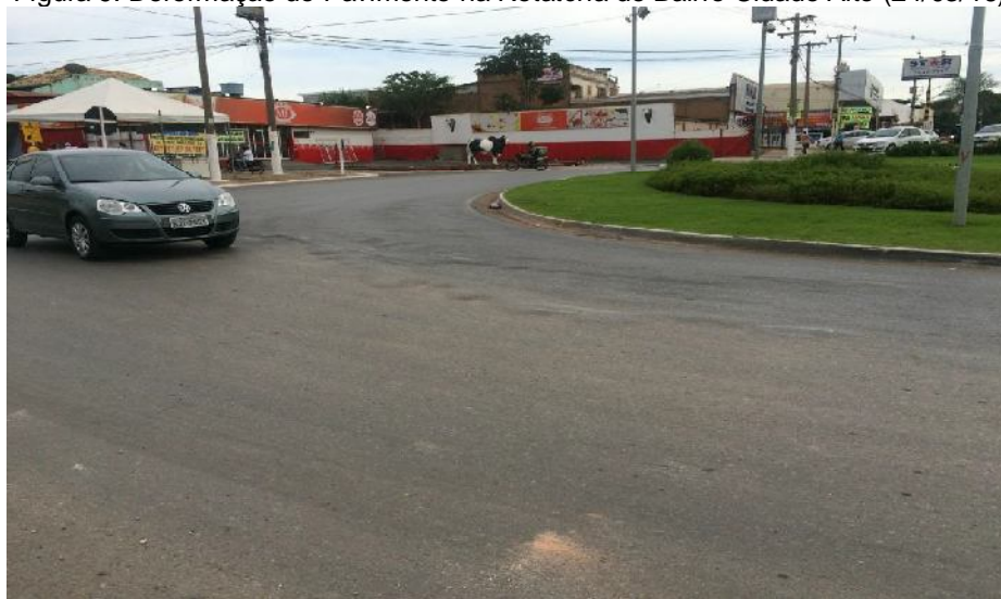
Figura 9: Deformação do Pavimento na Rotatória do Bairro Cidade Alto (24/03/16)
