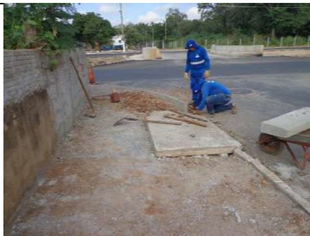
Fig. 10 - Retirada do meio-fio para realinhamento e troca dos que estão danificados na Joaquim Murтинho
