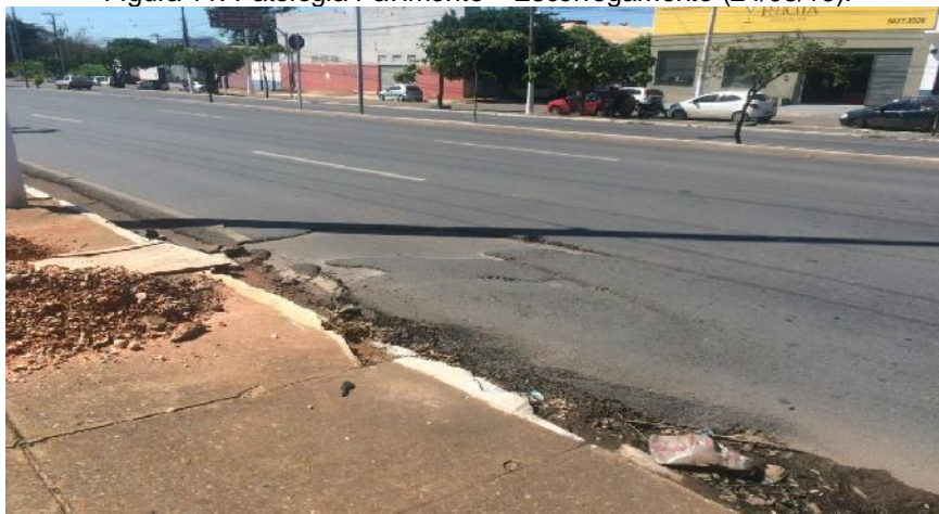
Figura 11: Patologia Pavimento – Escorregamento (24/03/16).
