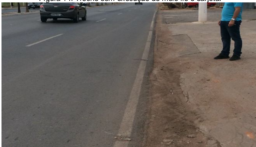
Figura 14: Trecho sem execução de meio fio e sarjeta.
