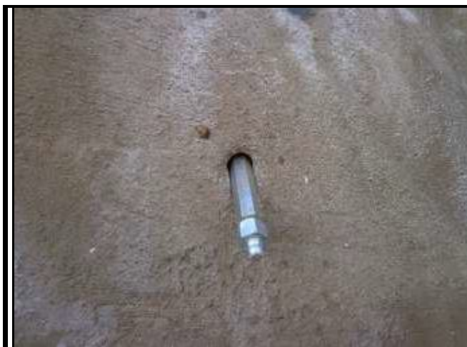
Fig. 3 - Bicos injetores já fixados, aguardando o PU para ser injetado
