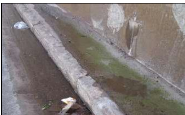
Fig. 11 - Água proveniente do aterro que encosta na parede da trincheira
