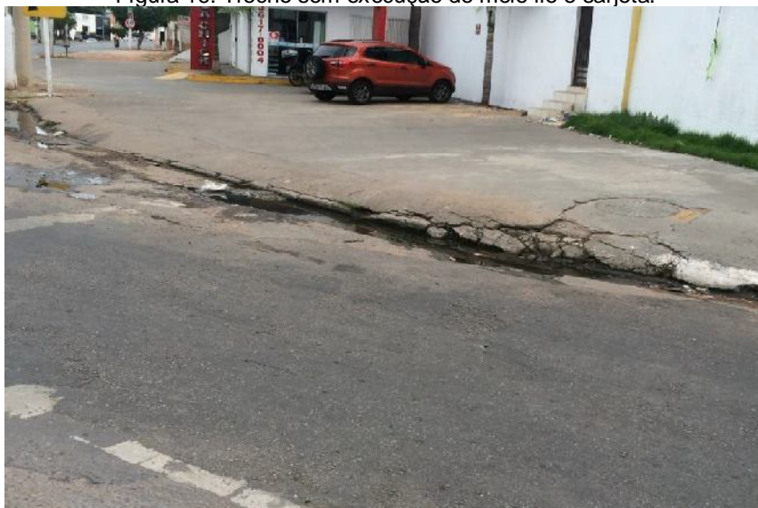
Figura 16: Trecho sem execução de meio fio e sarjeta.
