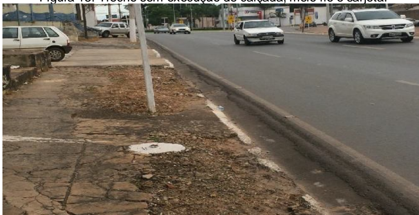
Figura 15: Trecho sem execução de calçada, meio fio e sarjeta.
