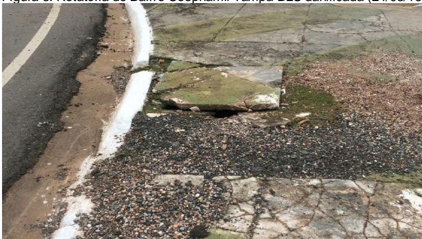
Figura 3: Rotatória do Bairro Coophamil Tampa BLS danificada (24/03/16)
