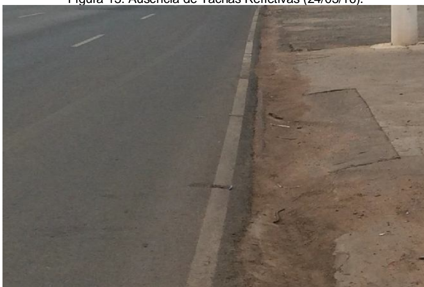
Figura 13: Ausência de Tachas Refletivas (24/03/16).
