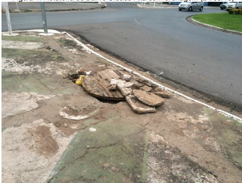
Figura 1: Rotatória do Bairro Cidade Alta sem drenagem (24/03/16)
