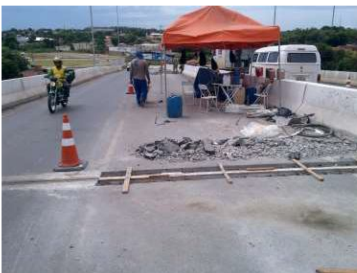
Foto 5.05 – Execução da forma e posicionamento de placa provisória de EPS para grauteamento.
