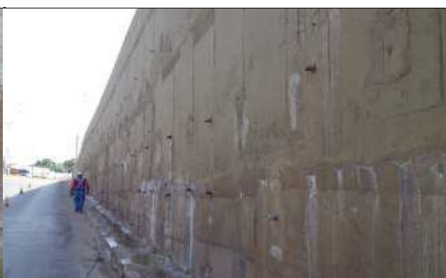
Fig. 12 - Parede da trincheira, onde irá fazer a injeção de PU para conter as infiltrações
