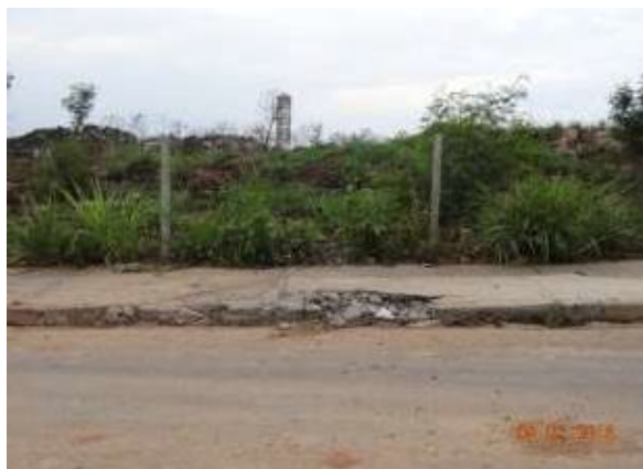
Fig. 28 - Boca de lobo danificada;
