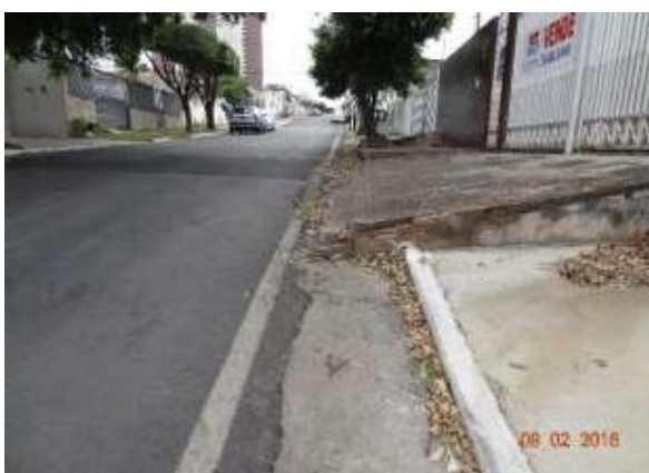
Fig. 32 - Rampa de acesso invadindo a sarjeta;
