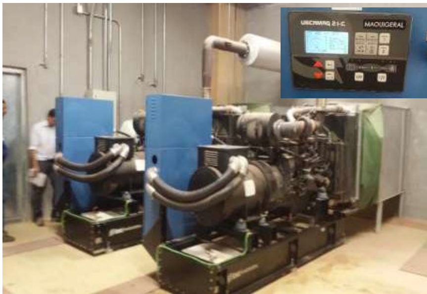
Figura 8.8 – Grupos geradores instalados na sala de Geradores da subestação 02, localizada no nível 00 da Arena.
