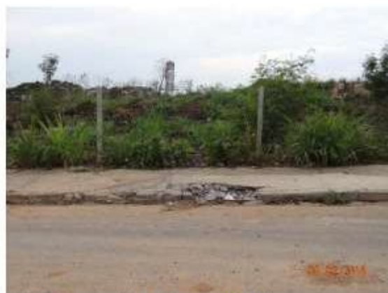
Fig. 28 - Boca de lobo danificada; (ANTES)
