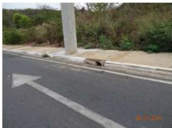
Fig. 10 - Guia chepêu danificada; (ANTES)
