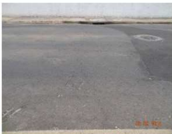
Fig. 18 - Trinca na capa asfáltica; (ANTES)
