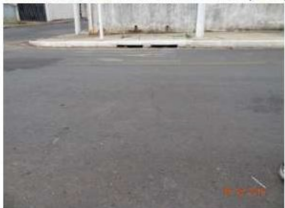
Fig. 2 - Trinca na capa asfáltica; (ANTES)
