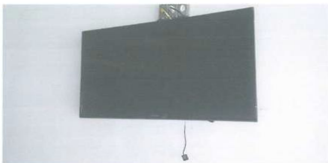
Dispositivo IR (Infravermelho) danificado – Televisor do Sistema Digital Signage – Nível 30, Setor Oeste, Circulação de público.
