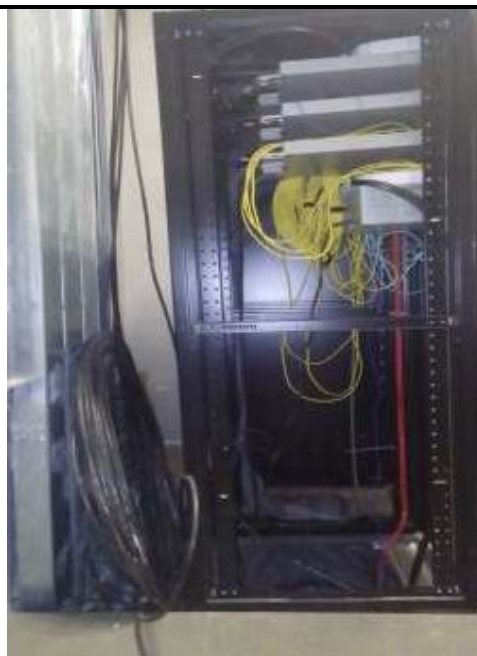
Registro 1. Rack metálico sem o fechamento com a tampa própria. Sujeito à poeira e umidade.
