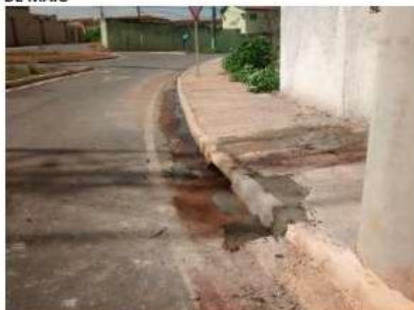
Fig. 9 - Meio fio não conforme, Sarjeta trincada; (DEPOIS)
