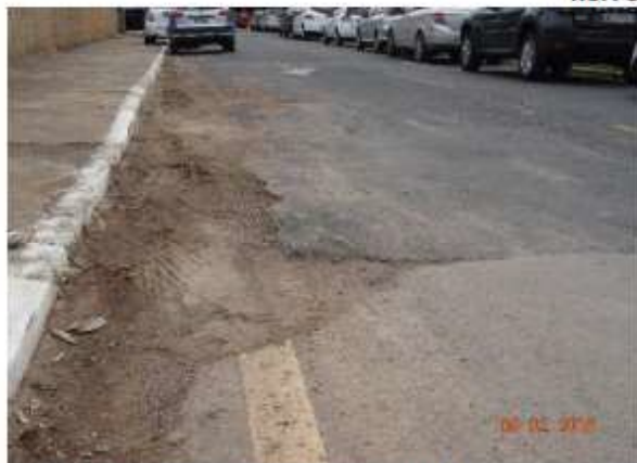
Fig. 7 - Pavimento com patologias. (ANTES)
