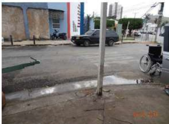
Fig. 6 - Boca de lobo e Poço de Visita não executados; (ANTES)
