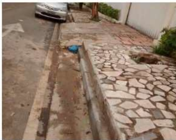
Fig. 3 - Meio fio não executado, rampa de acesso avançando sobre a sarjeta; (DEPOIS)
