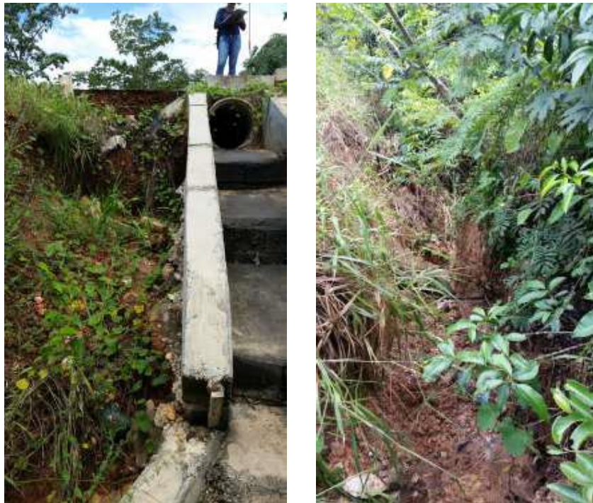
Figuras 9 e 10 – Desbarrancamento da encosta da pista pela ação de água da chuva ao lado do canal para captação de água pluvial
