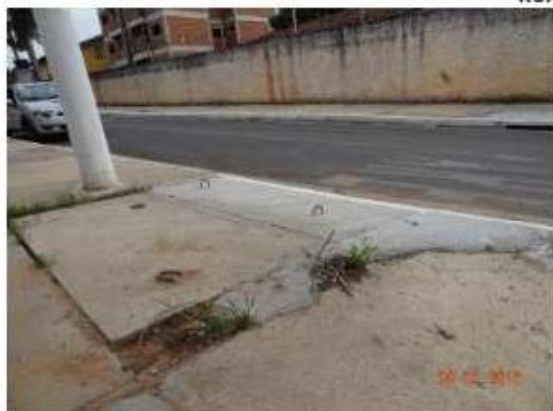
Fig. 1 - Falta acabamento da calçada, concretagem sobre material orgânico, alças da tampa estão salientes; (ANTES)
