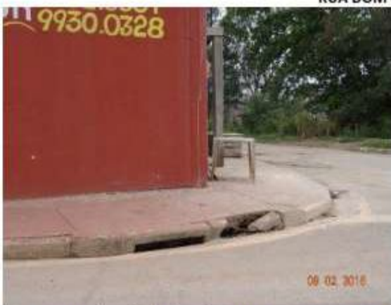
Fig. 19 - Guia chapéu danificada; (ANTES)
