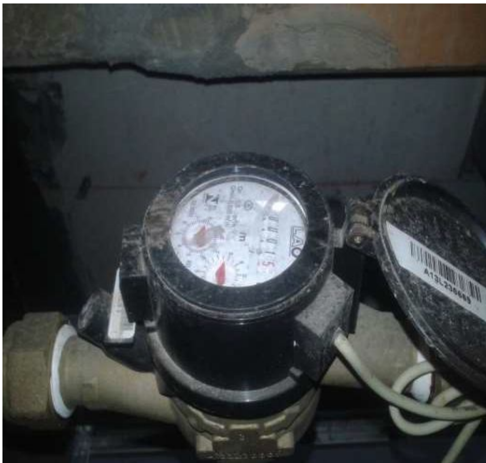
Figura 8.2 Medidor de consumo de água (hidrômetro) instalado sobre o forro de restaurante
