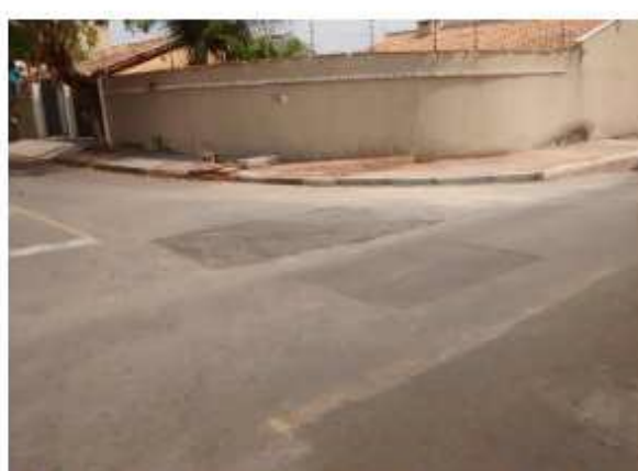
Fig. 8 - Borrachudo na esquina com a Rua das Margaridas, meio fio não executado. (DEPOIS)
