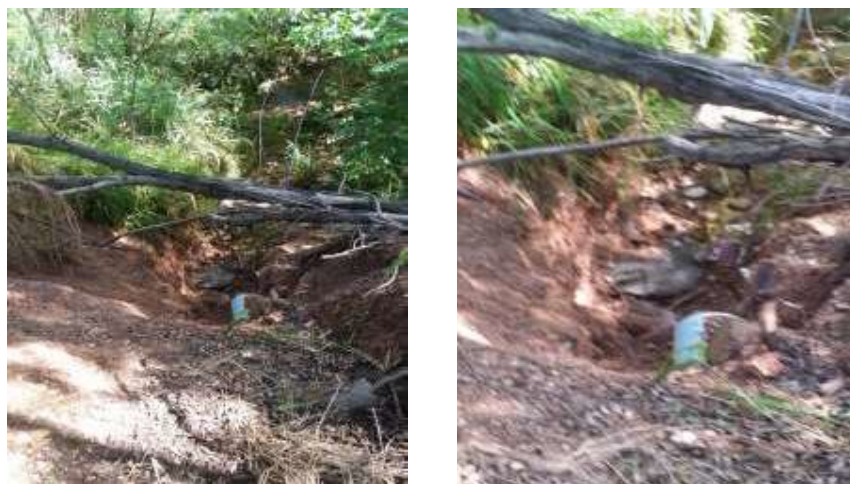
Figuras 3 e 4 – Vista da tubulação de água pluvial instalada na lateral acima da caixa de concreto.
