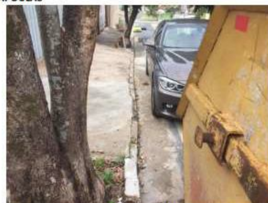
Fig. 29 - Sarjeta danificada; (DEPOIS)
