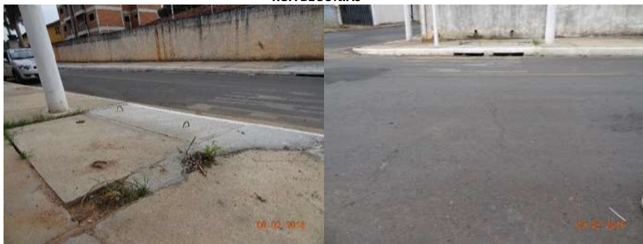
Fig. 1 - Falta acabamento da calçada, concretagem sobre material orgânico, alças da tampa estão salientes;
