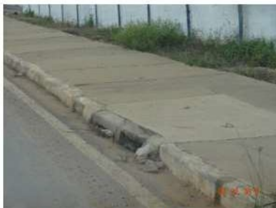
Fig. 27 - Guia chapéu danificada; (ANTES)
