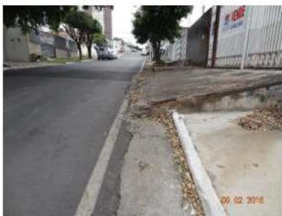
Fig. 32 - Rampa de acesso invadindo a sarjeta; (ANTES)
