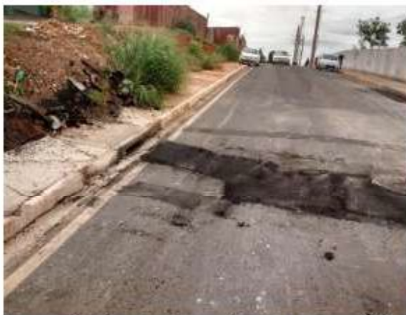
Fig. 15 - Afundamento de meio fio, trinca na capa asfáltica; (DEPOIS)
