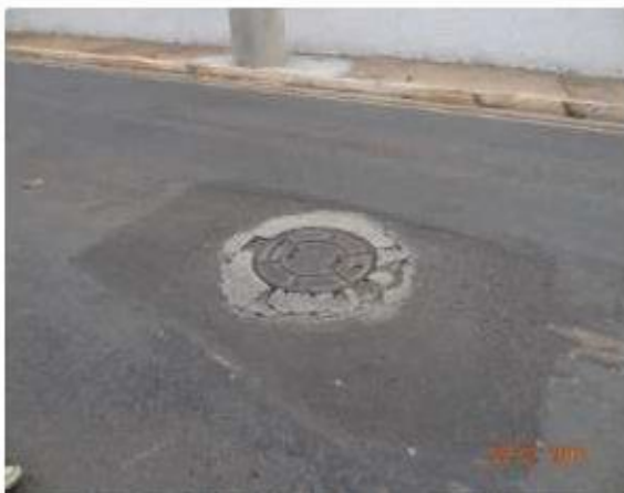
Fig. 12 - Acabamento do Poço de Visita com deterioração precoce; (ANTES)
