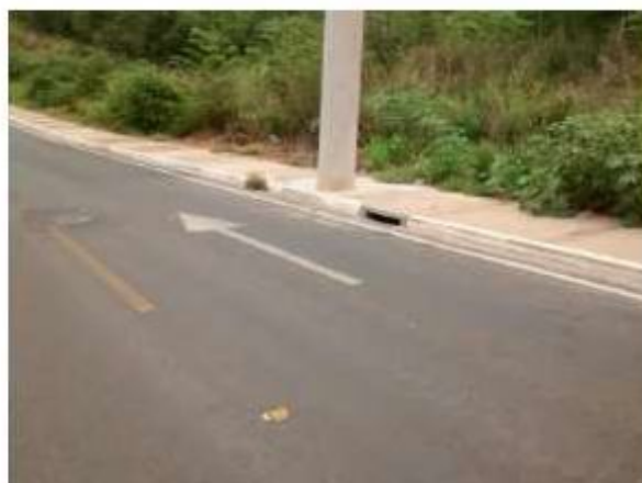
Fig. 10 - Guia chepêu danificada; (DEPOIS)
