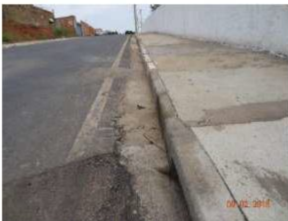
Fig. 16 - Sarjeta trincada; (ANTES)
