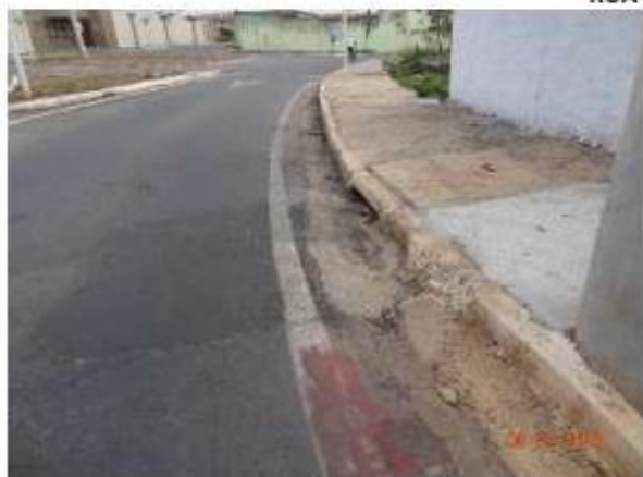
Fig. 9 - Meio fio não conforme, Sarjeta trincada; (ANTES)
