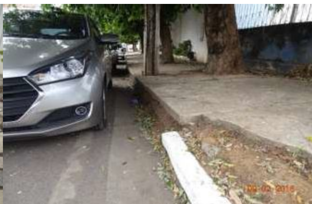
Fig. 4 - Meio fio não executado;
