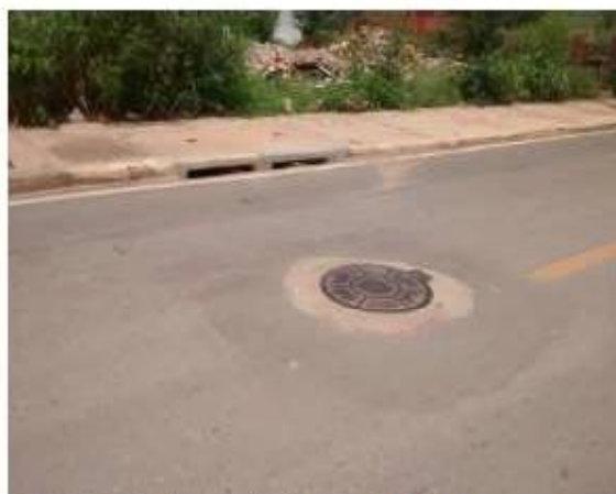
Fig. 22 - Guia chapéu danificada; (DEPOIS)
