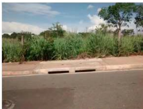
Fig. 28 - Boca de lobo danificada; (DEPOIS)
