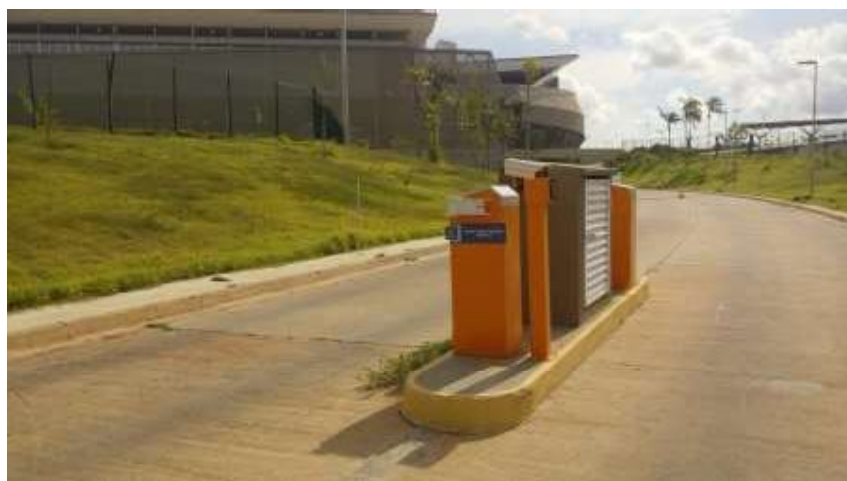
Registro 5. Cancela de acesso ao estacionamento interno pelo túnel do setor leste. Falta conclusão por meio da instalação dos braços.
