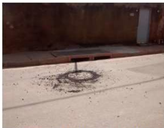
Fig. 20 - Poço de visita com pescoço danificado; (DEPOIS)
