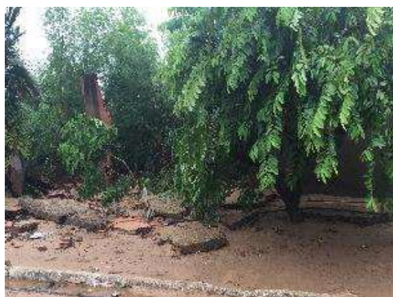
Fig. 06 Muro da rua Ottawa que desabou.
