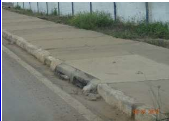
Fig. 27 - Guia chapéu danificada;
