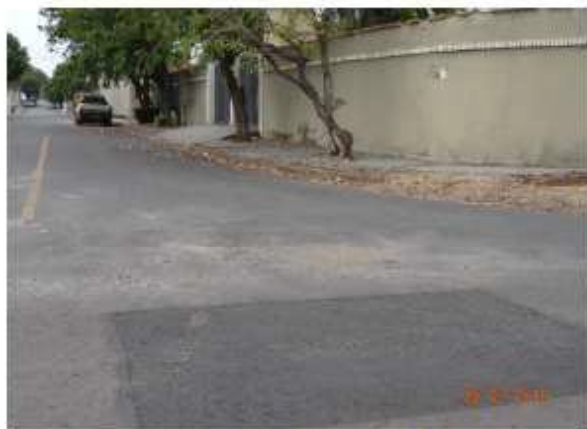
Fig. 8 - Borrachudo na esquina com a Rua das Margaridas, meio fio não executado. (ANTES)
