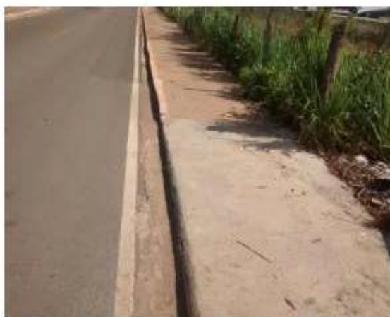
Fig. 25 - Sarjeta executada em desacordo com as especificações de projeto; (DEPOIS)
