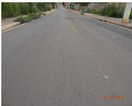
Fig. 24 - Trinca na capa asfáltica; (ANTES)
