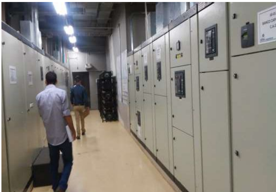
Figura 8.7 - Painéis de Baixa Tensão instalados na sala de painéis da subestação 02, localizada no nível 00 da Arena.
