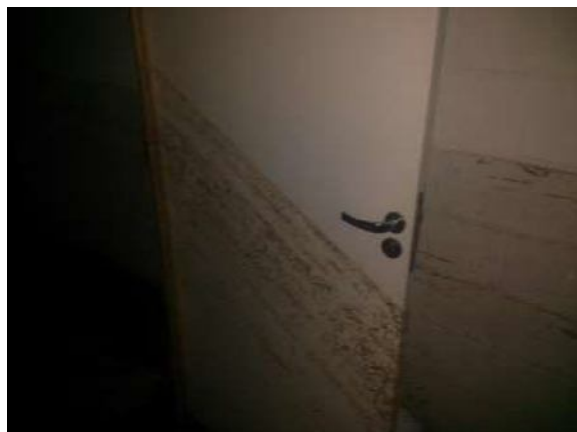
Fig. 02 – Portas de madeira danificadas pela água.
