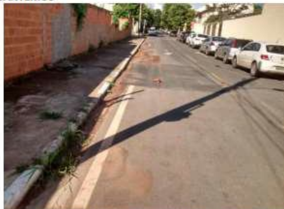
Fig. 7 - Pavimento com patologias. (DEPOIS)
