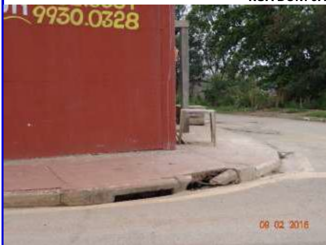
Fig. 19 - Guia chapéu danificada;
