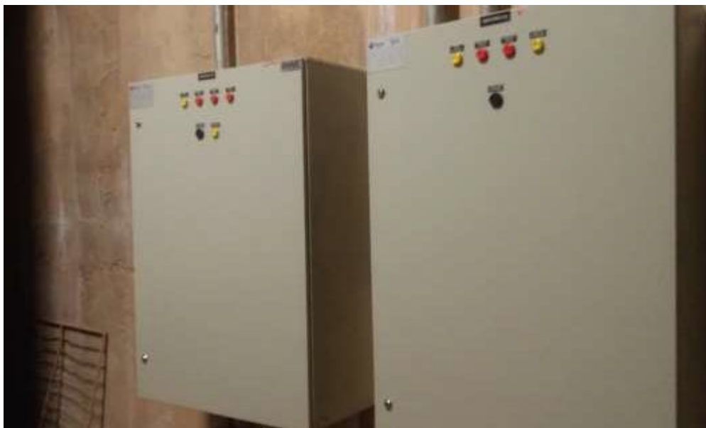
Figura 8.4 - Quadro de comando de bombas de água potável instalado em parede no nível 00 que recalca para os reservatórios superiores
