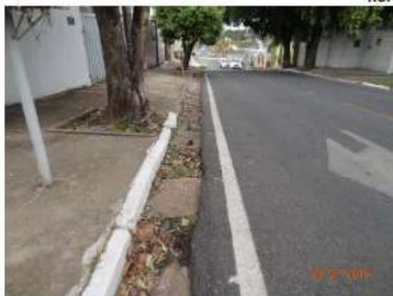
Fig. 29 - Sarjeta danificada; (ANTES)
