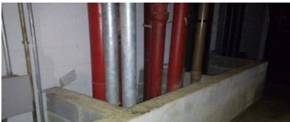
Registro 2. Shaft dentro de sala técnica utilizado para tubulações de hidráulica aberto, sem vedação apropriada a evitar perda de climatização e entrada de poeira.
