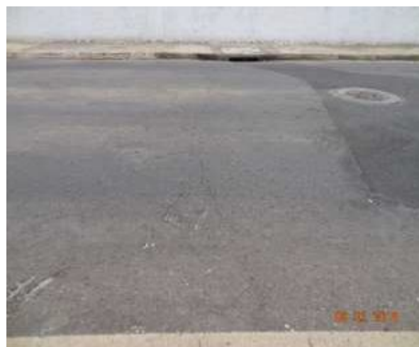
Fig. 18 - Trinca na capa asfáltica;
