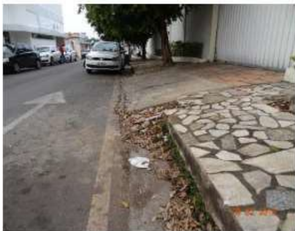
Fig. 3 - Meio fio não executado, rampa de acesso avançando sobre a sarjeta; (ANTES)
