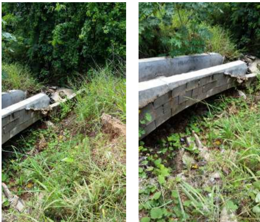
Figuras 11 e 12- Canal de captação de água da chuva do lado do córrego do Moinho sem base de solo, pois está sendo levado pela água da chuva de desce da encosta da via.
