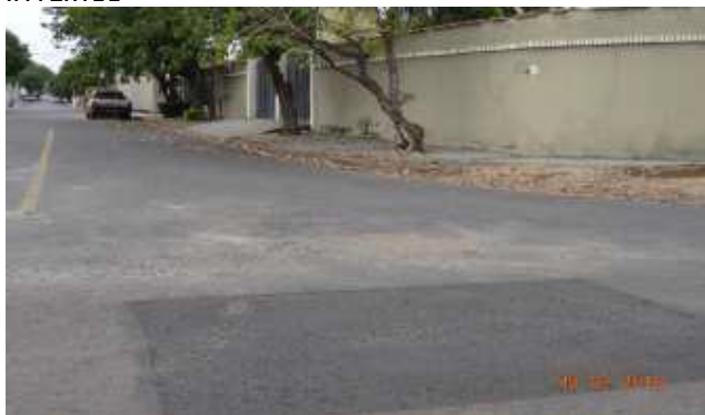
Fig. 8 - Borrachudo na esquina com a Rua das Margaridas, meio fio não executado.
