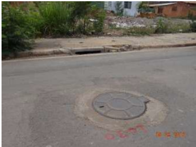
Fig. 22 - Guia chapéu danificada;
