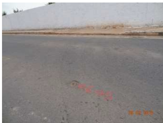
Fig. 17 - Trinca na capa asfáltica;
