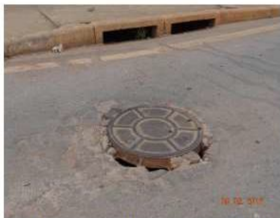
Fig. 20 - Poço de visita com pescoço danificado; (ANTES)
