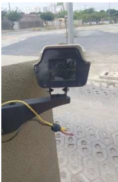
Registro 1. Câmera destinada à captação de imagens nas cancelas da entrada do estacionamento do setor sul faltando parte interna, apenas carcaça instalada.
