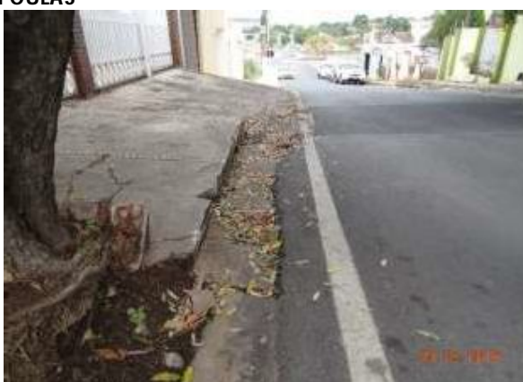
Fig. 30 - Meio fio não executado e sarjeta danificada;
