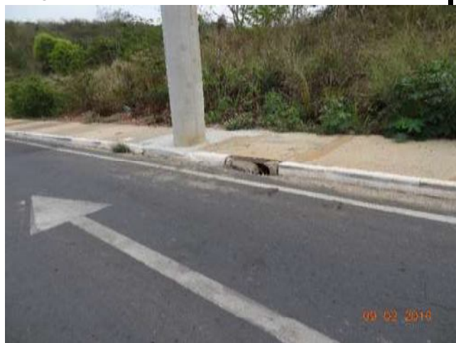
Fig. 10 - Guia chapéu danificada;
