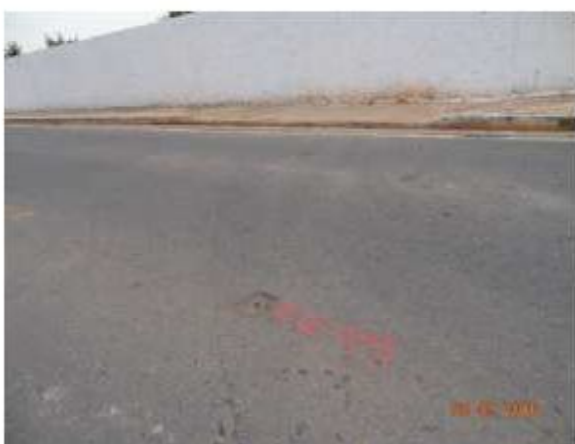
Fig. 17 - Trinca na capa asfáltica; (ANTES)
