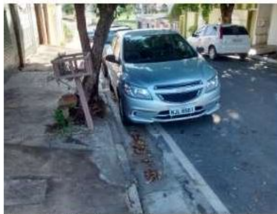
Fig. 30 - Meio fio não executado e sarjeta danificada; (DEPOIS)
