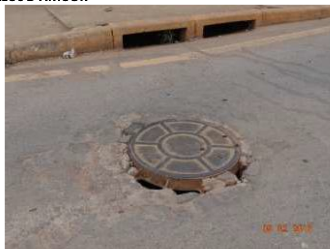
Fig. 20 - Poço de visita com pescoço danificado;
