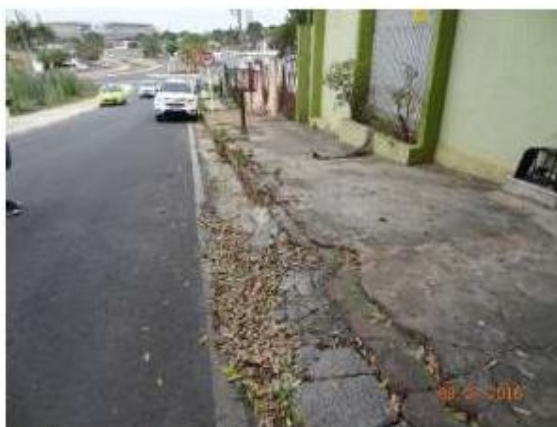
Fig. 31 - Meio fio e sarjeta danificados; (ANTES)
