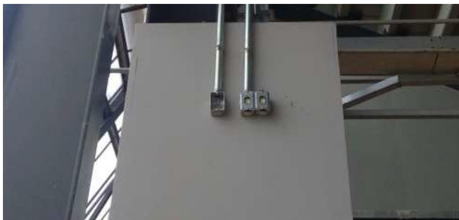
Registro 4. Setor Norte, Nível 40. Televisor e ponto lógico (rede) não instalados.
