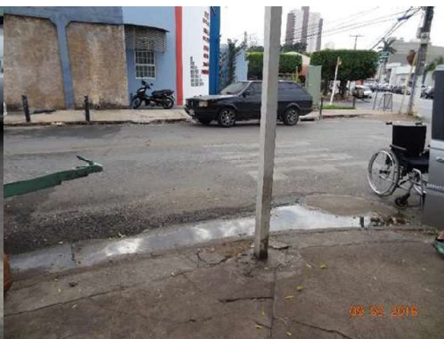
Fig. 6 - Boca de lobo e Poço de Visita não executados;
