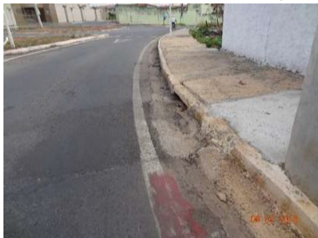
Fig. 9 - Meio fio não conforme, Sarjeta trincada;
