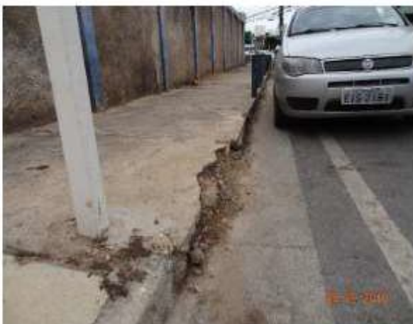
Fig. 5 - Meio fio não executado; (ANTES)
