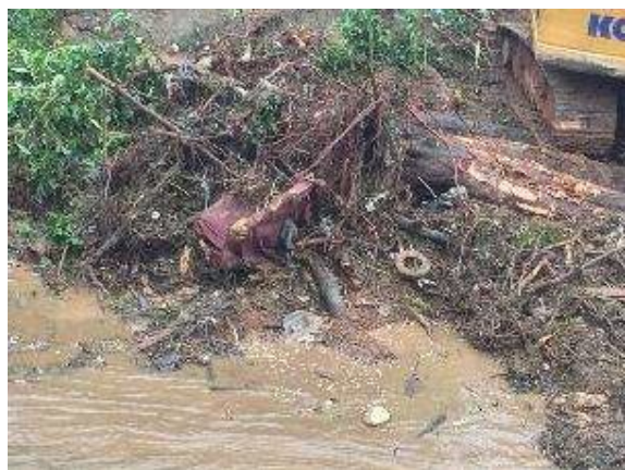
Fig. 04 Obstrução do canal do córrego.
