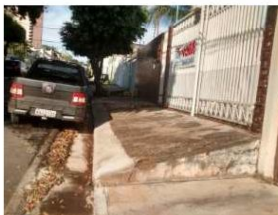
Fig. 32 - Rampa de acesso invadindo a sarjeta; (DEPOIS)
