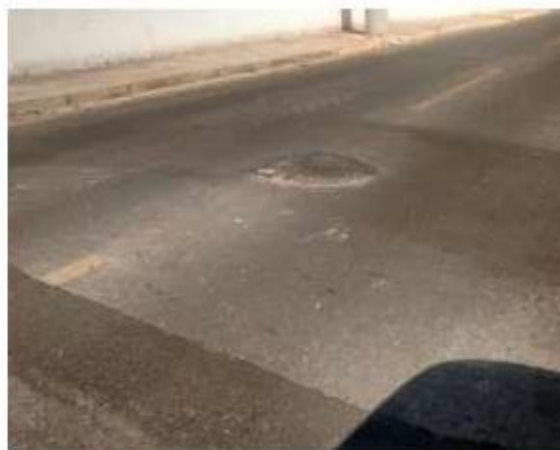
Fig. 12 - Acabamento do Poço de Visita com deterioração precoce; (DEPOIS)
