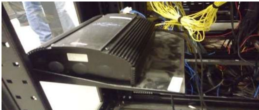
Registro 3. Equipamento ativo empoeirado.
