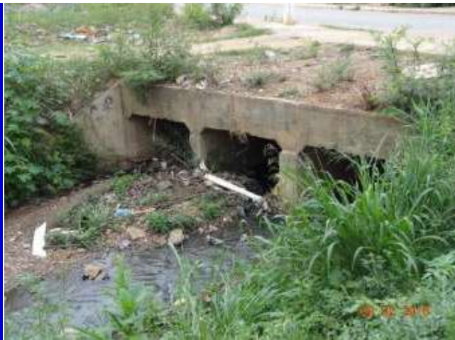
Fig. 21 - Bueiro celular triplo obstruído;
