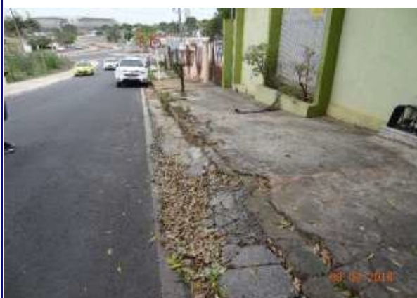
Fig. 31 - Meio fio e sarjeta danificados;
