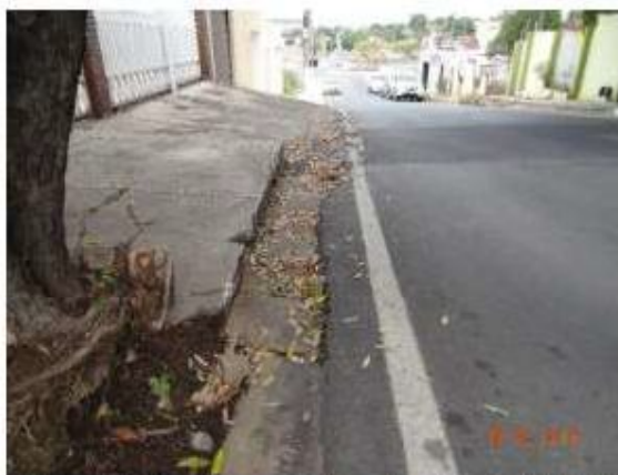
Fig. 30 - Meio fio não executado e sarjeta danificada; (ANTES)
