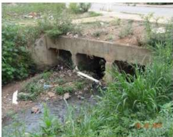
Fig. 21 - Bueiro celular triplo obstruído; (ANTES)
