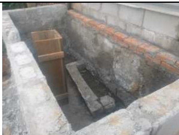
Fig. 06 – Boca de lobo sem tampa e reboco interno.
