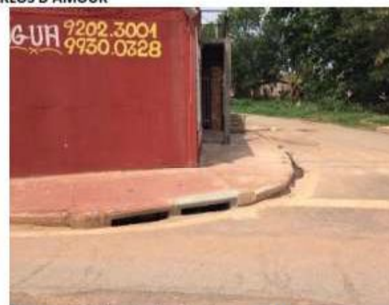
Fig. 19 - Guia chapéu danificada; (DEPOIS)
