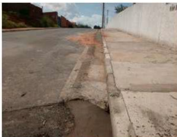
Fig. 16 - Sarjeta trincada; (DEPOIS)
