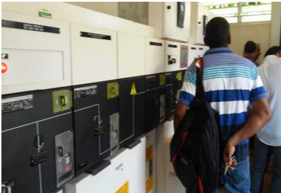
Figura 8.6 - Painéis de Média Tensão – cubículos de entrada de energia da concessionária na área externa.
