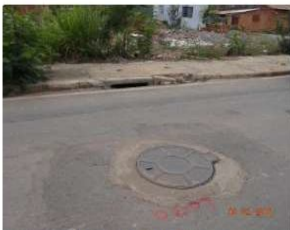
Fig. 22 - Guia chapéu danificada; (ANTES)
