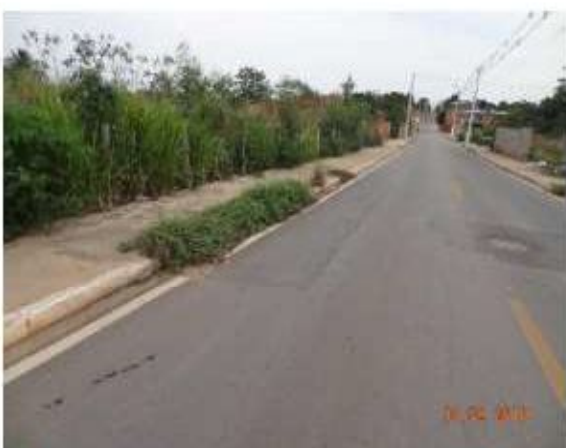
Fig. 23 - Boca de lobo obstruída; (ANTES)
