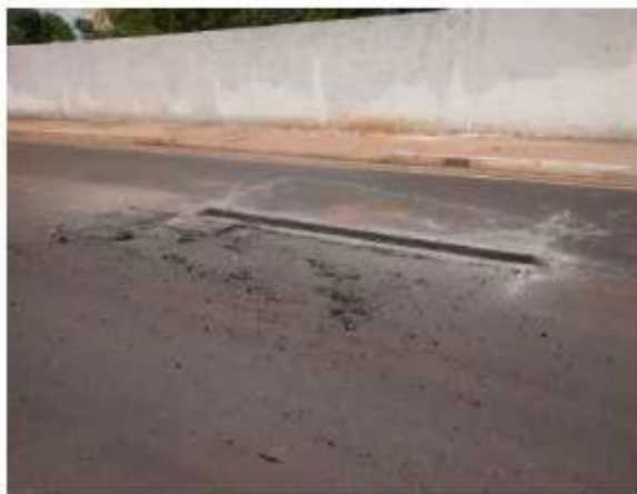
Fig. 17 - Trinca na capa asfáltica; (DEPOIS)
