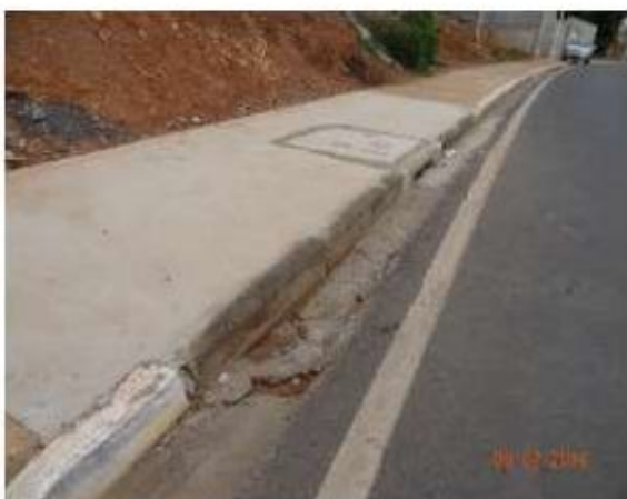
Fig. 13 - Sarjeta executada em desacordo com as especificações de projeto; (ANTES)
