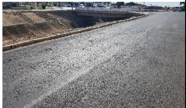
Estaca: 25 Não conformidade: Afundamento / Trincas
