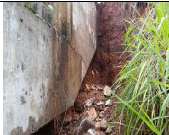
Figura 3 - Detalhe erosão cabeceira da ponte do Rio Moinho.
