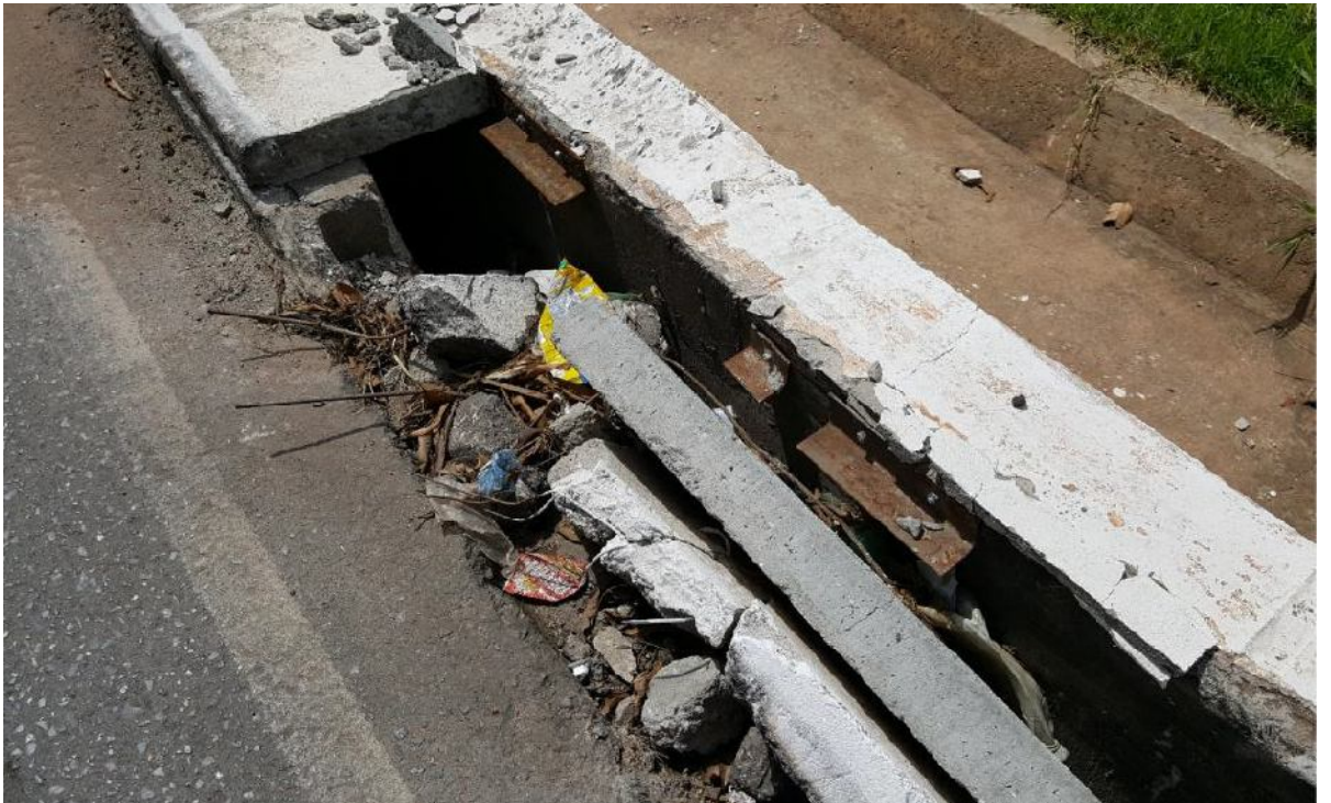
Fig. 05 – Tampas pré-moldadas danificadas.
