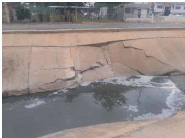
Fig. 04 – Deslizamento das placas de gabião.
