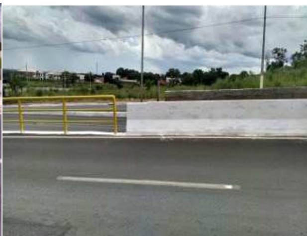
Figura 10 Reparo de concretagem não realizado – Estaca 4;
