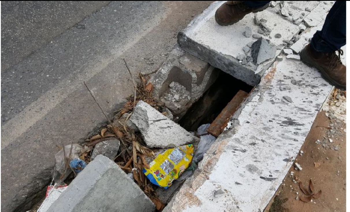
Fig. 04 – Tampas pré-moldadas danificadas.
