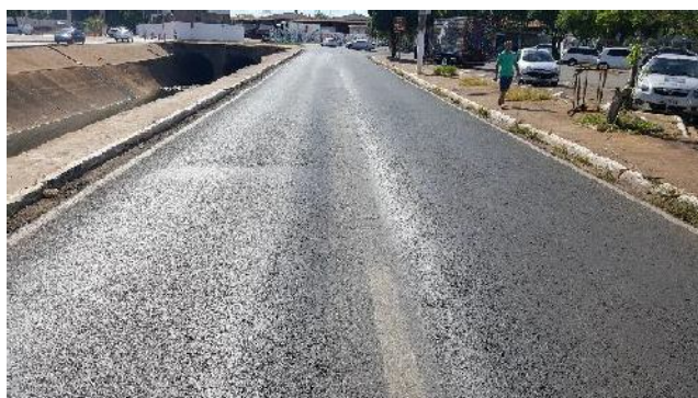
Estaca: 06 Não conformidade: Afundamento do tronco coletor
