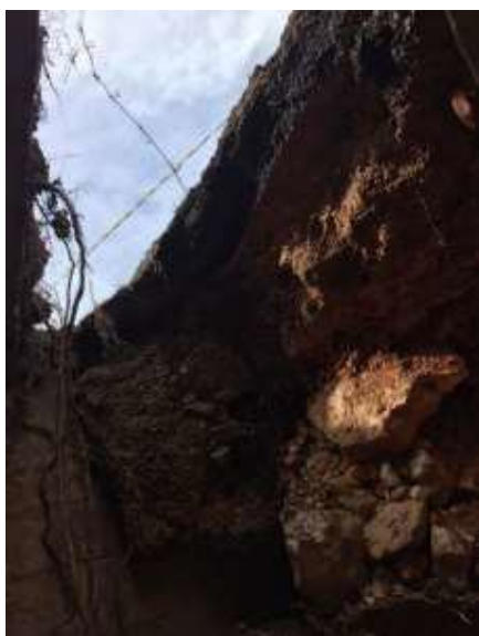
Figura 3 Detalhe da erosão, sob o acostamento.
