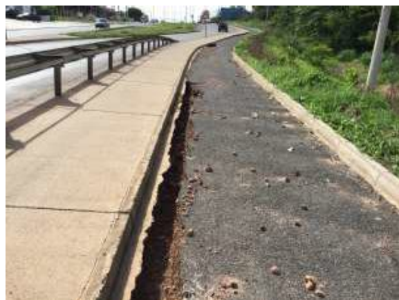
Figura 1- Detalhe erosão e desmoronamento do bueiro.
