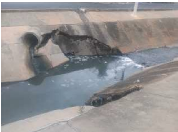
Fig. 07 Deslizamento das placas de gabião.
