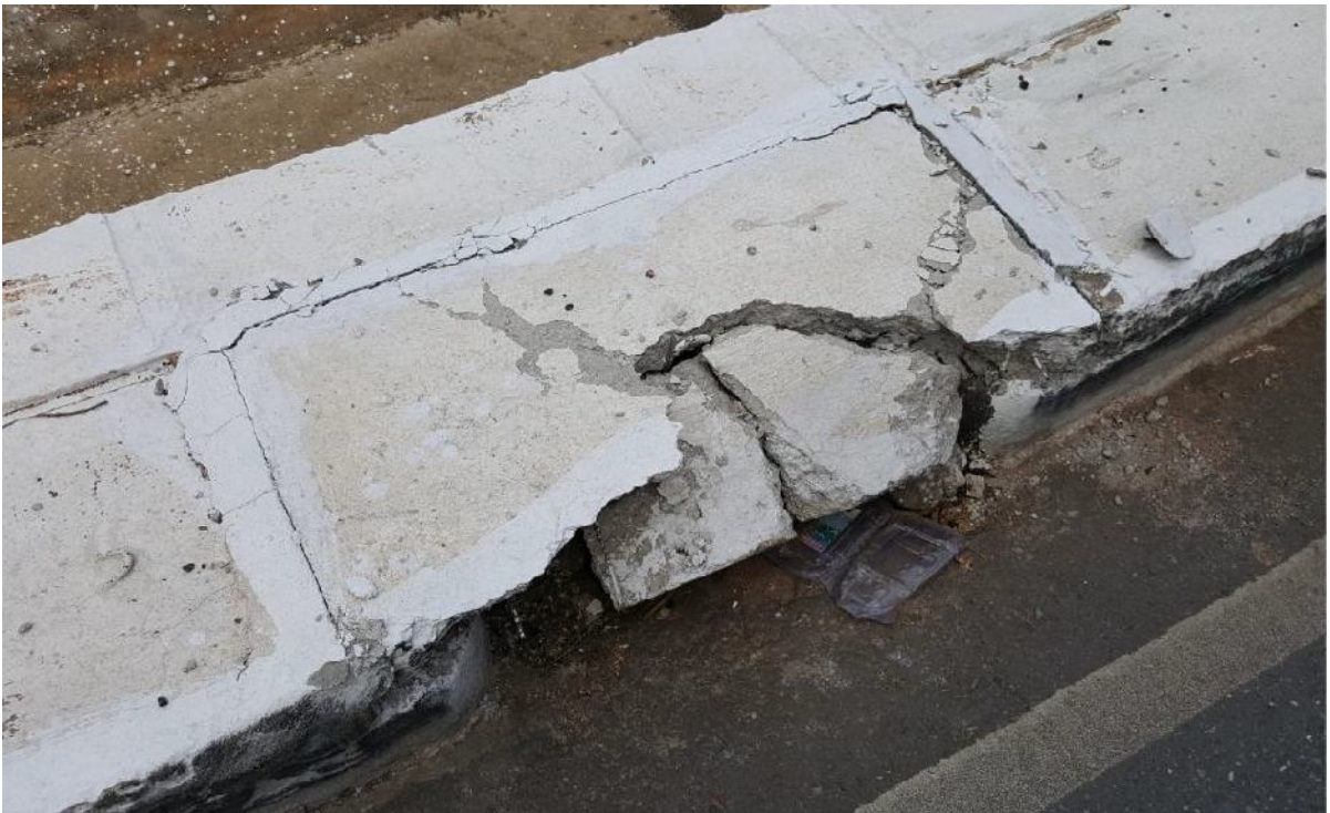
Fig. 03 – Tampas pré-moldadas danificadas.
