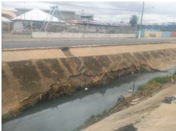
Fig. 08 – Deslizamento das placas de gabião.
