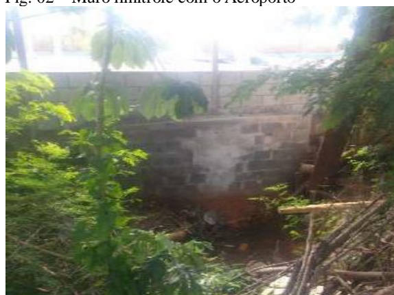
Fig. 04 Muro limítrofe com o Aeroporto
