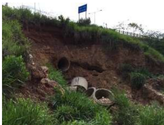
Figura 1- Detalhe erosão e desmoronamento do bueiro.
