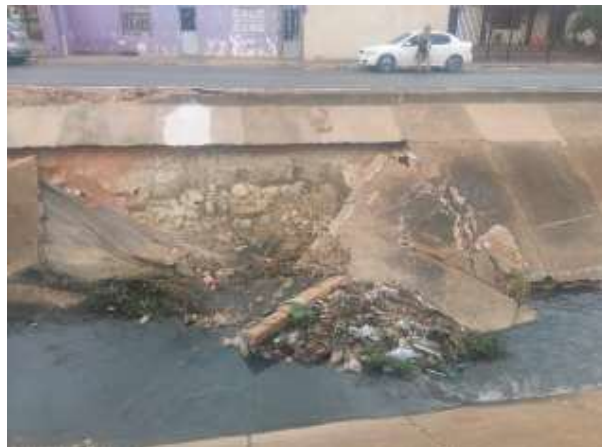
Fig. 02 – Deslizamento das placas de gabião.
