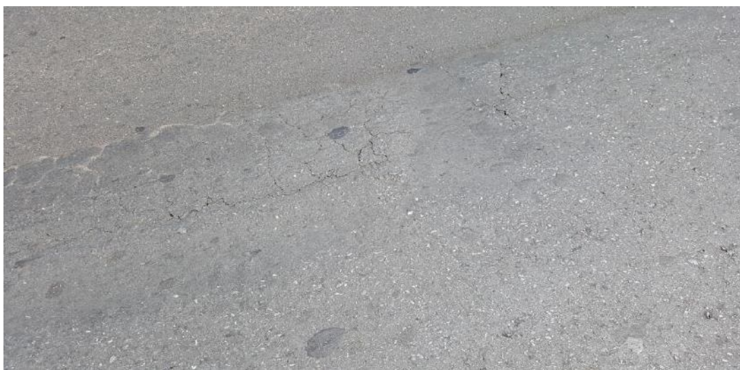
Fig. 01 – Trincas no pavimento próximo à estaca 6.
