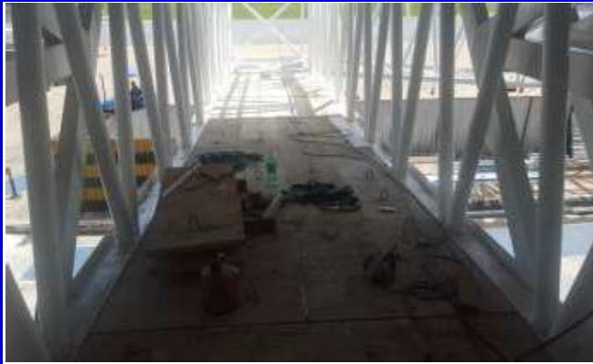
FOTO 05: Instalação de placas de concreto da base do piso da ponte de embarque 03.
