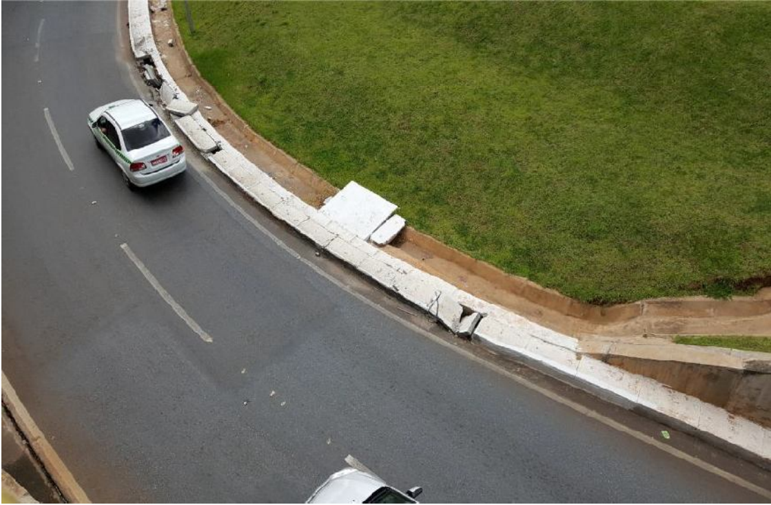
Fig. 02 – Tampas pré-moldadas danificadas.
