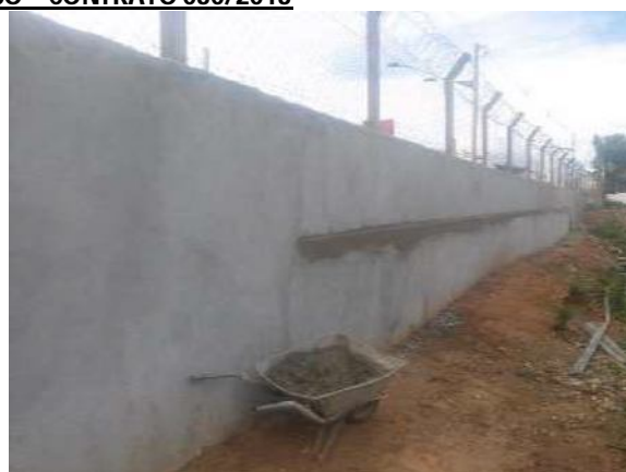
Fig. 02 – Muro limítrofe com o Aeroporto
