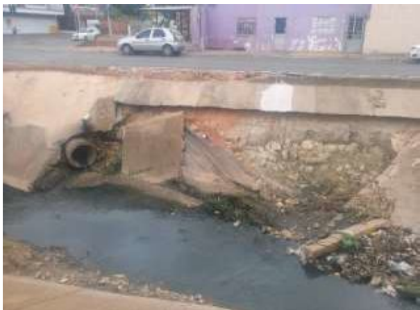
Fig. 01 Deslizamento das placas de gabião.
