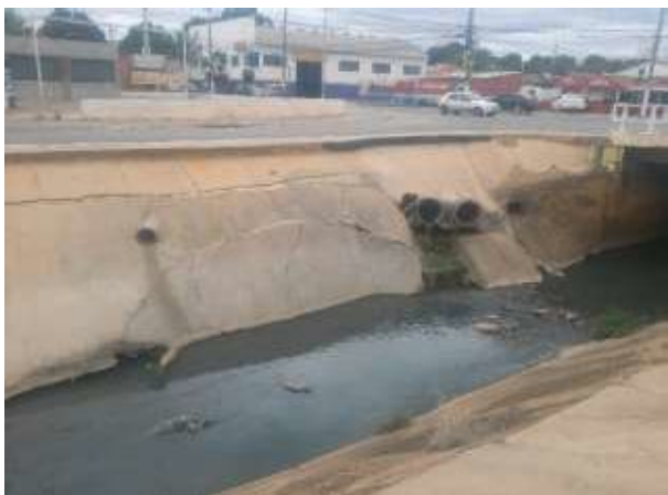
Fig. 03 Deslizamento das placas de gabião.
