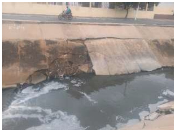
Fig. 06 · Deslizamento das placas de gabião.
