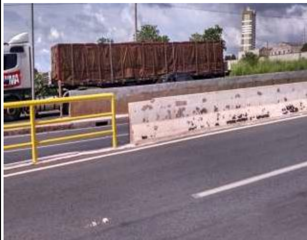
Figura 9 Reparo de concretagem não realizado – Estaca 4;
