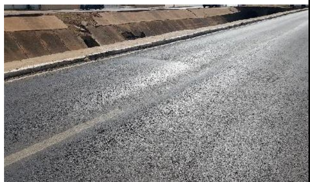
Estaca: 06 Não conformidade: Afundamento do tronco coletor
