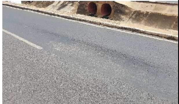
Estaca: 37 Não conformidade: Afundamento
