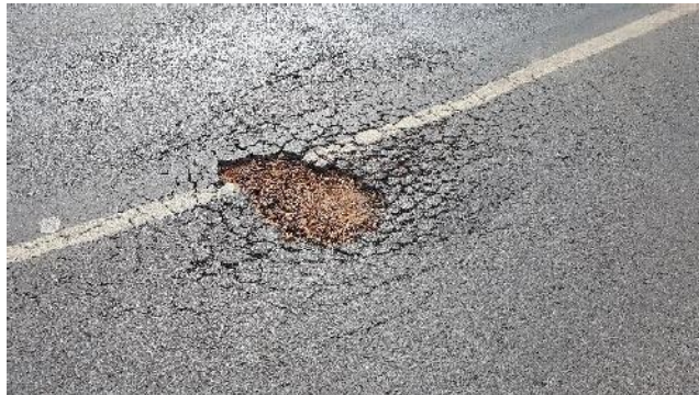
Estaca: 54 Não conformidade: Afundamento PV
