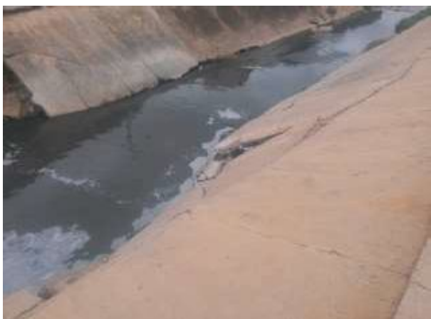
Fig. 05 Deslizamento das placas de gabião.
