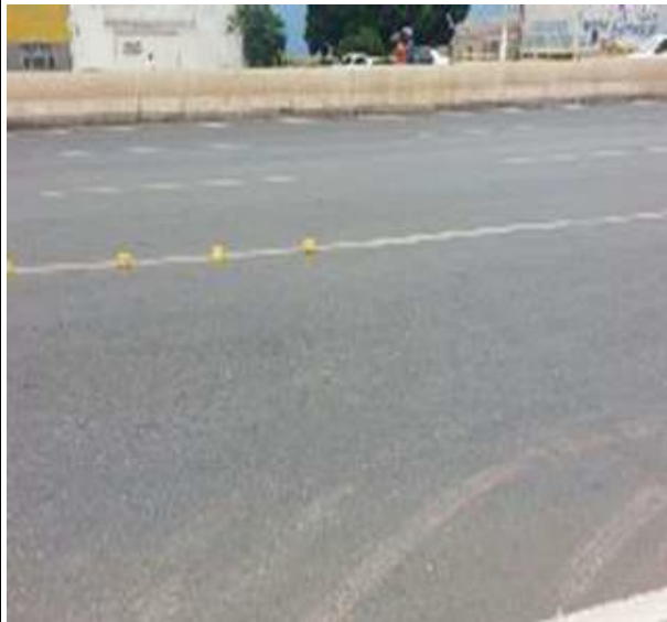
Figura 3 - Trecho na saída da Trincheira Estaca 20 a 26 faltando Tachão;
