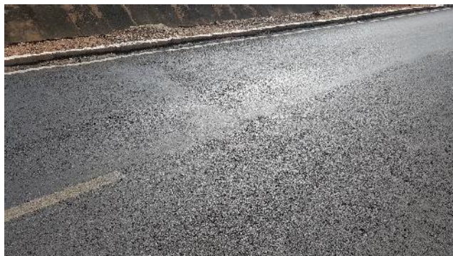
Estaca: 33 Não conformidade: Afundamento
