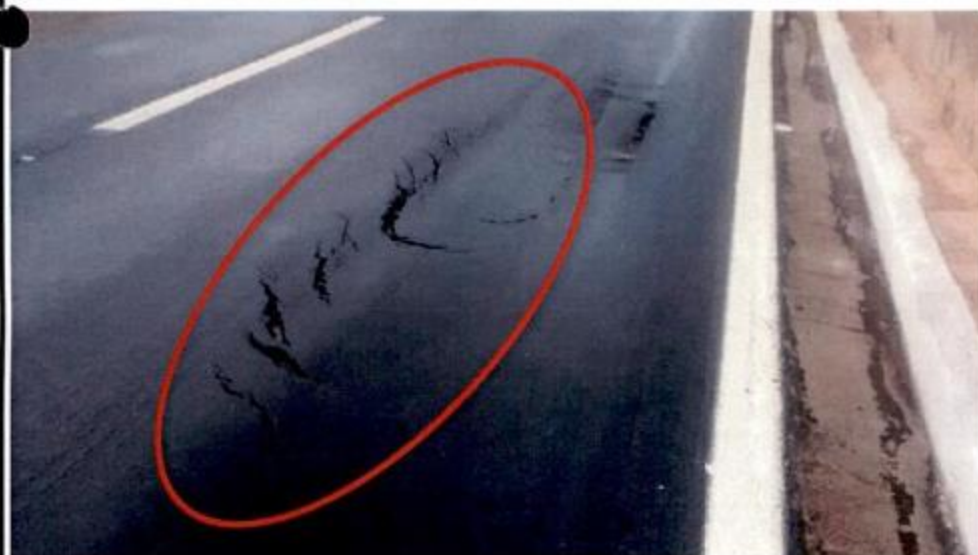
Deslizamento de massa asfáltica
