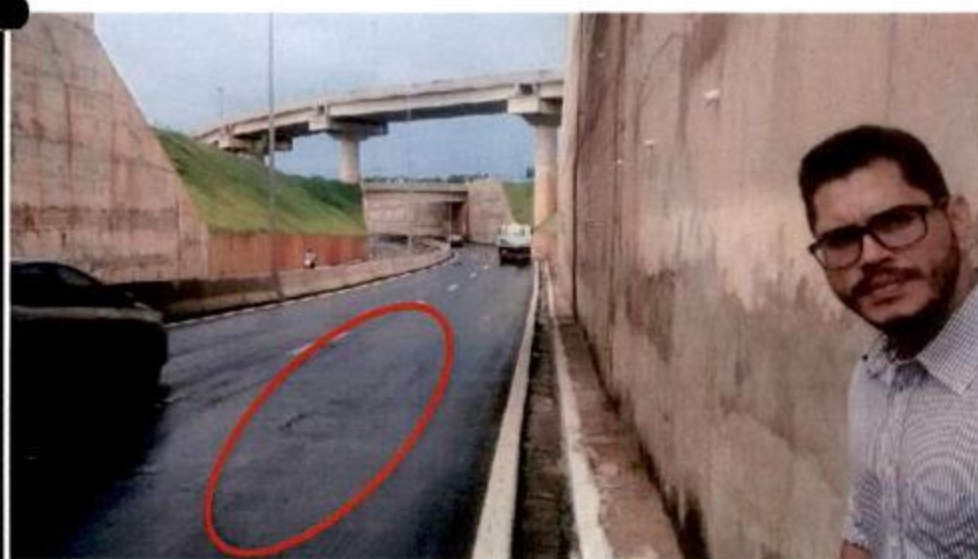
Afundamento do pavimento asfáltico
