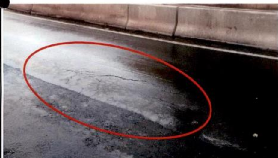
Trincas e afundamento de pavimento
