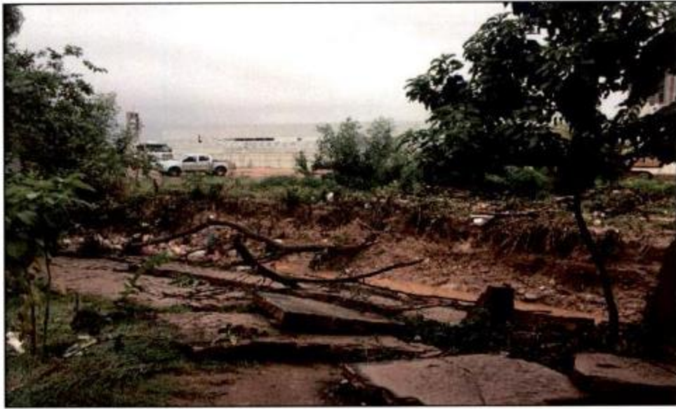
Figura 7- Detalhe da margem com processo erosivo.
