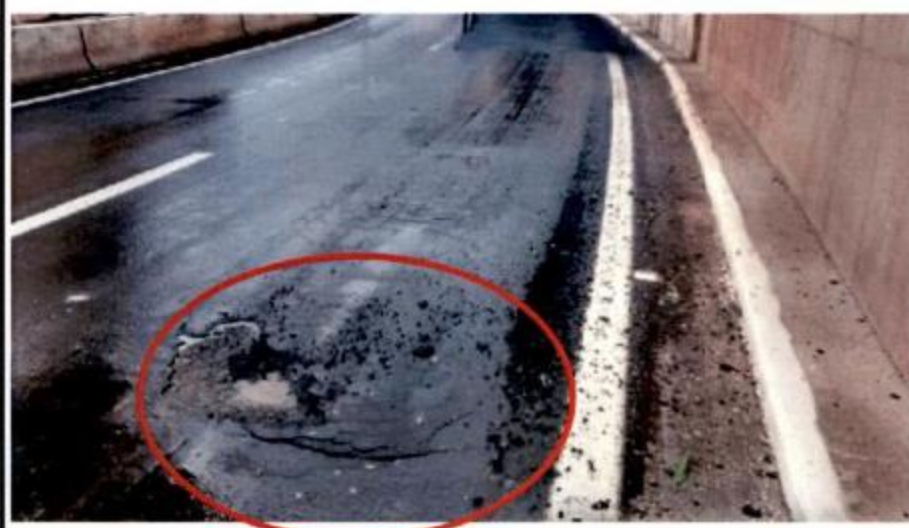
Afundamento do pavimento e buraco na pista
