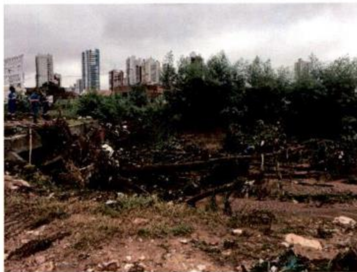
Figura 10- Canal obstruído pelos entulhos.
