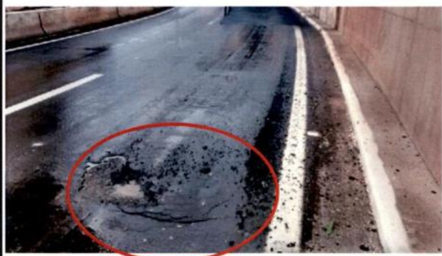
Afundamento do pavimento e buraco na pista
