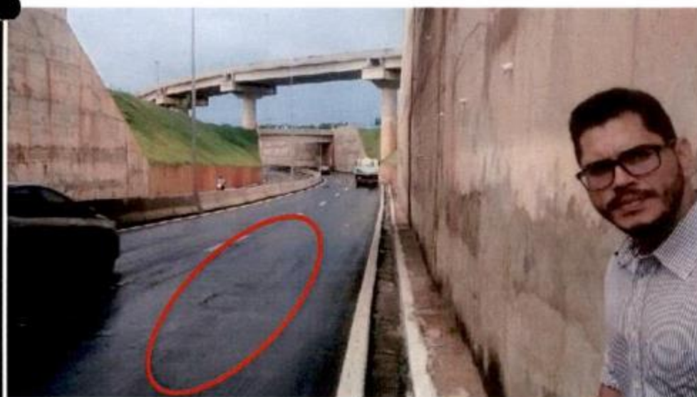
Afundamento do pavimento asfáltico
