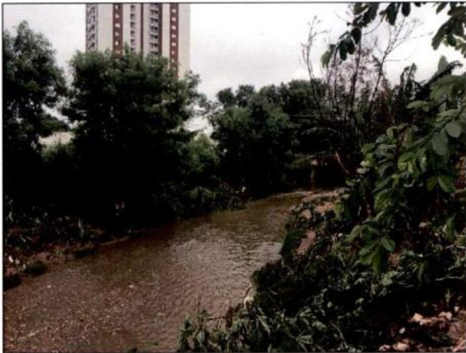
Figura 8- Detalhe processo erosivo, local onde serão implantados o muro de gabião.
