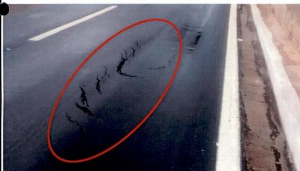
Deslizamento de massa asfáltica
