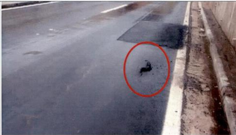
Deslizamento de massa asfáltica
