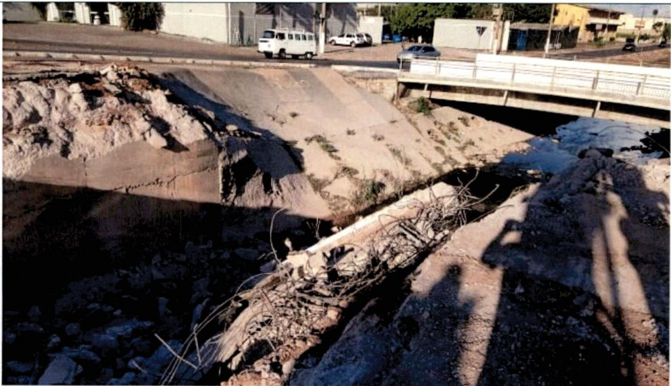
Fig. 07 – Demolição dos dispositivos de concreto armado – Rua Barão de Melgaço com Av. Oito de Abril;
