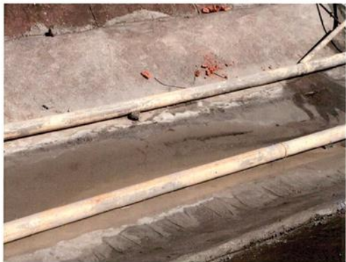
Figura 2- Tubulação da ensecadeira.
