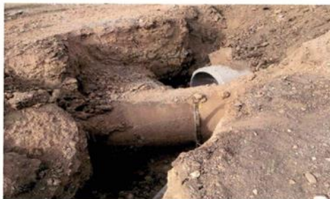
Figura 15- Tubulação de drenagem, coletora das calhas da cobertura.
