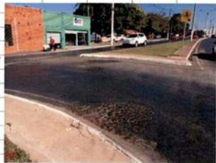
Detalhe 01 - Trecho com problemas no pavimento, aparecimento de trincas, covas de jacaré e afundamento.
