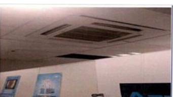
FOTO 08: Instalação de AR condicionado em áreas diversas da ampliação do TPS (Água gelada)
