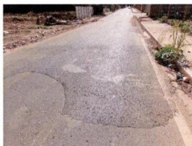
Fotografia 25 – Remendo mal feito
