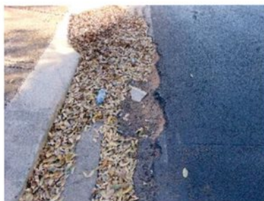
Fotografia 48 – Buraco no pavimento
