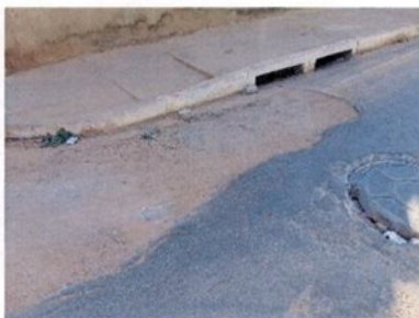
Fotografia 116 – Buraco no pavimento
