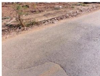
Fotografia 26 – Remendo mal feito
