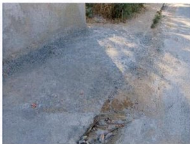
Fotografia 112 – Calçada mal feita
