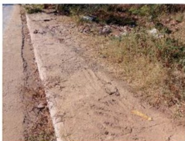
Fotografia 109 – Calçada mal feita
