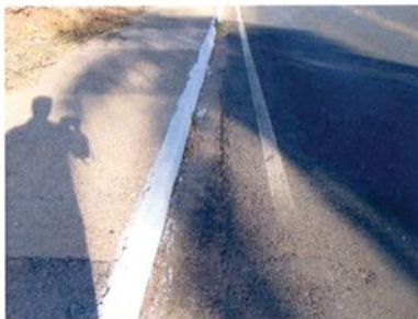
Fotografia 82 – Sarjeta mal feita
