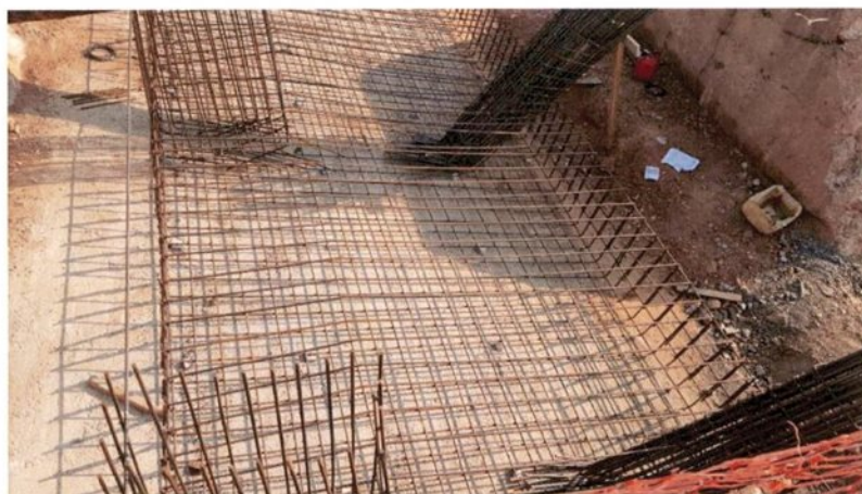
Fig. 04 – Execução da armadura da fundação da laje da rotatória da Av. Senador Metelo;
