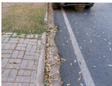
Fotografia 40 – Sarjeta mal feita
