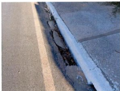
Fotografia 57 – Buraco na sarjeta
