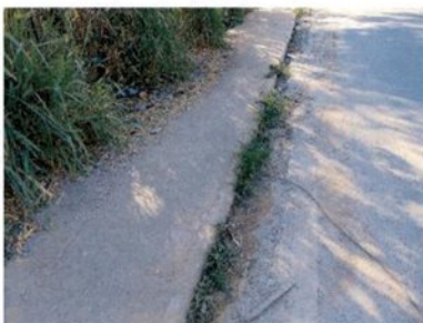
Fotografia 113 – Sarjeta mal feita
