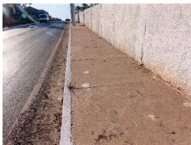
Fotografia 74 – Sarjeta mal feita
