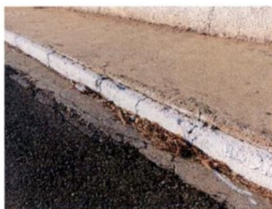
Fotografia 62 – Meio-fio e sarjeta quebrado
