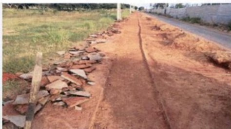
FOTO 05: FRENTE 3 - Aterro de vala para passagem dos dutos na via de acesso da ETE
