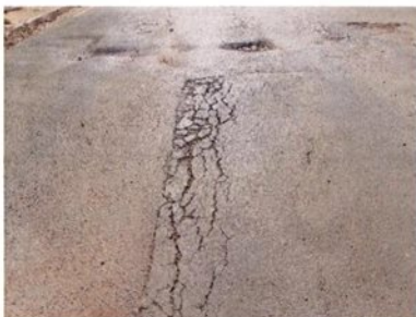
Fotografia 27 – Trinca "couro de jacaré"
