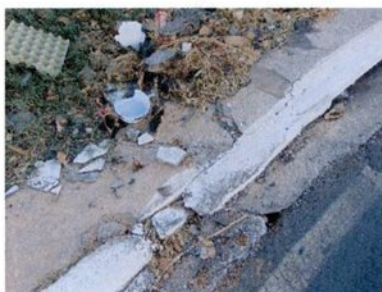
Fotografia 67 – Buraco no meio-fio e sarjeta
