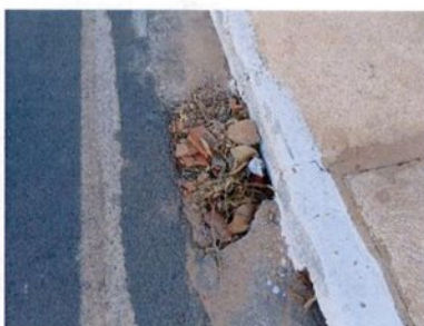
Fotografia 52 – Buraco na sarjeta
