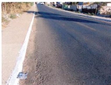
Fotografia 83 – Sarjeta mal feita
