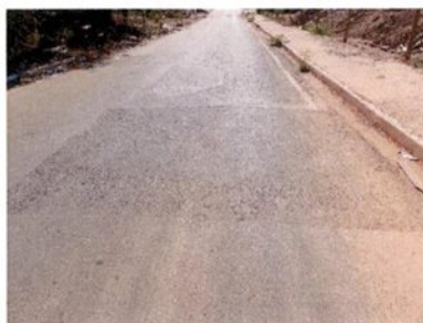
Fotografia 23 – Remendo mal feito
