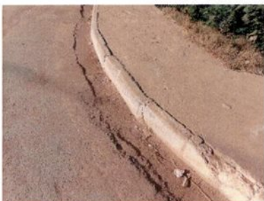
Fotografia 115 – Sarjeta mal feita
