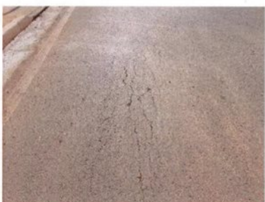
Fotografia 18 – Trinca "couro de jacaré"
