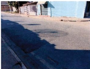
Fotografia 118 – Remendo mal feito
