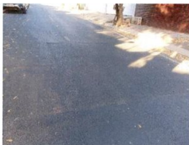
Fotografia 39 – Remendo mal feito
