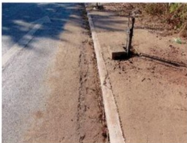
Fotografia 111 – Sarjeta mal feita
