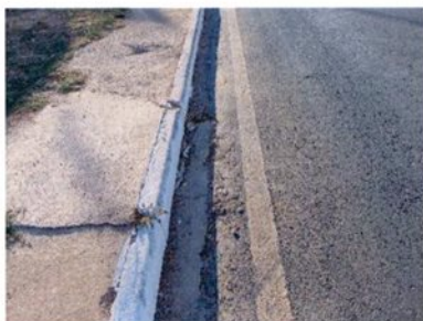
Fotografia 71 – Meio-fio e sarjeta quebrada
