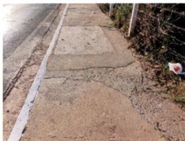
Fotografia 85 – Calçada e sarjeta quebrada
