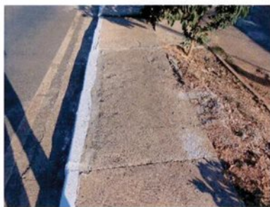
Fotografia 79 – Calçada mal feita
