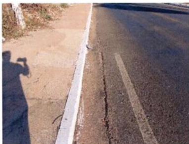
Fotografia 81 – Calçada e sarjeta quebrada
