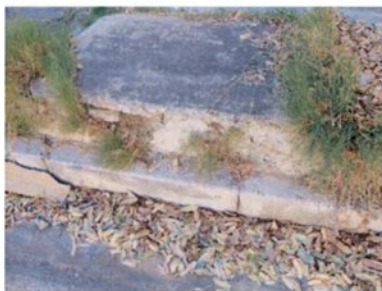
Fotografia 38 – Calçada acima do meio-fio
