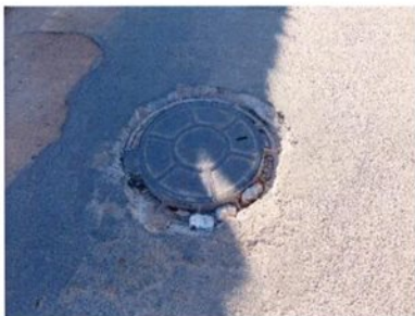
Fotografia 117 – Remendo mal feito
