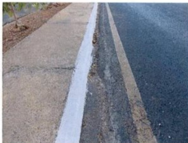
Fotografia 76 – Sarjeta mal feita
