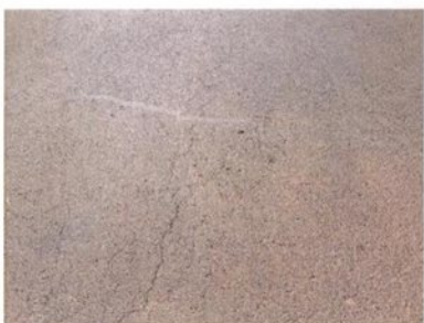
Fotografia 19 – Trinca "couro de jacaré"
