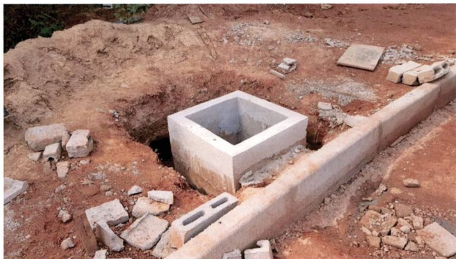
Fig. 06 – Caixa de passagem do equipamento Fotofinish.
