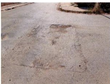
Fotografia 29 – Remendo mal feito
