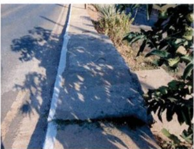
Fotografia 80 – Calçada mal feita
