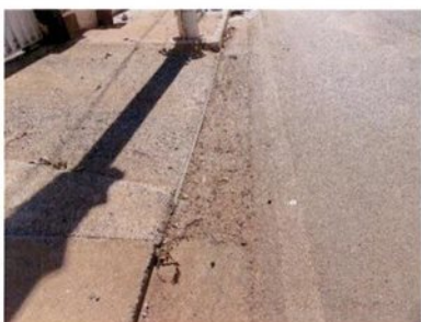
Fotografia 17 – Sarjeta mal feita
