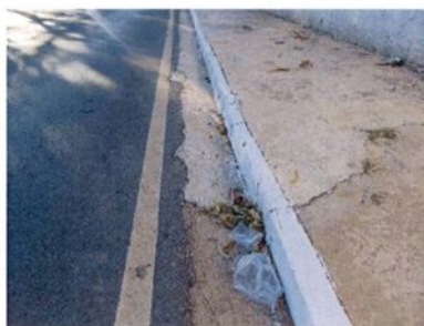
Fotografia 77 – Calçada e sarjeta quebrada
