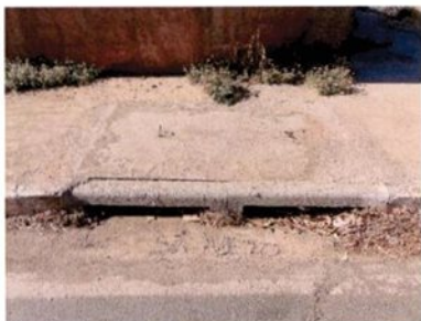
Fotografia 33 – Sarjeta mal feita
