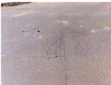
Fotografia 31 – Trinca "couro de jacaré"
