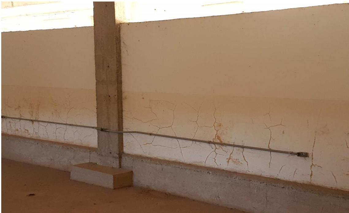
Marca da chuva de outubro de 2016 na parede do vestiário
