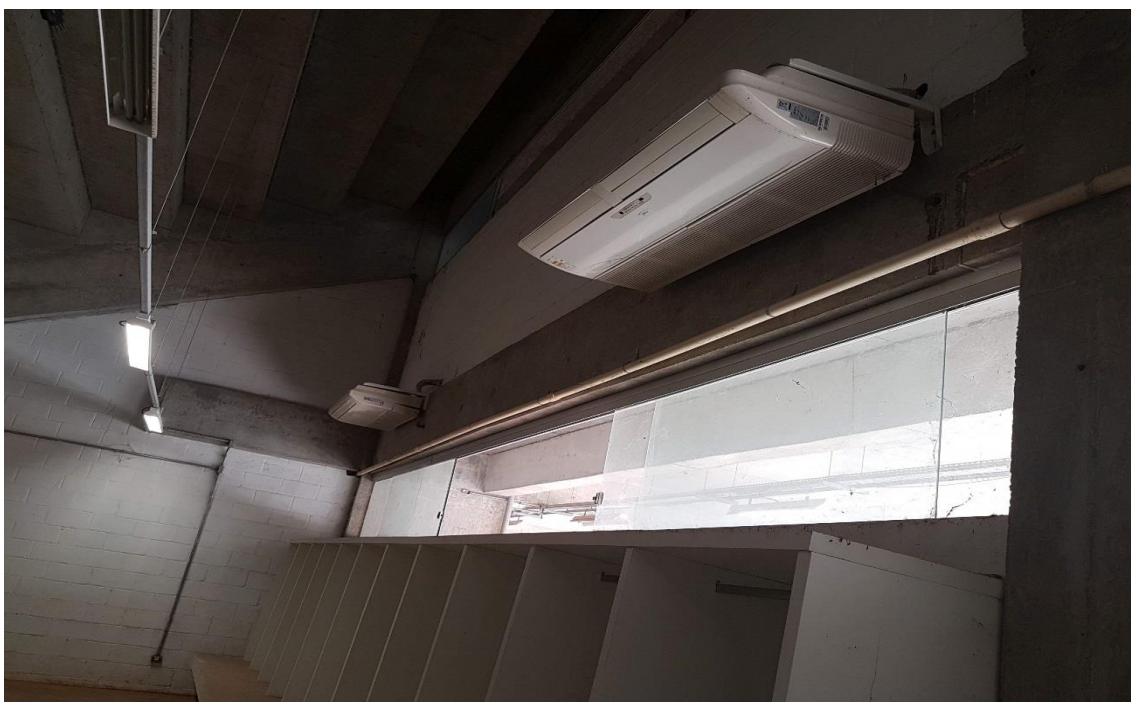
Condicionadores de ar do vestiário
