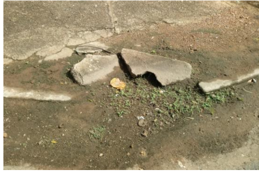
Tampa de bueiro danificada 15° 35' 50" S e 56° 6' 48" W
