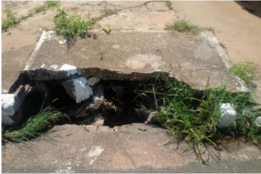
Tampa de bueiro danificada 15° 36' 55" S e 56° 7' 22" W
