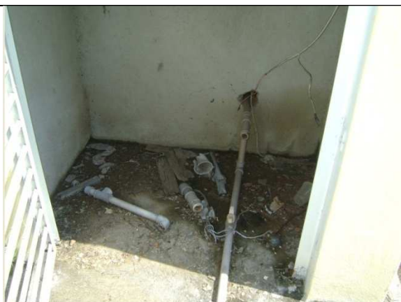
Fig. 7 – Inexistência de conjunto elevatório motor-bomba
