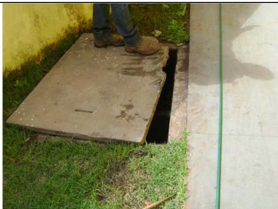
Fig. 3 – Tampa de caixa danificada expondo a contaminação os usuários do equipamento público
