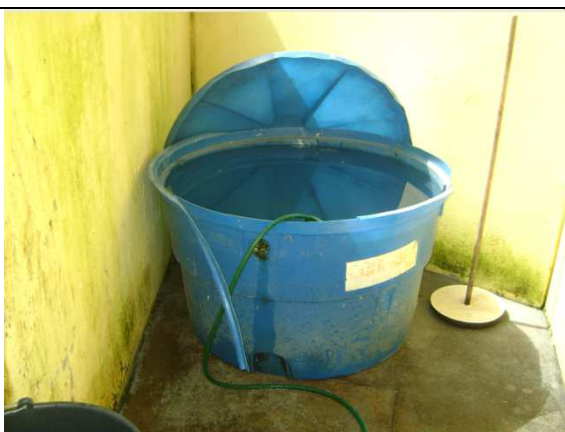
Fig. 6 – Instalação hidráulica em desconformidade com as normas técnicas
