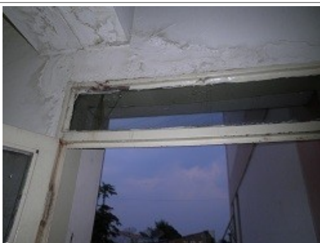
Rachaduras, paredes com massa de tintas descascando
