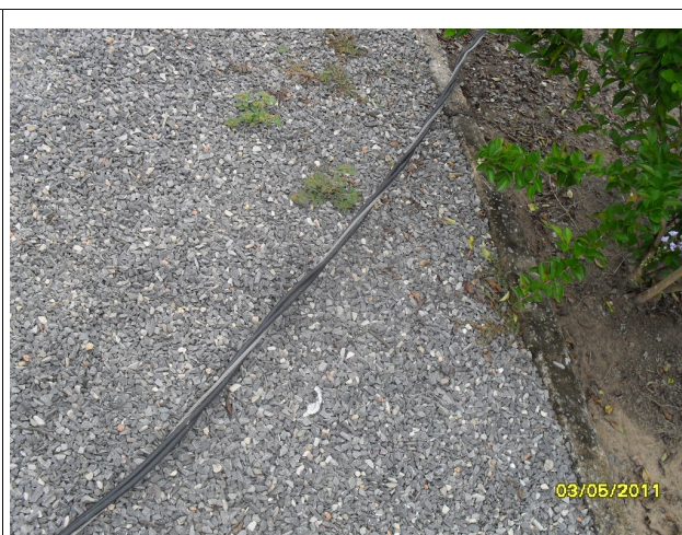
Fios elétricos expostos no pátio da escola
