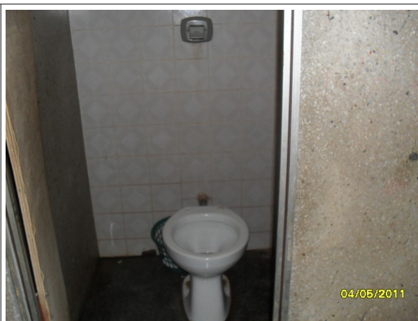
Banheiros com portas caindo e em péssima situação
