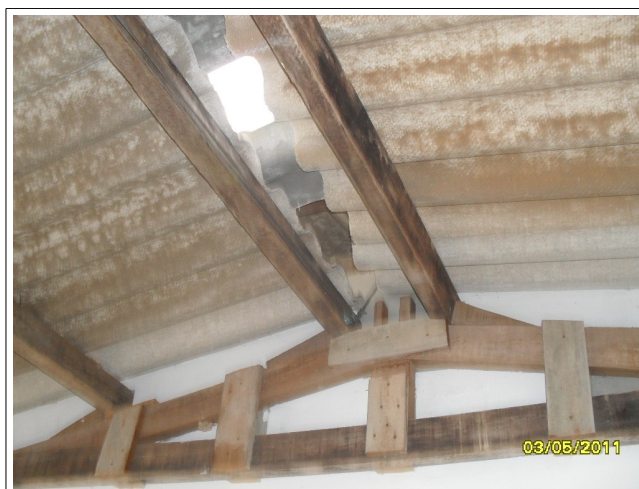
Buracos no teto da escola
