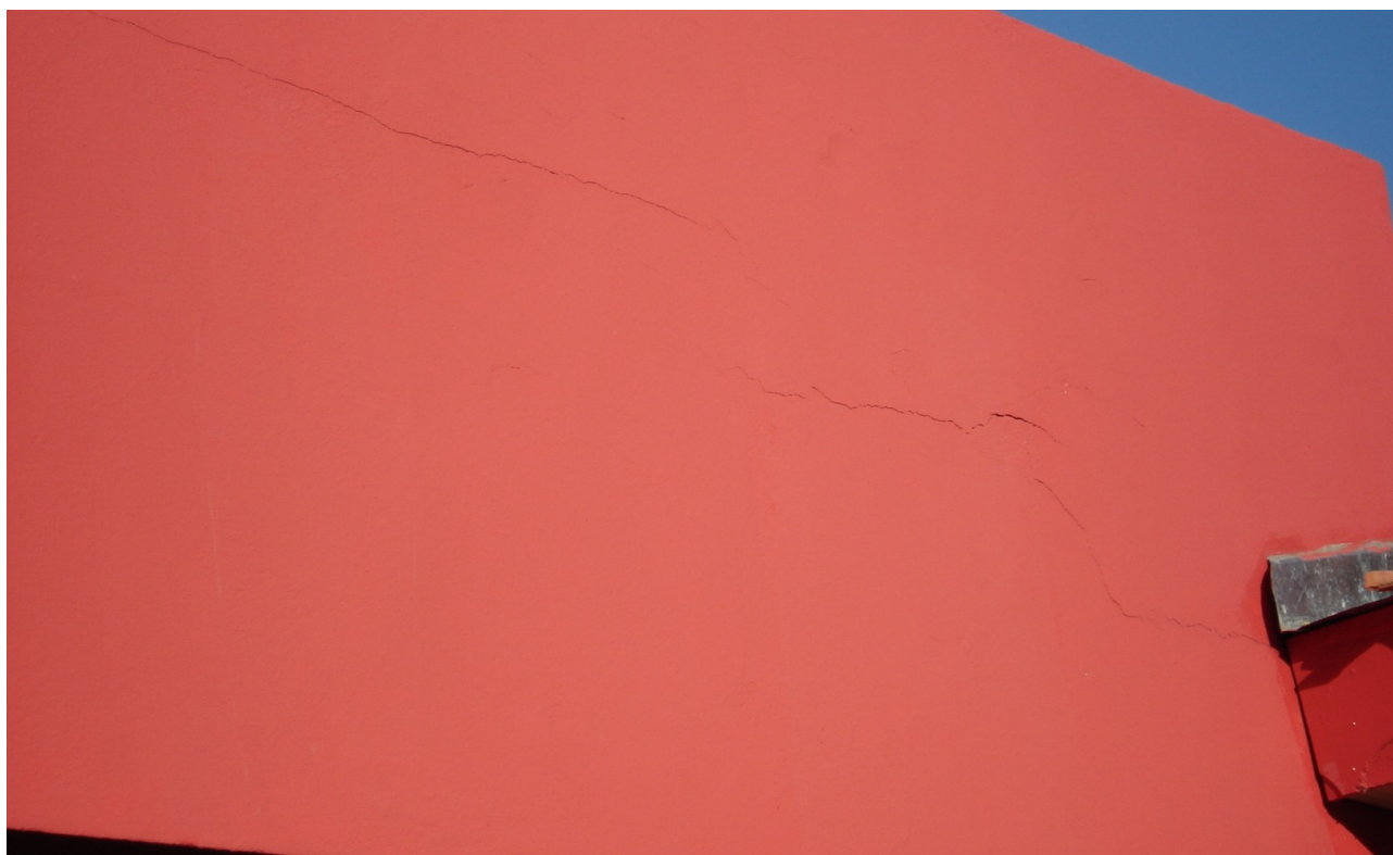
Foto 19: Trincas na estrutura das passarelas.
