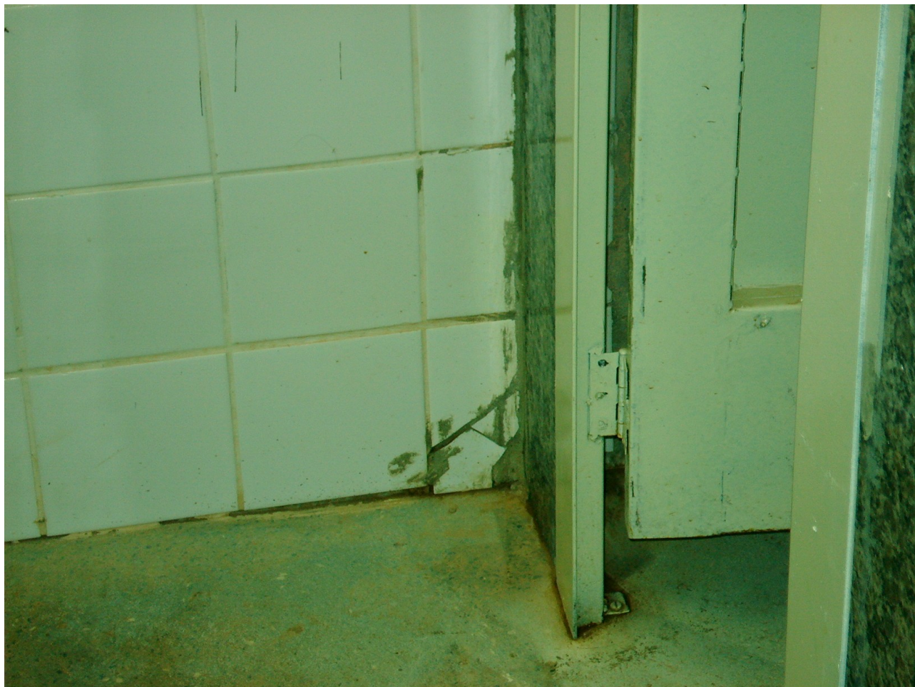
Foto 6: Revestimentos dos banheiros não foram substituídos.
