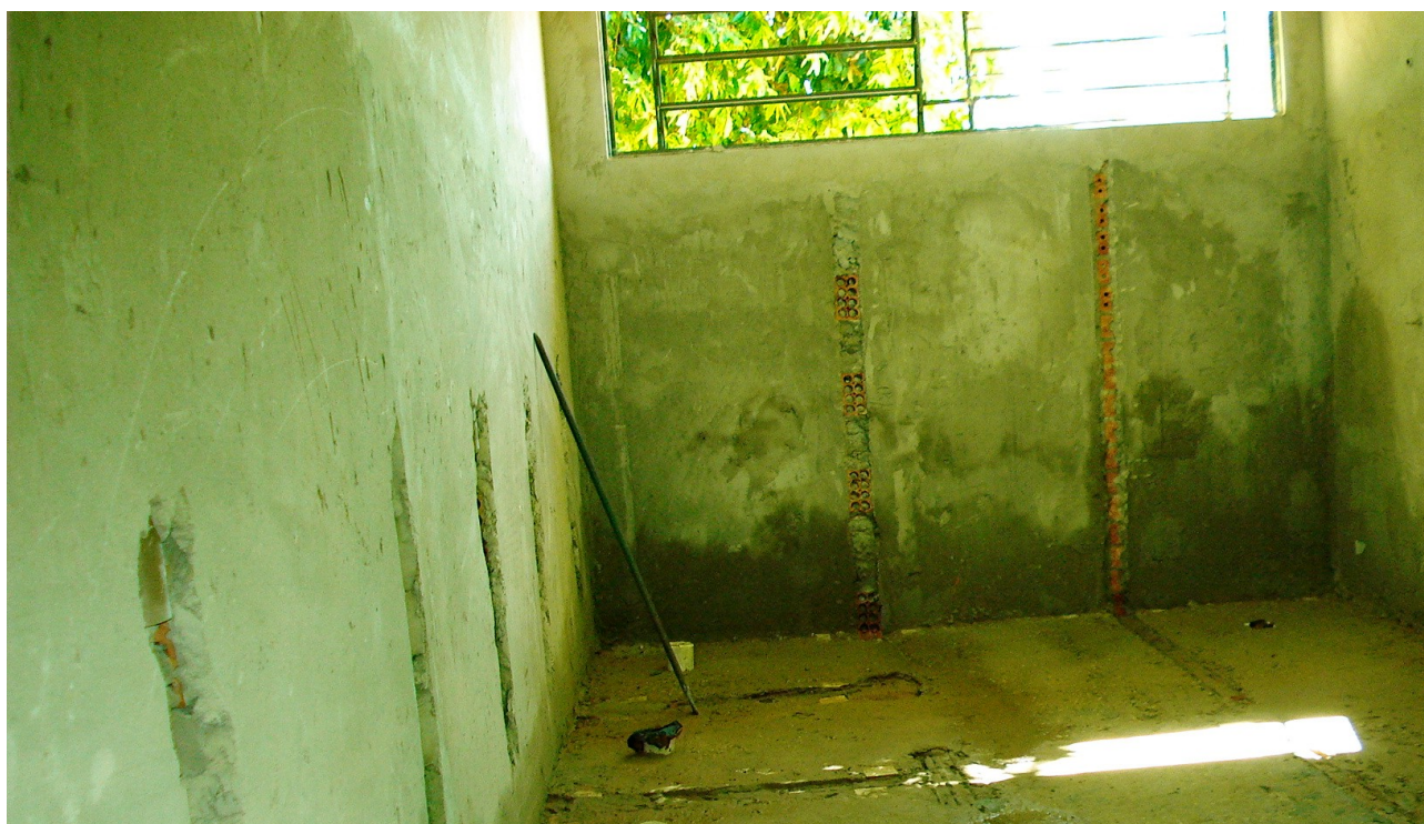
Foto 29: Banheiros estão inacabados.
