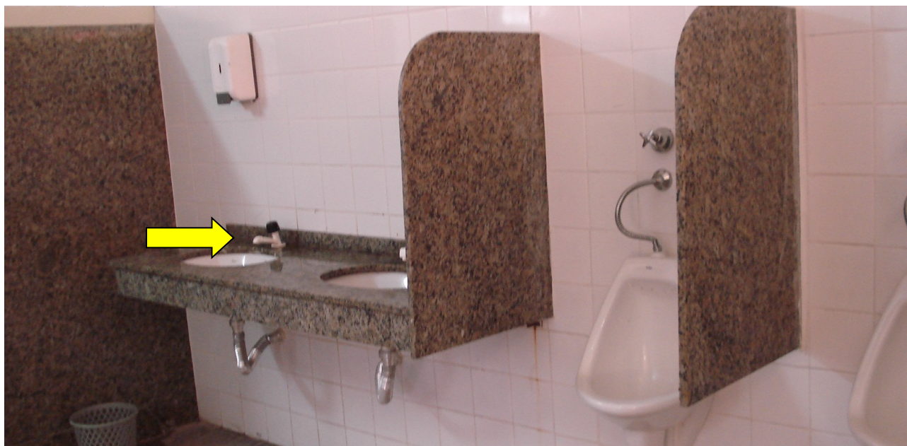
Foto 18: Torneiras fora de especificação nos banheiros.
