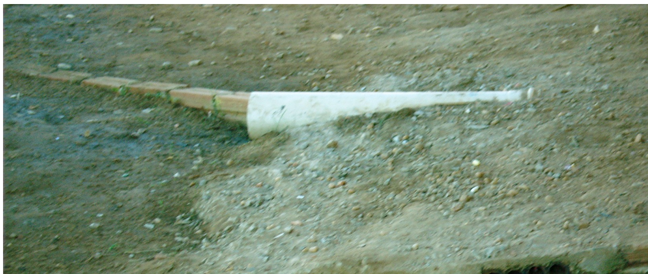
Foto 1: Lançamento de águas servidas na quadra da escola.
