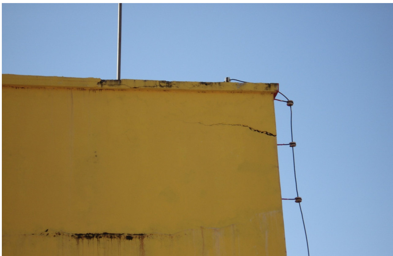
Foto 14: Instalação de novo para-raio não foi feita.
