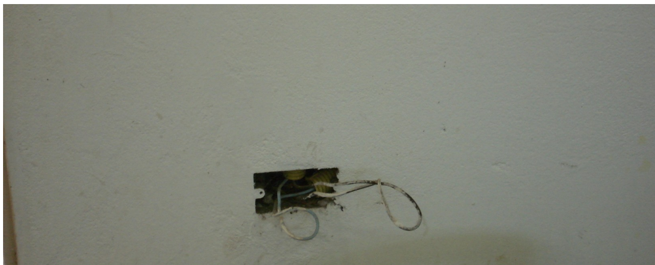
Foto 10: Há diversas instalações elétricas com fiação exposta.
