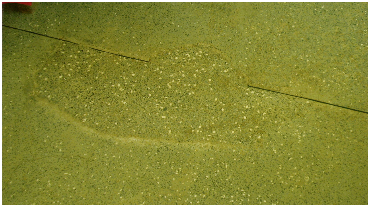
Foto 23: Emendas de mau acabamento feito no piso dos corredores.
