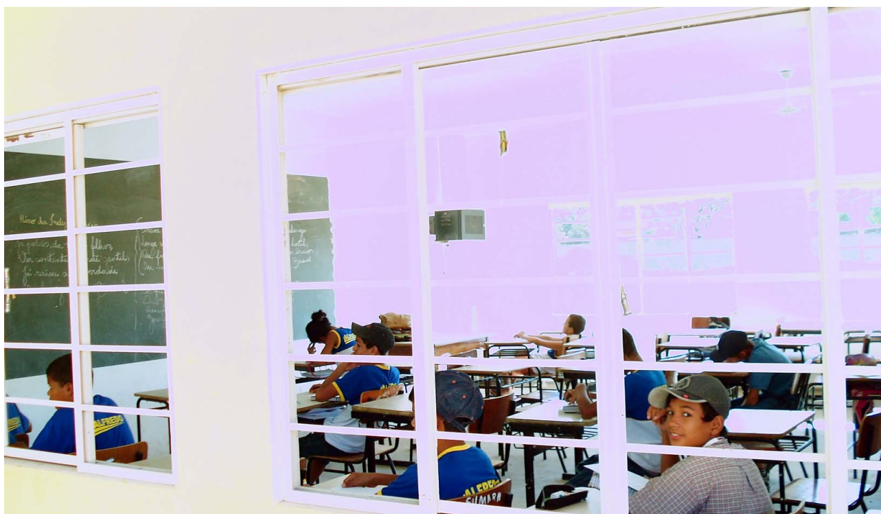
Foto 28: Salas de aulas sem vidros nas janelas.
