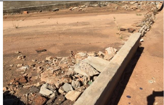
Figura 184 Detalhe da mureta de proteção destruída
