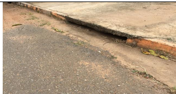
Figura 160 Boca de lobo para coleta de água pluvial
