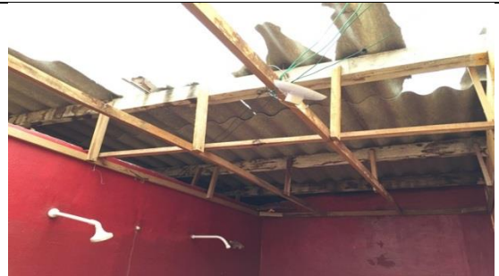
Figura 80 Situação da cobertura fibrocimento
