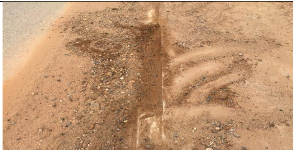
Figura 195 Detalhe da boca para bueiro totalmente obstruída
