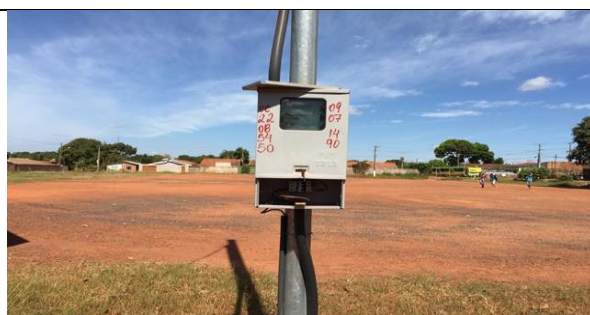
Figura 125 Detalhe do padrão de energia
