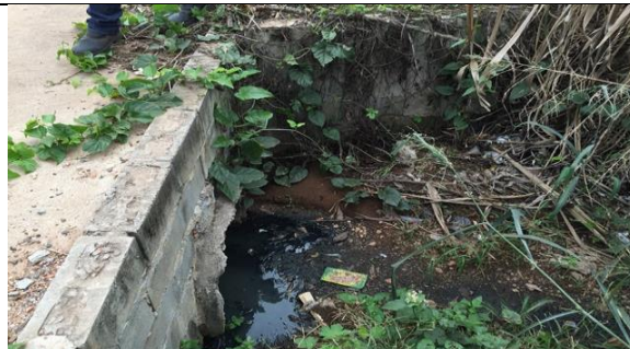
Figura 157 Detalhe da saída do tubo de concreto
