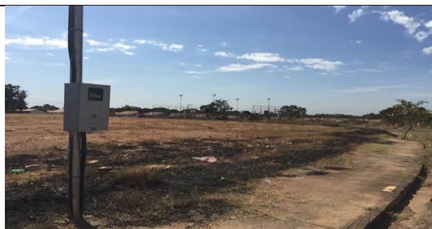
Figura 129 Detalhe do padrão de energia
