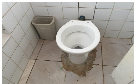
Figura 13 Instalação inadequada do vaso sanitário
