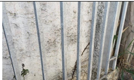
Figura 98 Portão de ferro
