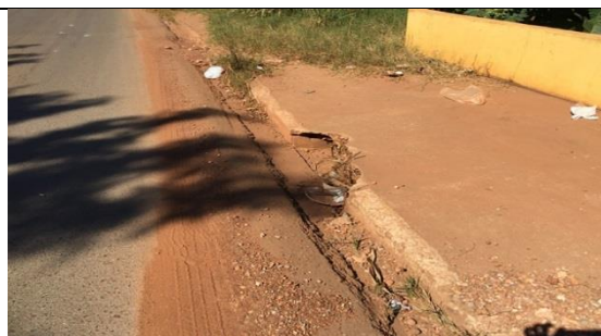
Figura 187 Detalhe da boca de lobo
