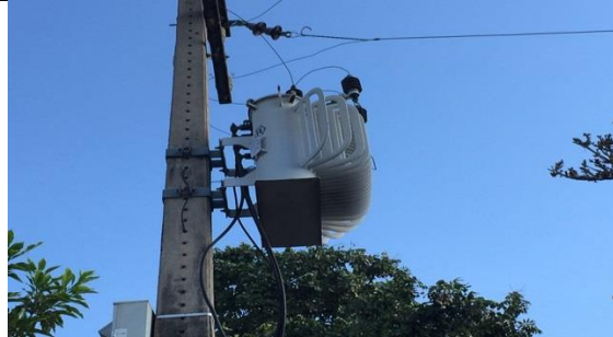
Figura 75 Posto de transformação de 112,5 KVA
