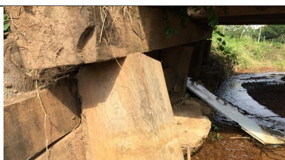
Figura 211 Detalhe do pilar com problema
