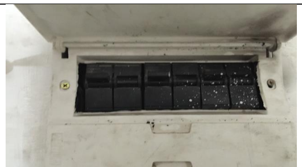
Figura 51 Detalhe do quadro de distribuição
