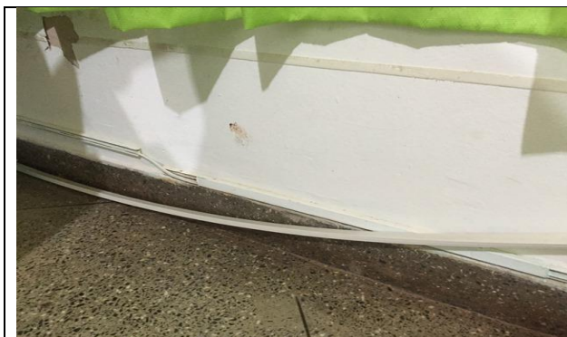
Figura 25 Detalhe das canaletas instaladas
