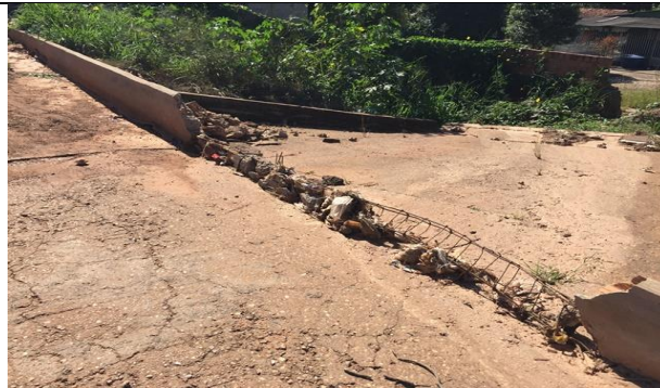
Figura 183 Detalhe da mureta de proteção destruída
