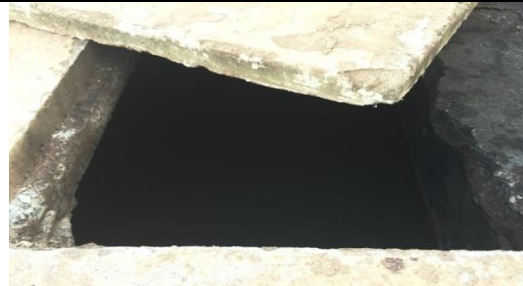
Figura 64 Tampa de acesso ao filtro
