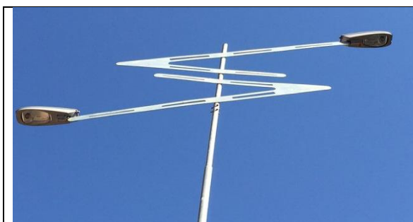
Figura 225 Detalhe a iluminação pública
