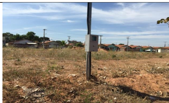
Figura 142 Detalhe do padrão de energia
