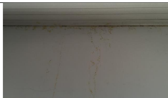
Figura 36 Detalhe do vazamento
