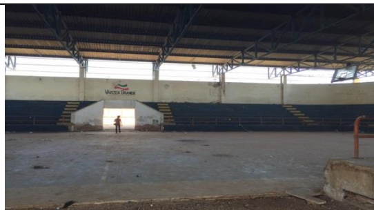
Figura 95 Visão geral do ginásio abandonado
