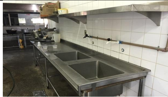
Figura 2 Pia sem instalação de torneiras metálicas
