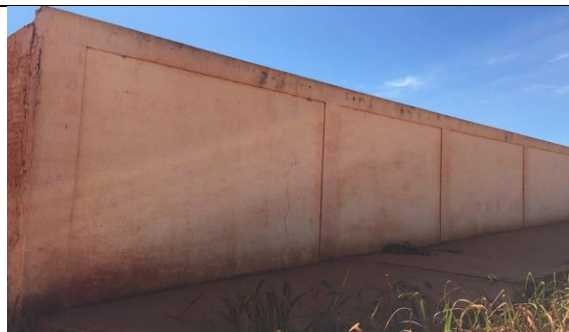
Figura 87 Muro com reboco
