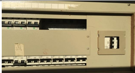
Figura 77 Quadro de distribuição de energia
