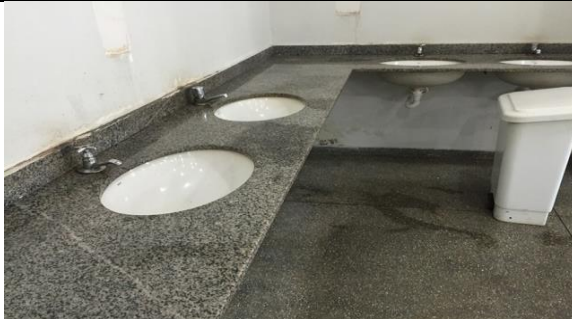
Figura 5 Bancadas com instalações de torneiras usadas diferente da planilha de especificação
