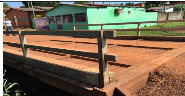
Figura 178 Detalhe da cabeceira com problema
