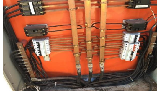
Figura 76 Quadro de distribuição geral
