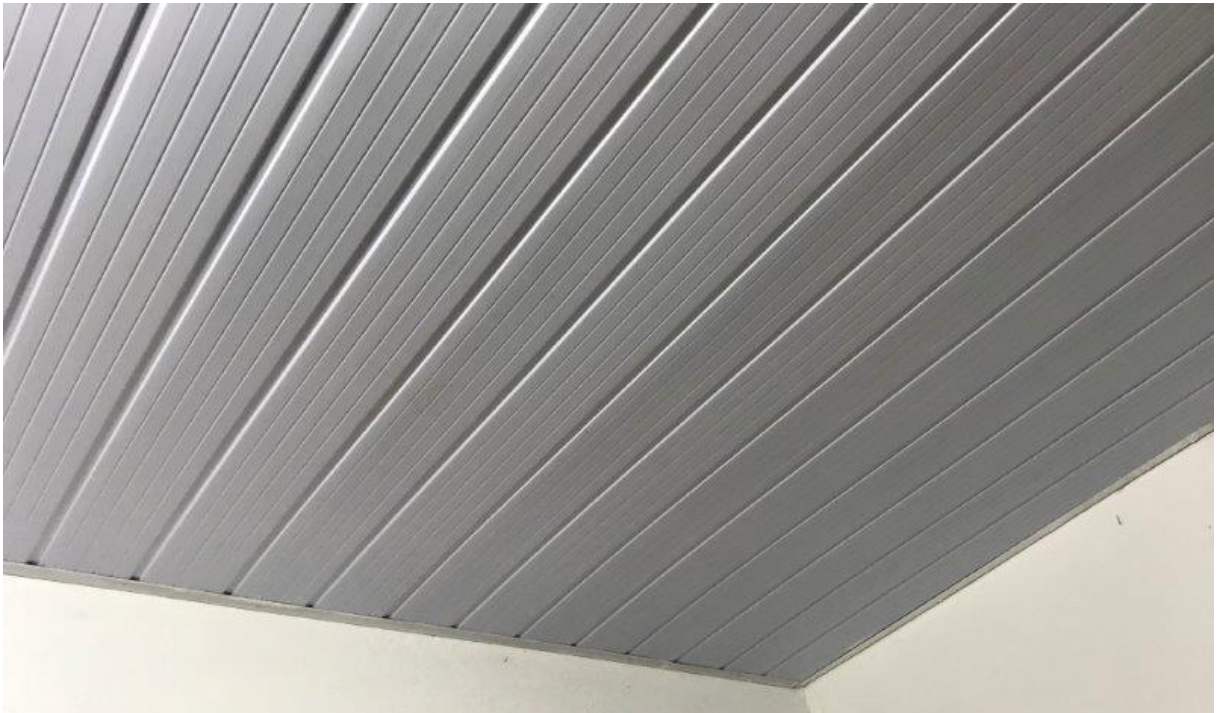
Forro trocado (sala do Pré II D)
