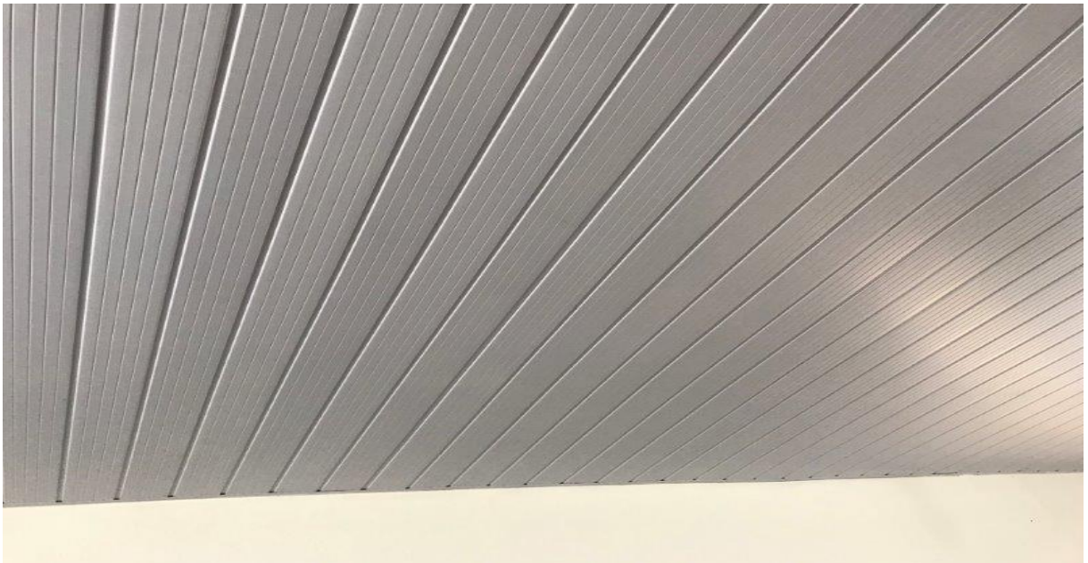
Forro trocado (sala do 1º ano B)
