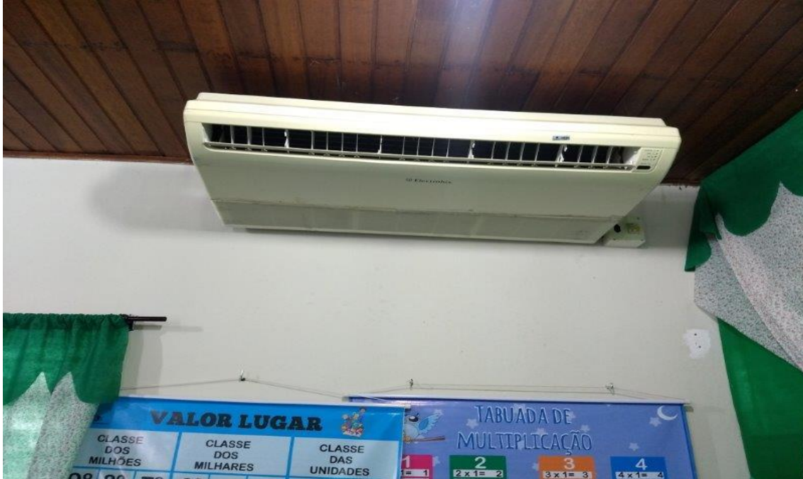
Foto 42: Ar condicionado da sala de aula.
