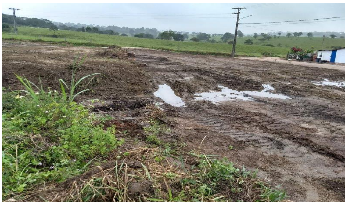
Foto 33: Permanece água parada ao lado do ginásio.
