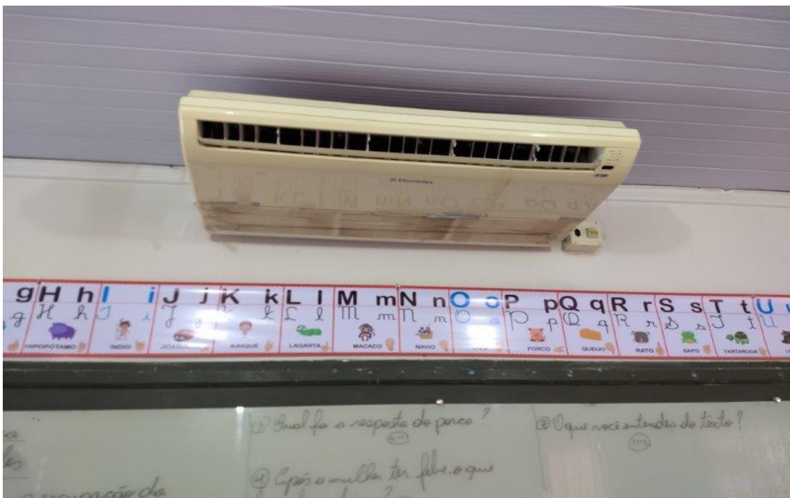
Foto 41: Ar condicionado da sala de aula.
