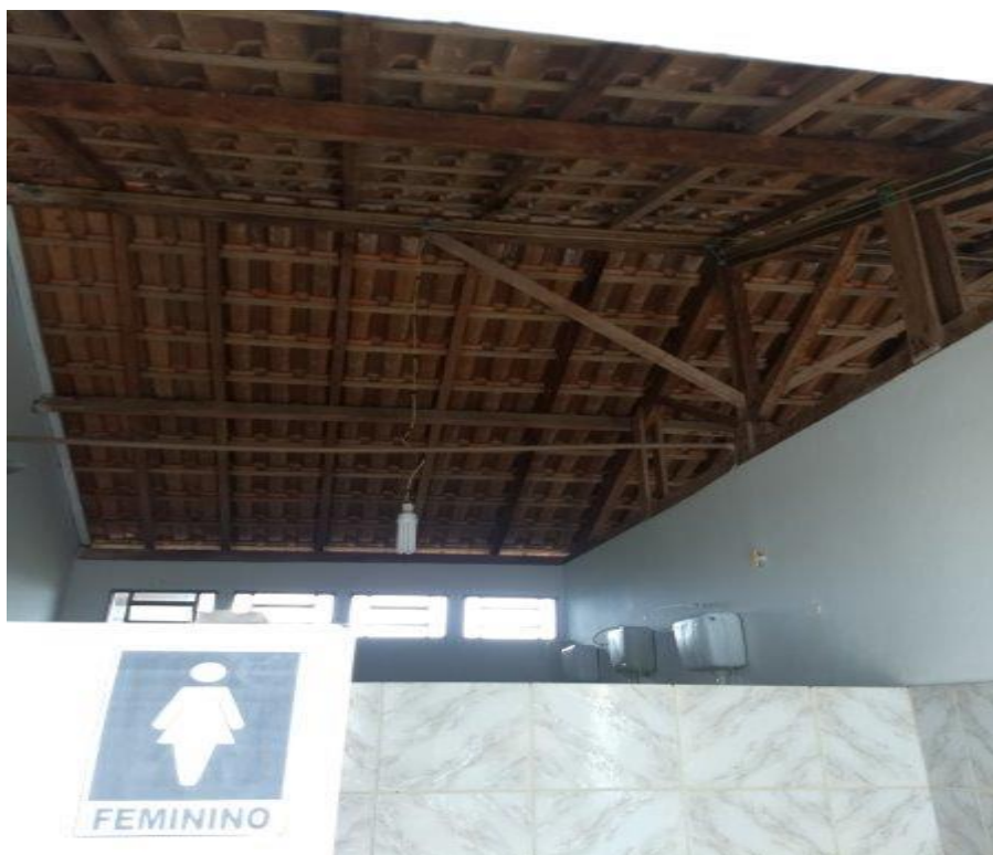
Foto 4: Sanitário feminino sem forro.
