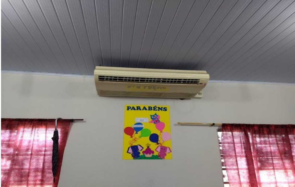
Foto 40: Ar condicionado da sala de aula.
