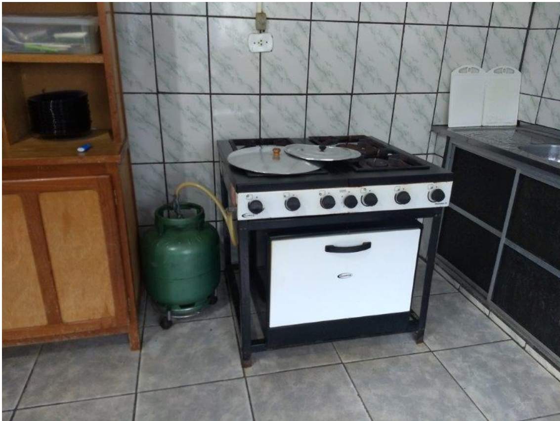
Foto 62: Botijão instalado dentro da cozinha.
