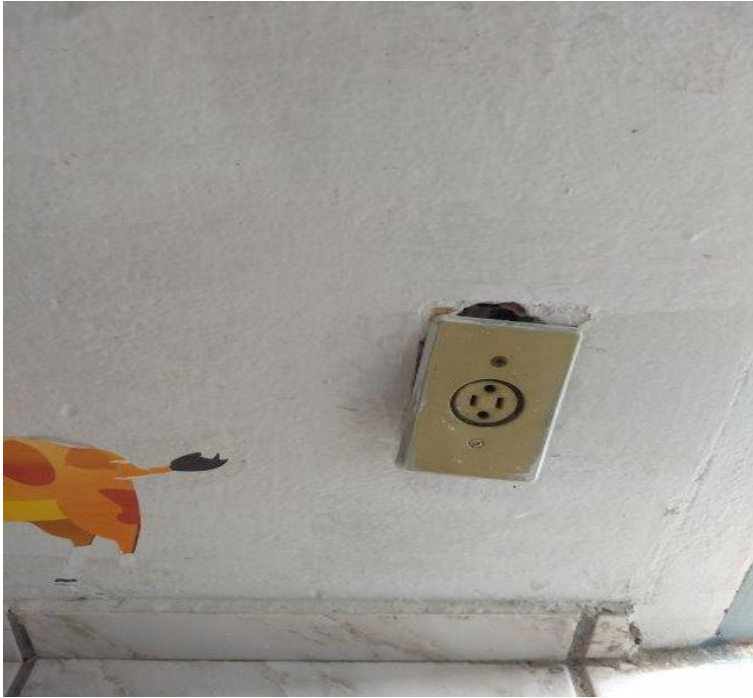
Foto 37: Tomada velha e mal colocada.
