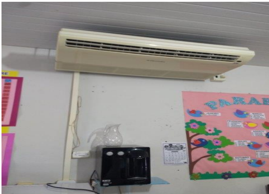
Foto 35: Sala dos professores – fiação exposta.
