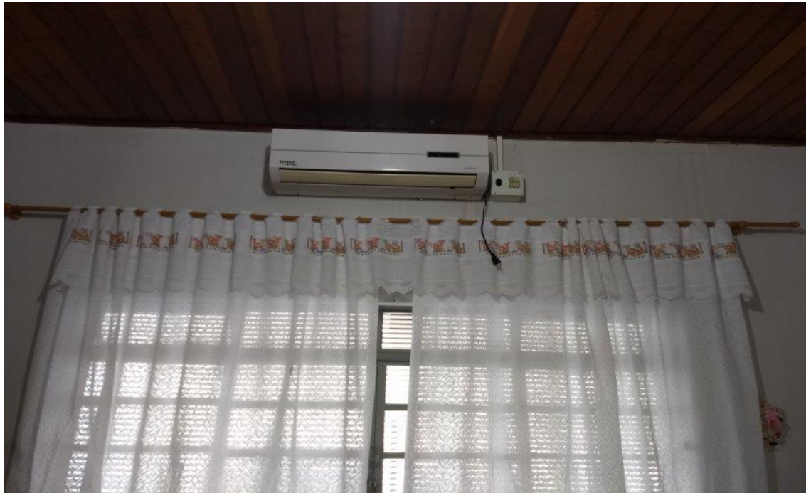
Foto 43: Ar condicionado da sala dos professores.
