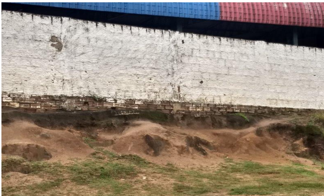
Foto 17: Muro com base exposta.
