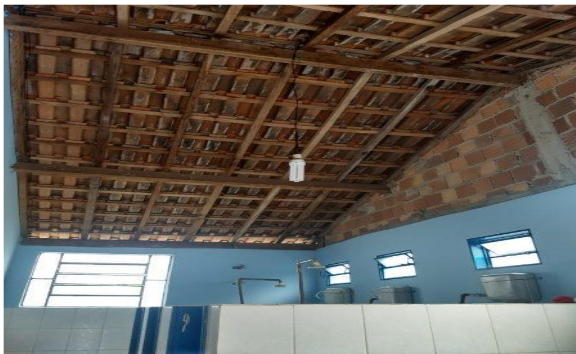
Foto 04: Sanitários sem forro.
