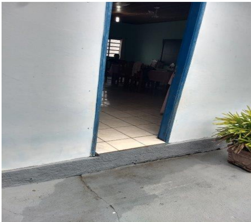
Foto 35: Entrada da sala de aula sem rampa.
