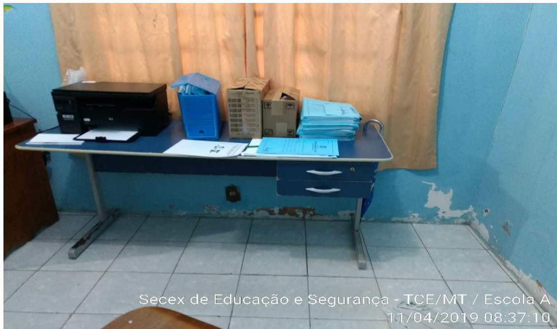
Foto 08: Sala da secretaria com infiltração.
