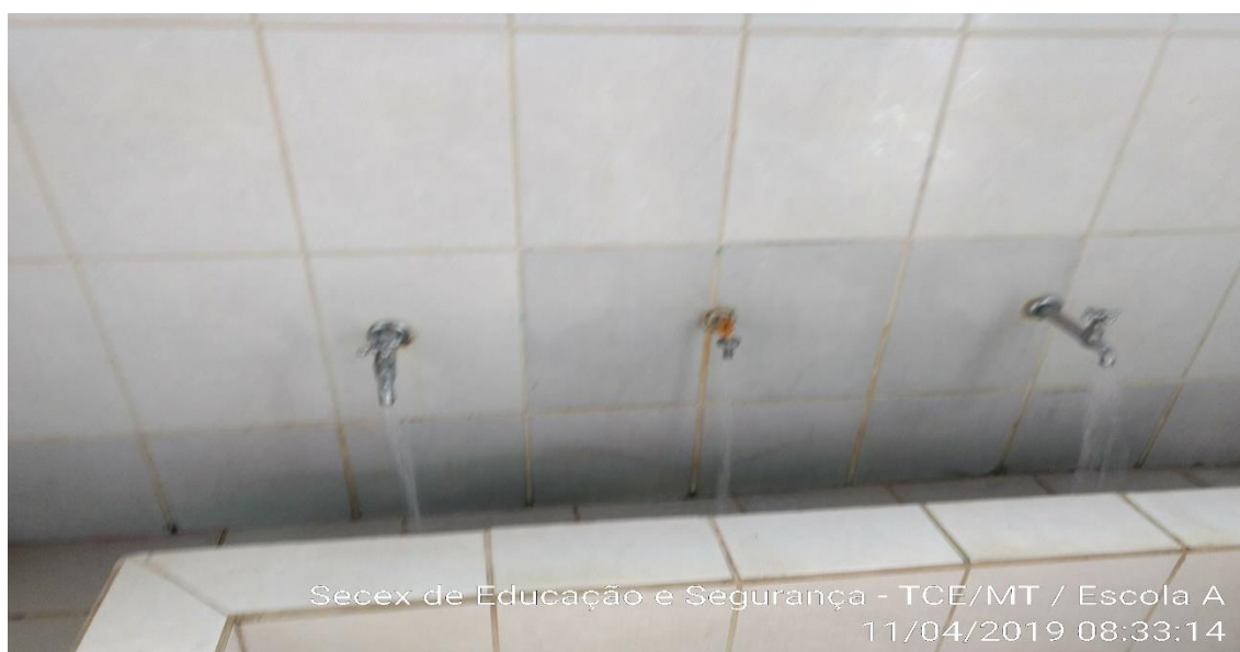
Foto 22: Torneiras da pia do sanitário, funcionando.
