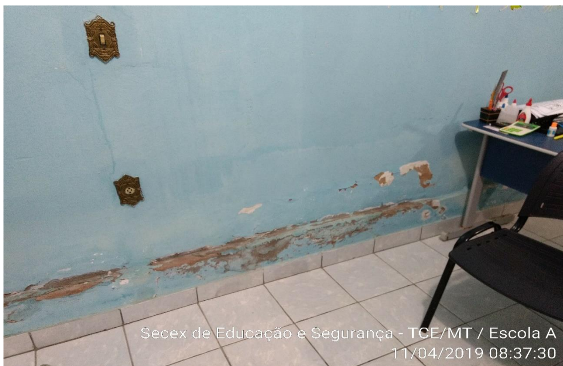
Foto 09: Paredes com infiltrações.
