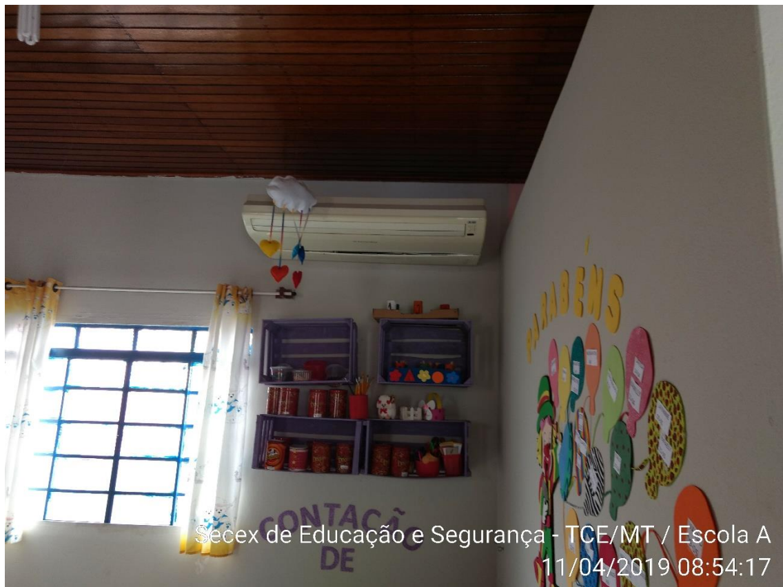
Foto 26: Ar condicionado da sala 05 sem reparos.
