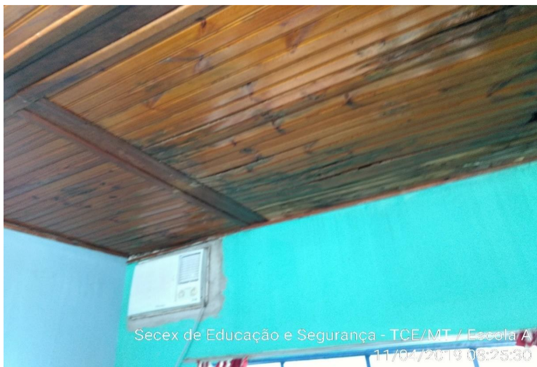
Foto 02: Forro danificado da sala de aula.
