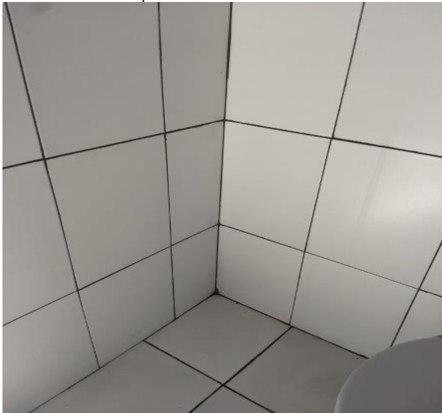
Foto 18: Paredes e pisos dos sanitários.
