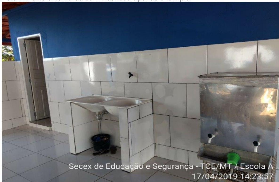
Foto 7: Parte externa da cozinha, ficou apenas o tanque.
