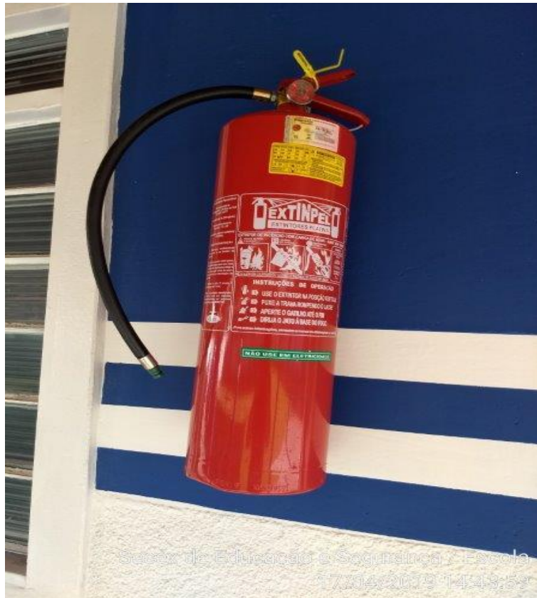
Foto 16: Extintor colocado no corredor da escola.
