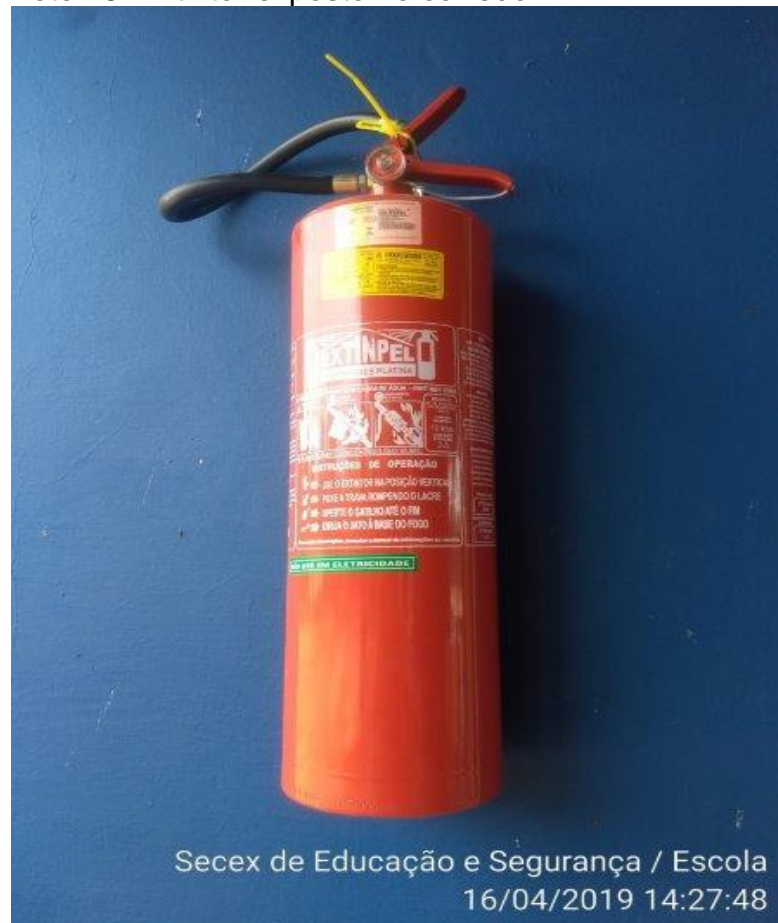
Foto 28: Extintor exposto no corredor.
