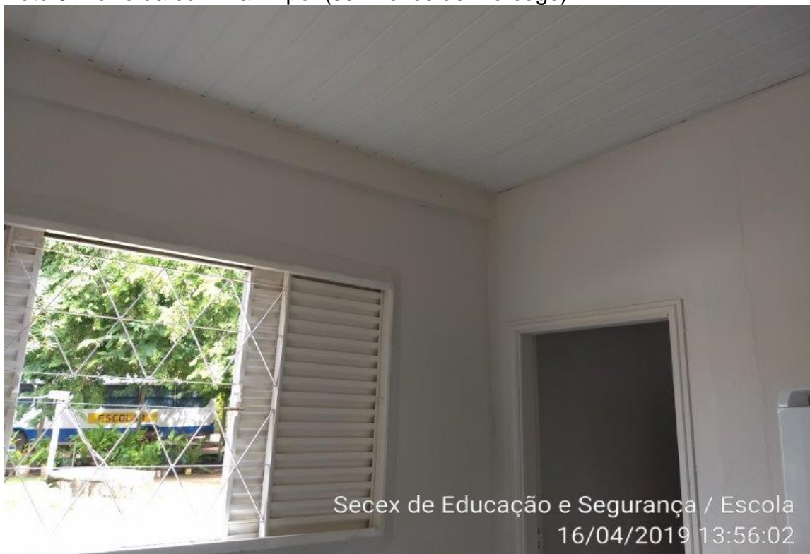
Foto 6: Forro da cozinha limpo. (sem fezes de morcego).
