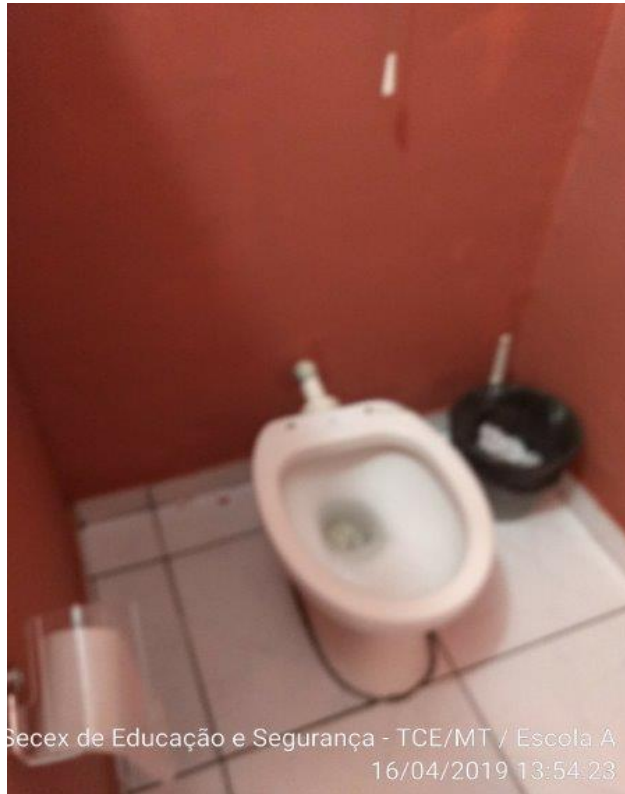
Foto 18: Vaso do banheiro feminino sem tampa.
