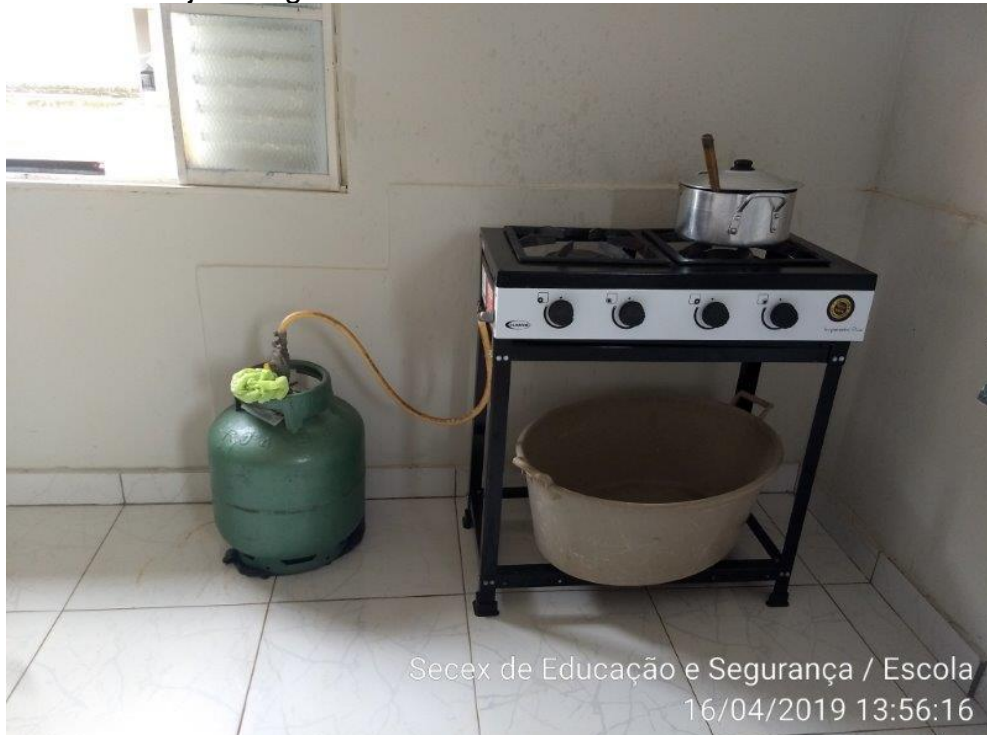
Foto 32: Botijão de gás dentro da cozinha.
