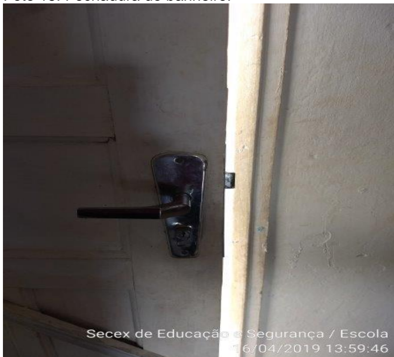
Foto 15: Fechadura do banheiro.
