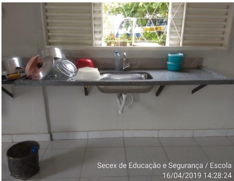
Foto 26: Pia nova com tubulação de esgoto e torneira.
