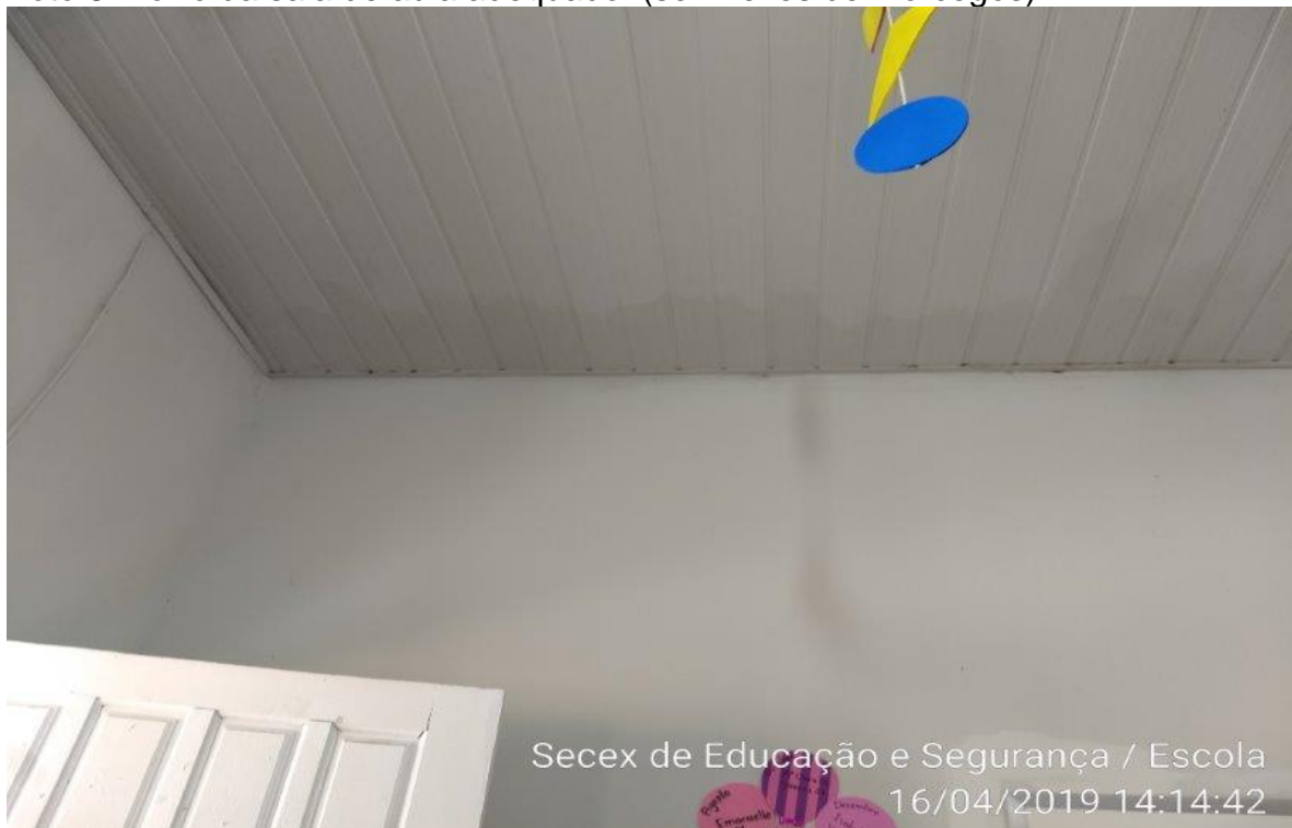
Foto 8: Forro da sala de aula adequado. (sem fezes de morcegos)
