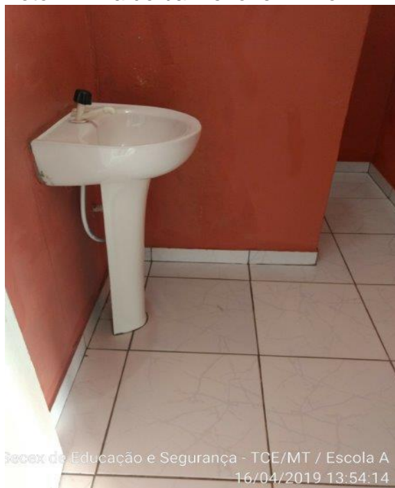
Foto 17: Pia do banheiro feminino.
