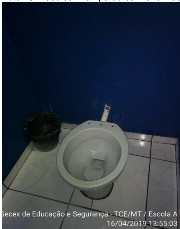
Foto 20: Vaso sem tampa do banheiro masculino.
