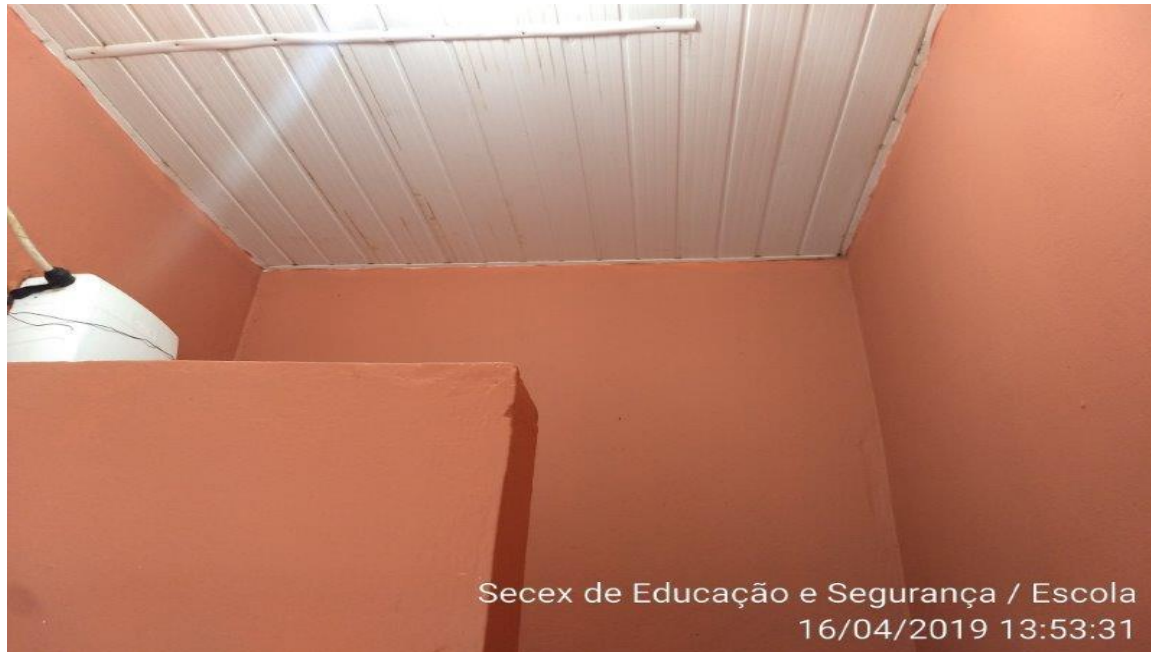
Foto 3: Forro do Sanitário feminino.
