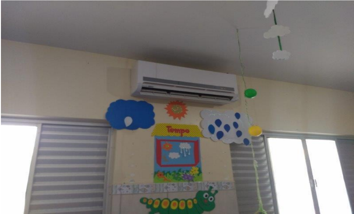
Foto 21: Sala de aula com ar condicionado.
