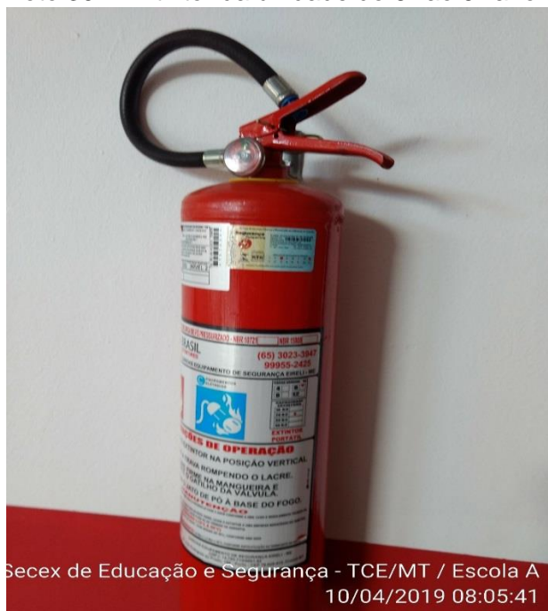
Foto 30 – Extintor da unidade do 6° ao 9° ano.
