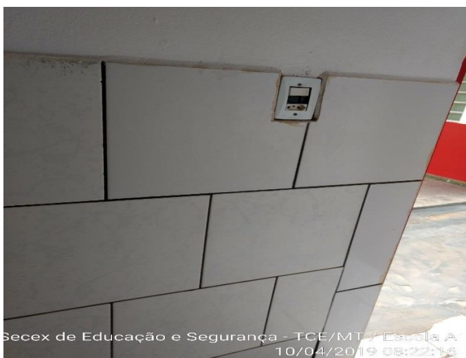
Foto 11: Fiação consertada – sanitário masculino.
