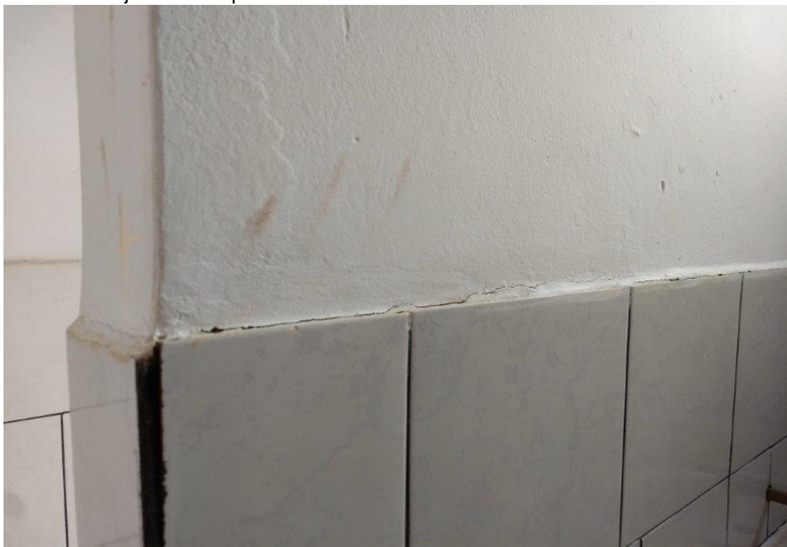
Foto 3: Azulejo trincado/quebrado – sanitário masculino.
