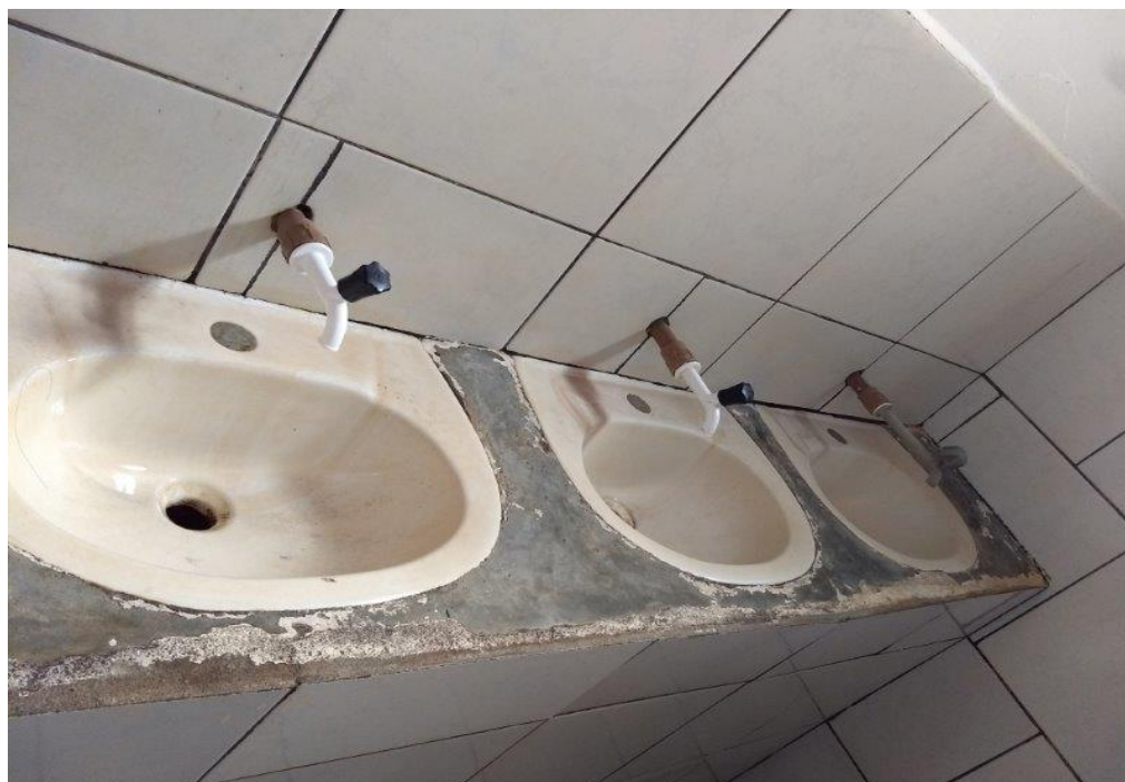
Foto 16: Torneiras trocadas – sanitário feminino.
