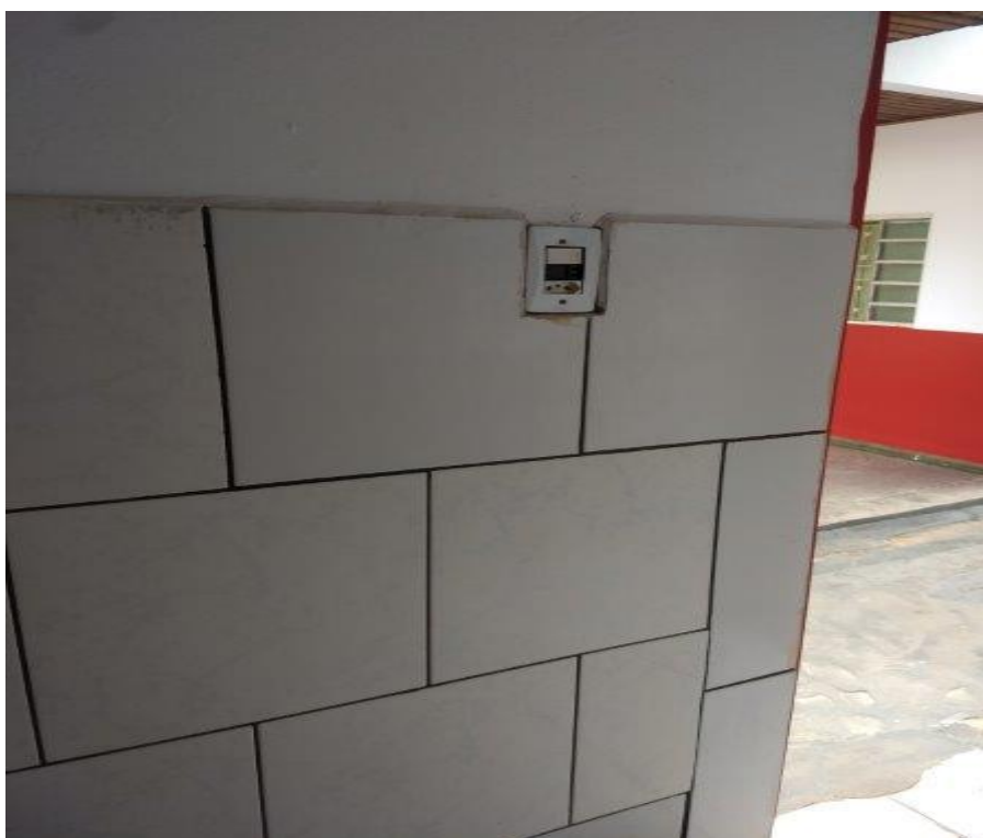
Foto 5: Parede do interruptor consertada – sanitário masculino.
