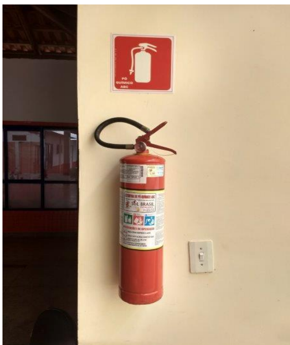
Foto 32: Extintor da unidade do 1º ao 5º ano.
