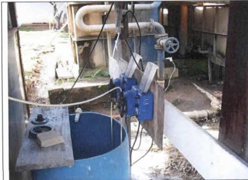
Bomba dosadora e ponto de aplicação de sulfato de alumínio na adutora de água bruta
