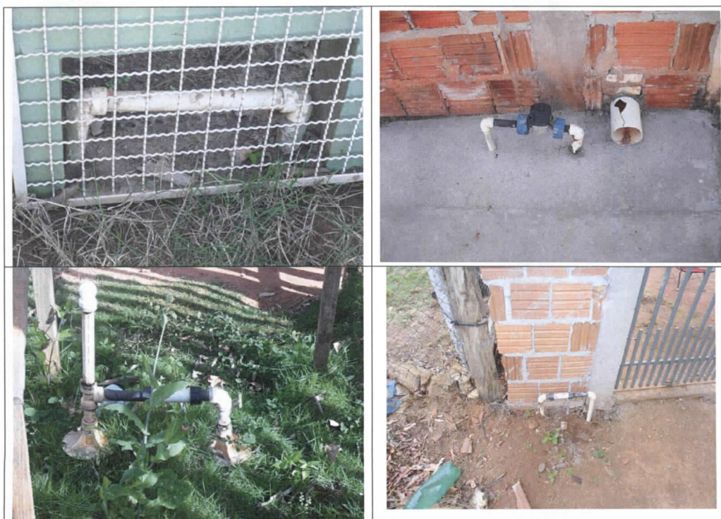
Ligações domiciliares com e sem hidrômetro.
