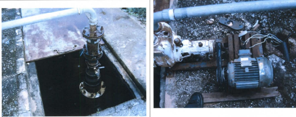
Estação Elevatória de Esgoto
