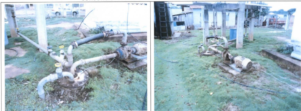
Fotos da Estação Elevatória de Água Tratada existente
