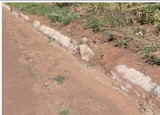
Foto 7: Dispositivo de drenagem danificado.
