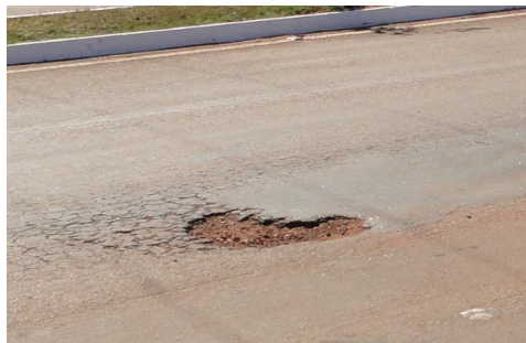
Foto 4: Remendo inadequado e panela (buraco).
