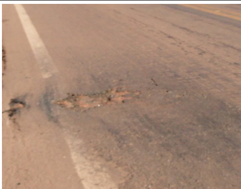
Foto 6: Remendo inadequado e panela (buraco) no pavimento.
