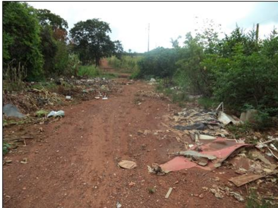
Figura 1 – Acesso à Ponte do córrego Queixada, na avenida Goiânia no limite do bairro Jardim Dinalva Muniz. Neste trecho a via não tem pavimentação e observa-se grande quantidade de lixo e matagal nas suas laterais.
