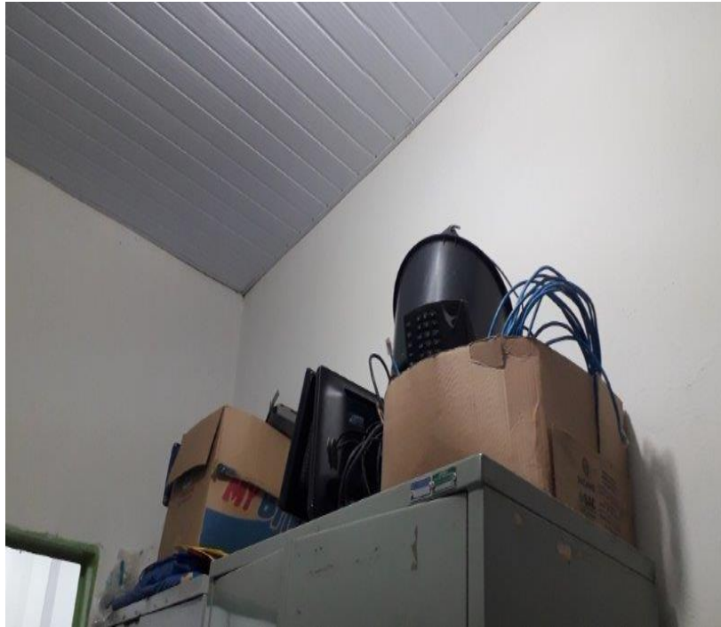
Foto 11- Infiltração e mofo do almoxarifado foram arrumadas
