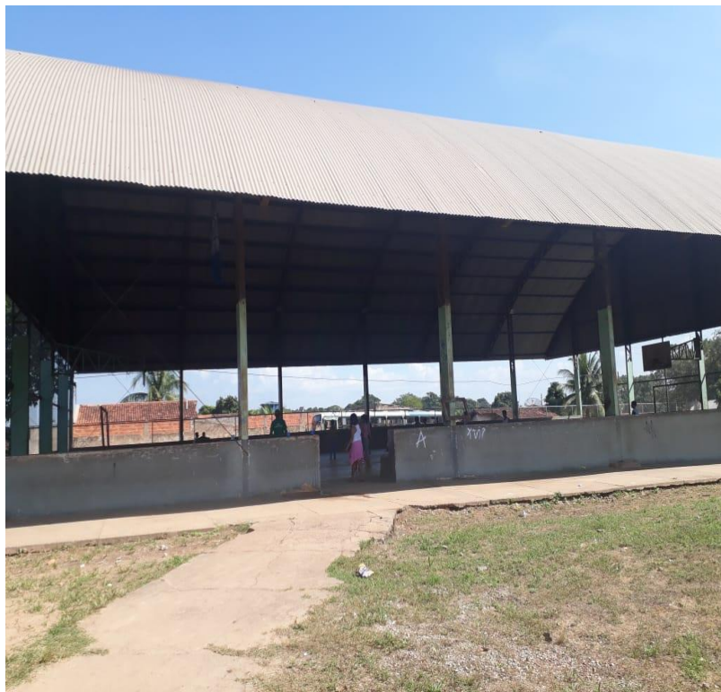
Foto 17 – Piso danificado acesso a quadra de esportes
