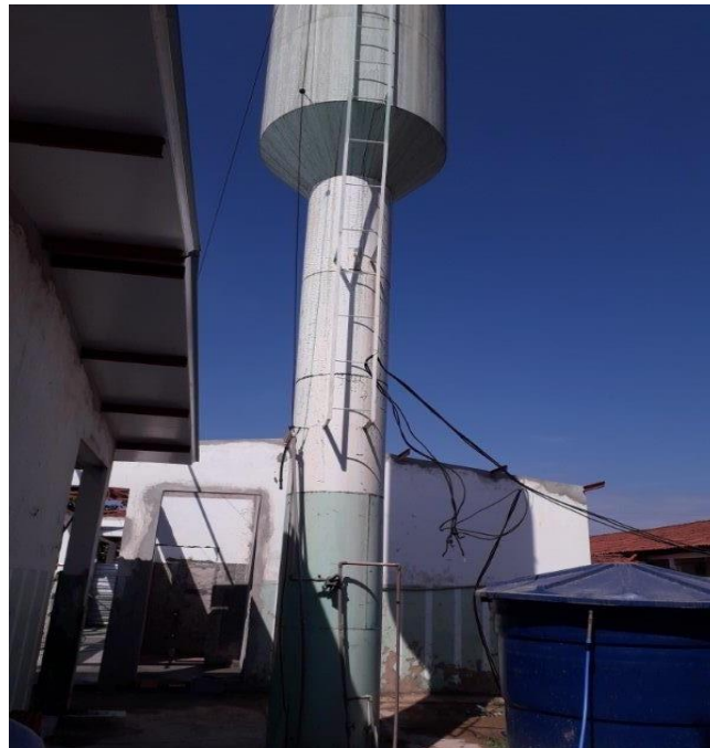
Foto 33 – Caixa d'água obsoleta, danificada e mofada
