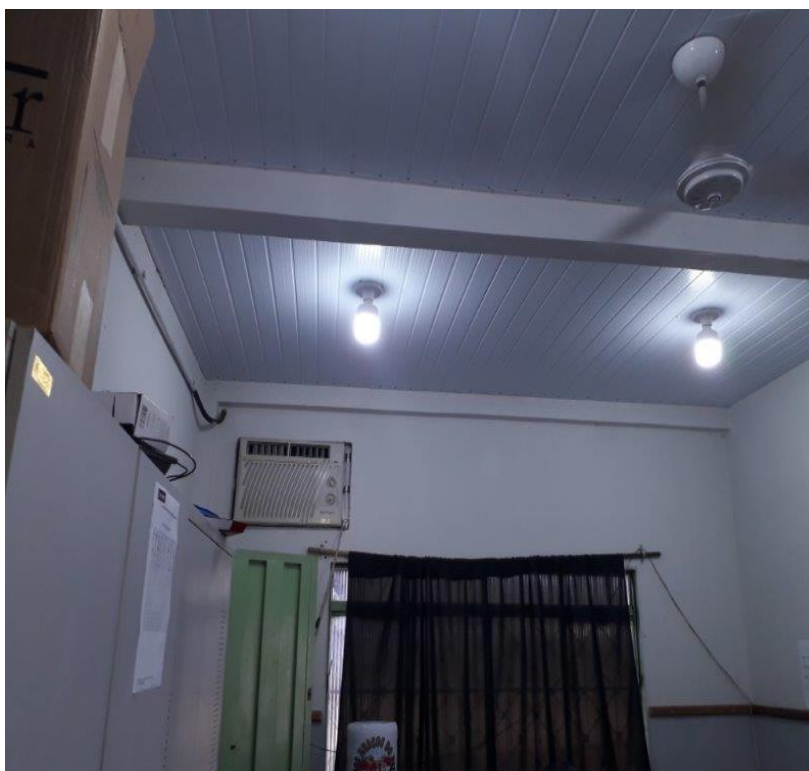
Foto 10 – Infiltração e mofo da secretaria foram arrumadas
