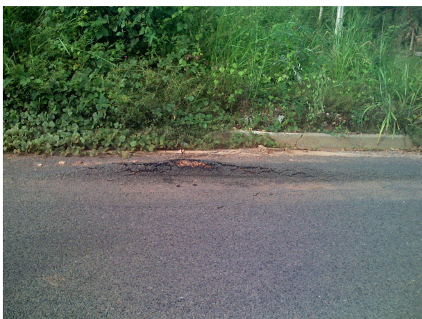
Foto 7: Asfalto com defeito
