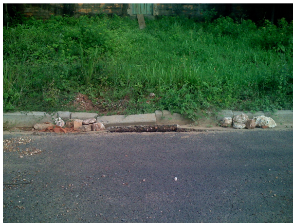
Foto 4: Defeito no meio fio
