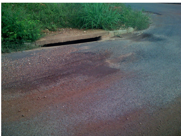
Foto 5: Asfalto com defeito na pista
