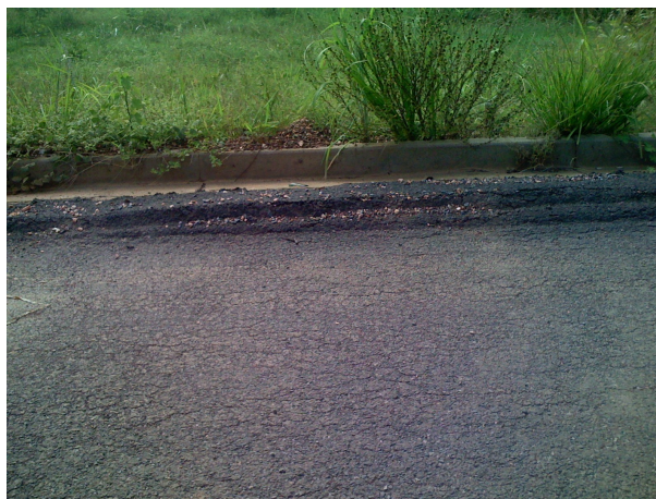
Foto 10: Defeito na manta asfáltica
