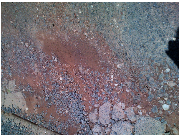
Foto 9: Defeito no asfalto
