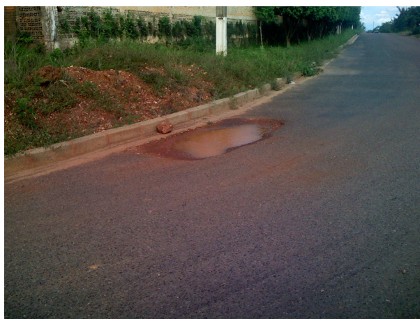
Foto 6: Buraco na pista
