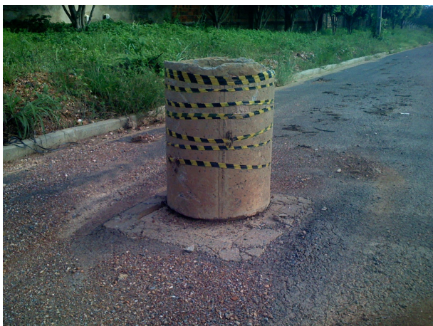
Foto 3: Caixa de passagem obstruída
